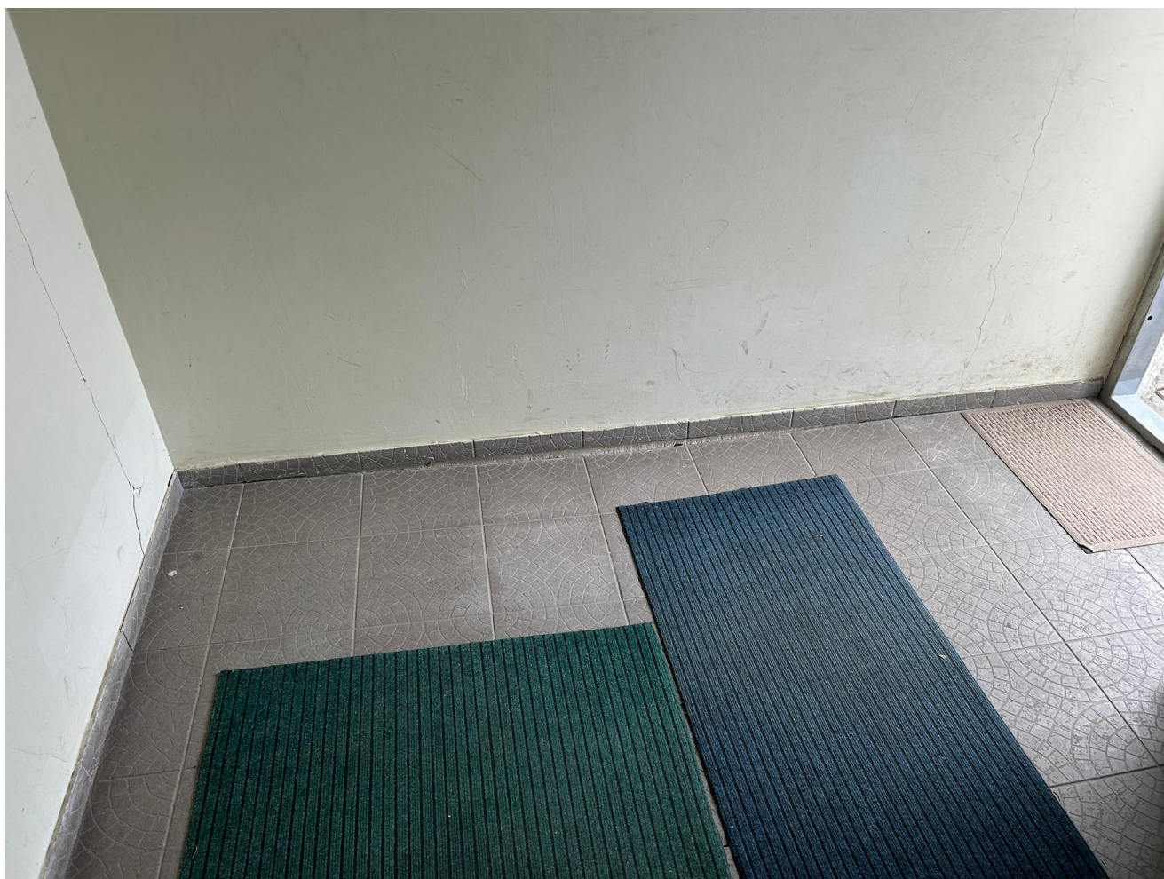
Pav. 14. Grindų dangos deformacijos.
