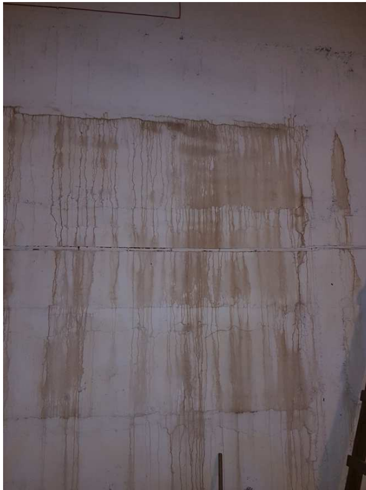
10 pav. Pažeista šiaurinės atraminės sienos besiribojančius su gruntu hidroizoliacija
