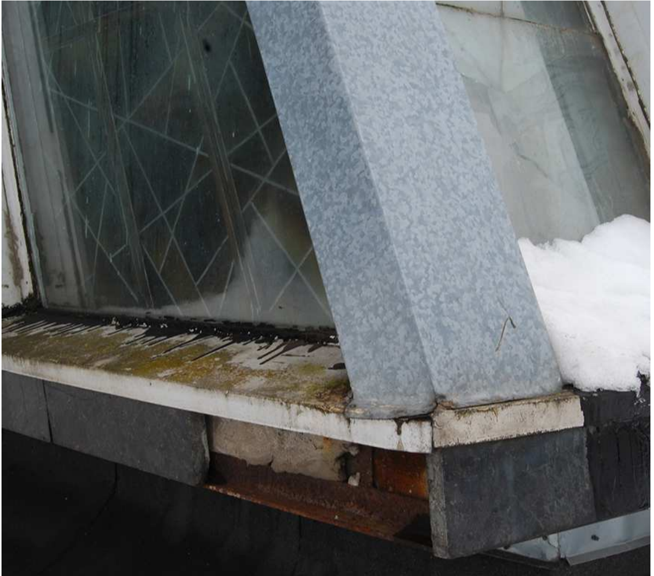
16 pav. Pažeista stiklinės sienutės apdaila
