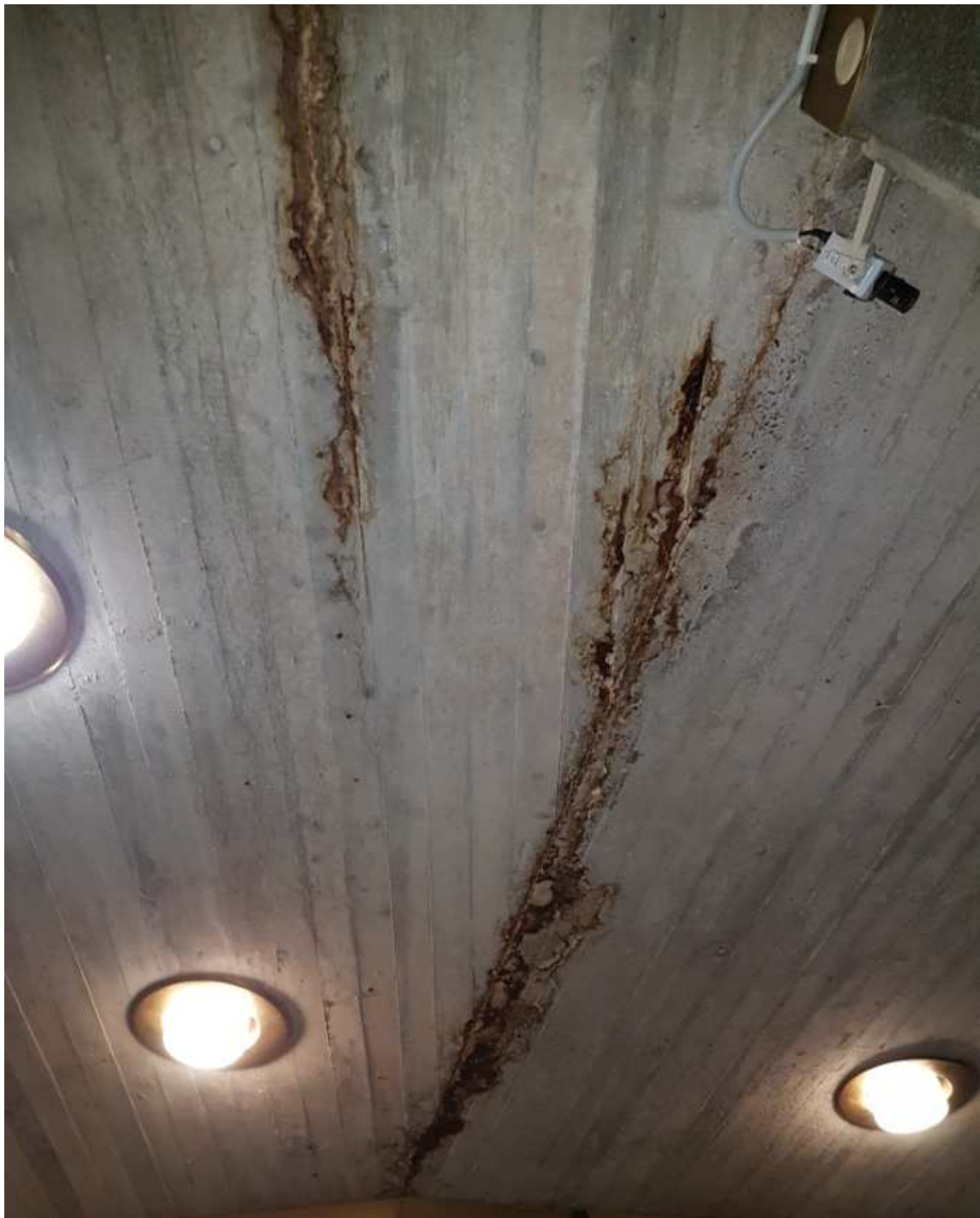
20 pav. Monolitinė gelžbetoninė lubų konstrukcija pažeista drėgmės poveikio
