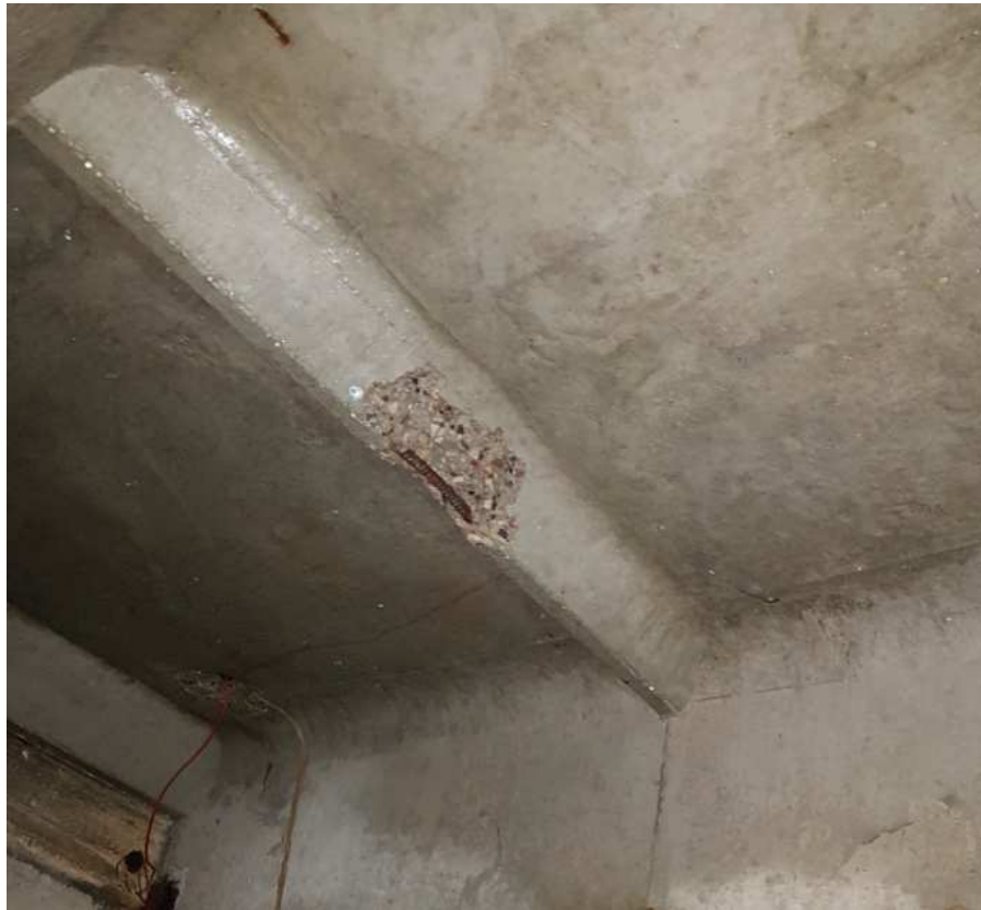
18 pav. Pažeistas apsauginis sluoksnis
