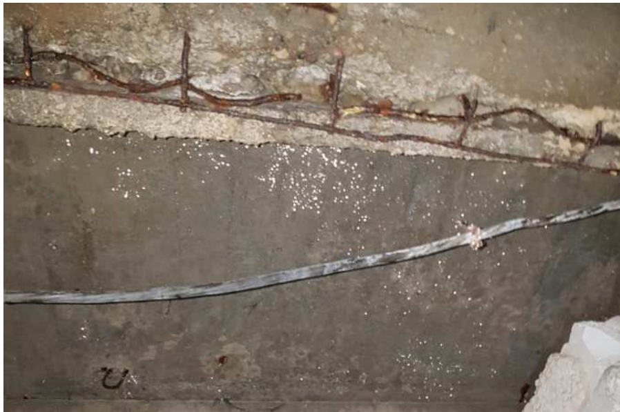
19 pav. Plokštė pažeista drėgmės poveikio
