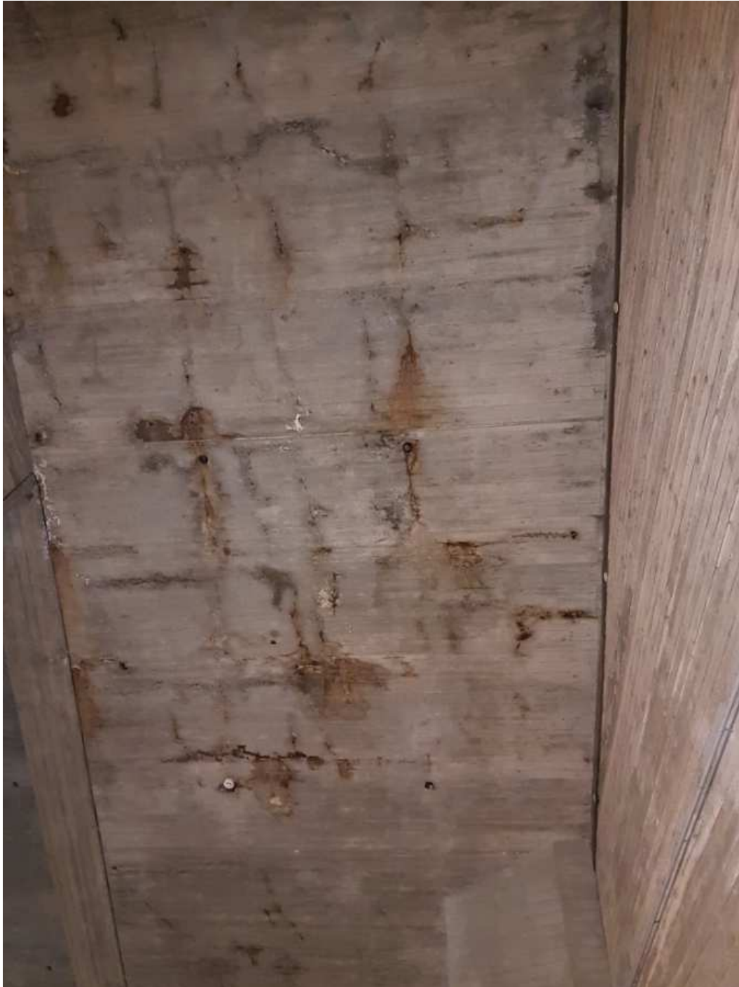
21 pav. Monolitinė gelžbetoninė lubų konstrukcija pažeista drėgmės poveikio
