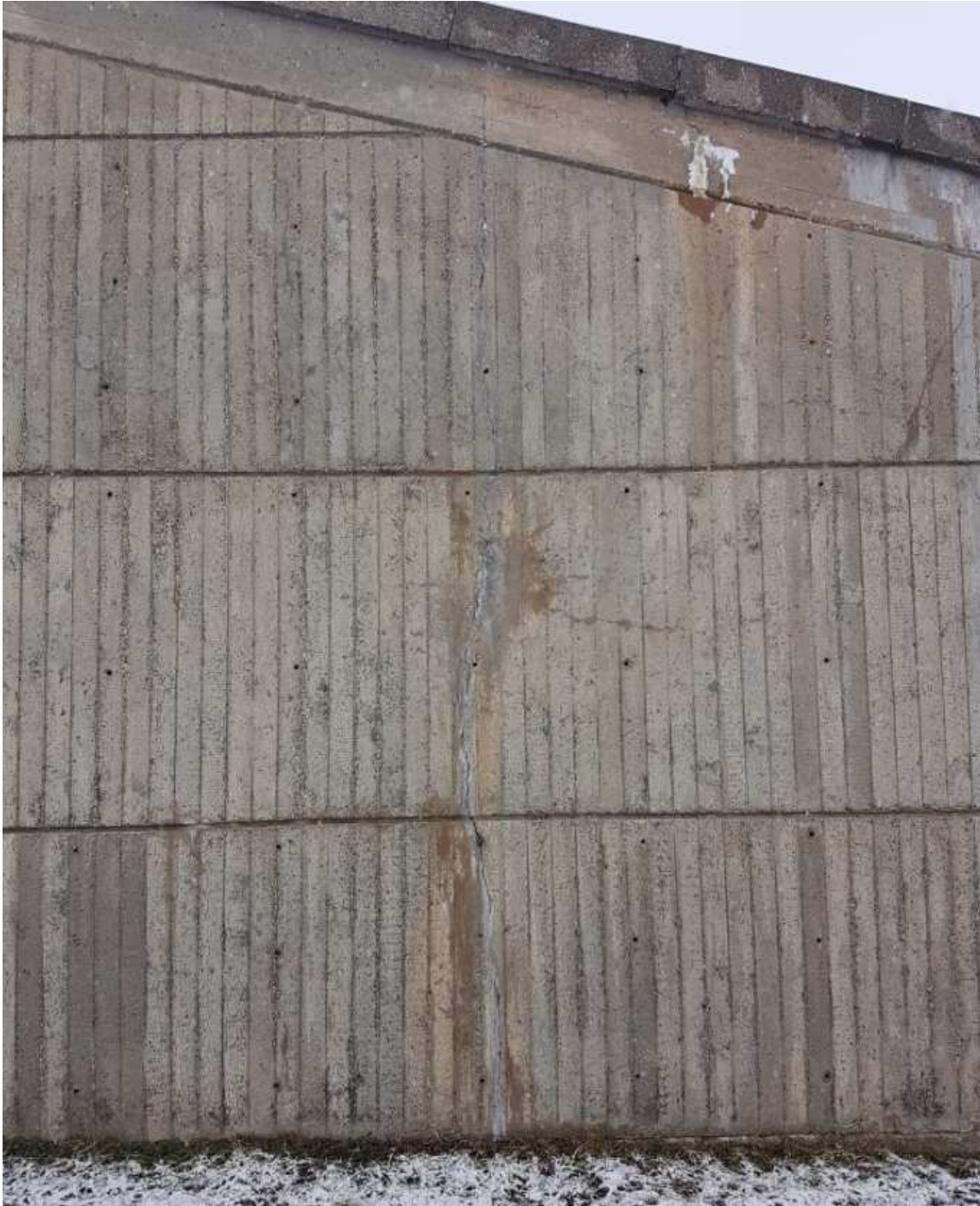
14 pav. Įtrūkimai išorinės sienos monolitiniame gelžbetoniniame apdailiniame sluoksnyje
