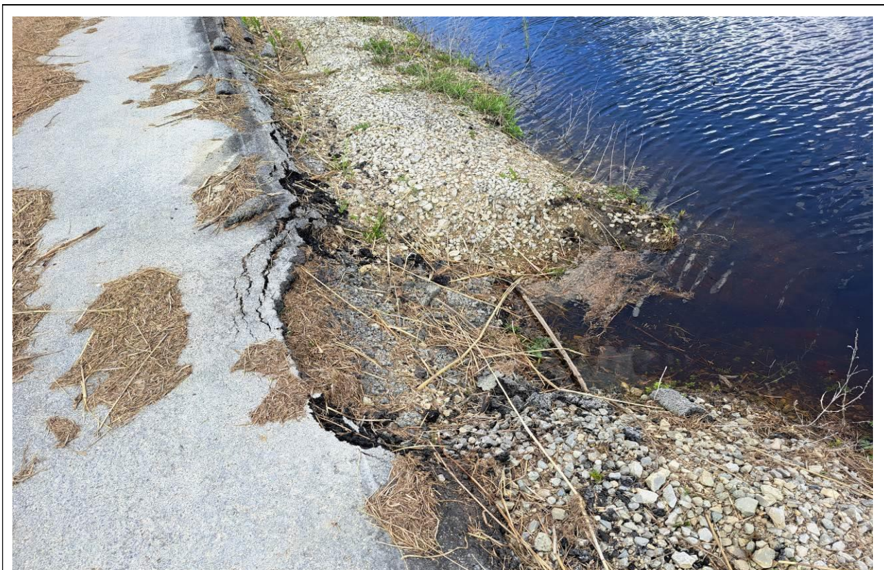
10 pav. Kelio Nr. 4216 antras ruožas nuo 4,860 iki 5,30 km. Kairėje kelio pusėje paplauta kelio sankasa, pažeistas kelio dangos kraštas
