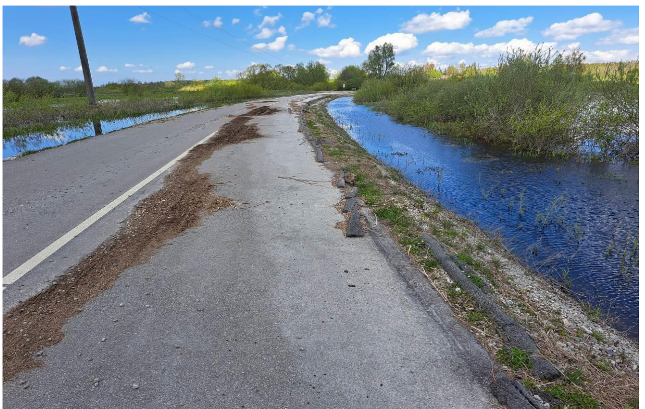
14 pav. Kelio Nr. 4216 antras ruožas nuo 4,860 iki 5,30 km. Kairėje kelio pusėje paplauta kelio sankasa, pažeistas kelkraščio asfaltbetonio bortas. Ant kelio dangos matyti žemių ir žvyro mišinio sankaupos
