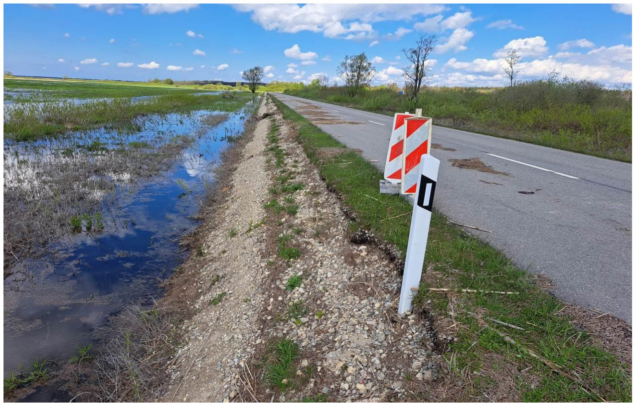
29 pav. Kelio Nr. 4216 trečias ruožas nuo 5,30 iki 5,46 km. Kairėje kelio pusėje minimaliai paplautas kelio sankasos šlaito sutvirtinimas, kelio dangoje pažeidimų nėra
