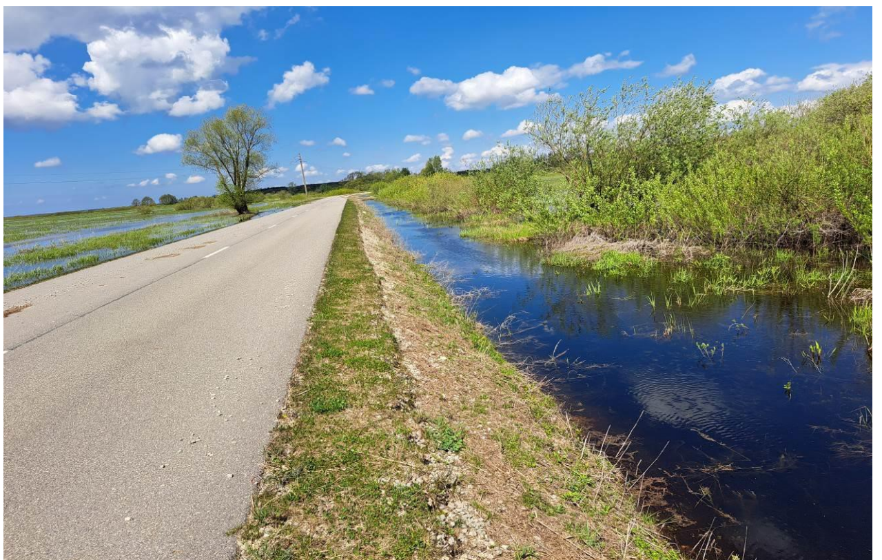
26 pav. Kelio Nr. 4216 trečias ruožas nuo 5,30 iki 5,46 km. Kairėje kelio pusėje minimaliai paplautas kelio sankasos šlaito sutvirtinimas, kelio dangos pažeidimų nėra
