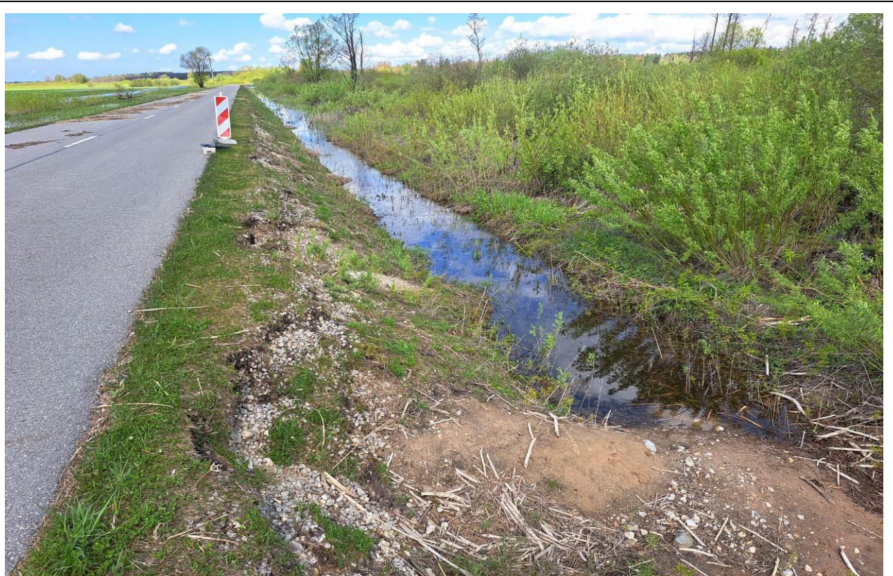
30 pav. Kelio Nr. 4216 trečias ruožas nuo 5,30 iki 5,46 km. Kairėje kelio pusėje minimaliai paplautas kelio sankasos šlaito sutvirtinimas, kelio dangoje pažeidimų nėra
