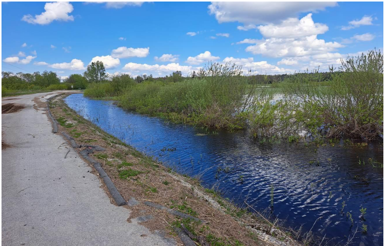
13 pav. Kelio Nr. 4216 antras ruožas nuo 4,860 iki 5,30 km. Kairėje kelio pusėje paplauta kelio sankasa, pažeistas kelkraščio asfaltbetonio bortas
