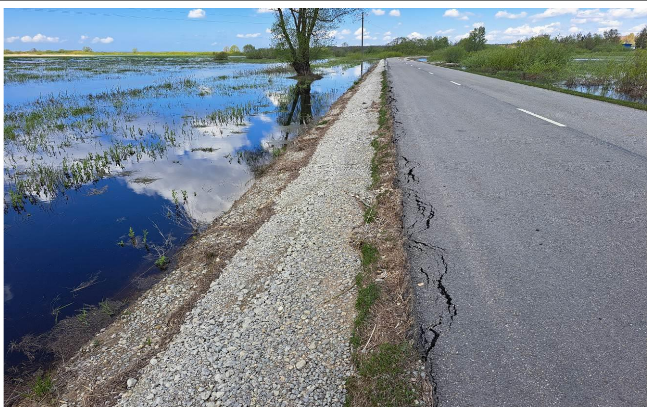
24 pav. Kelio Nr. 4216 antras ruožas nuo 4,860 iki 5,30 km. Dešinėje kelio pusėje, nuo piketo Pk 50+97 iki piketo Pk 50+47 paplautas kelio sankasos šlaitas, palei kraštą atitrūkusi asfaltbetonio danga, dangoje matyti išilginiai plyšiai
