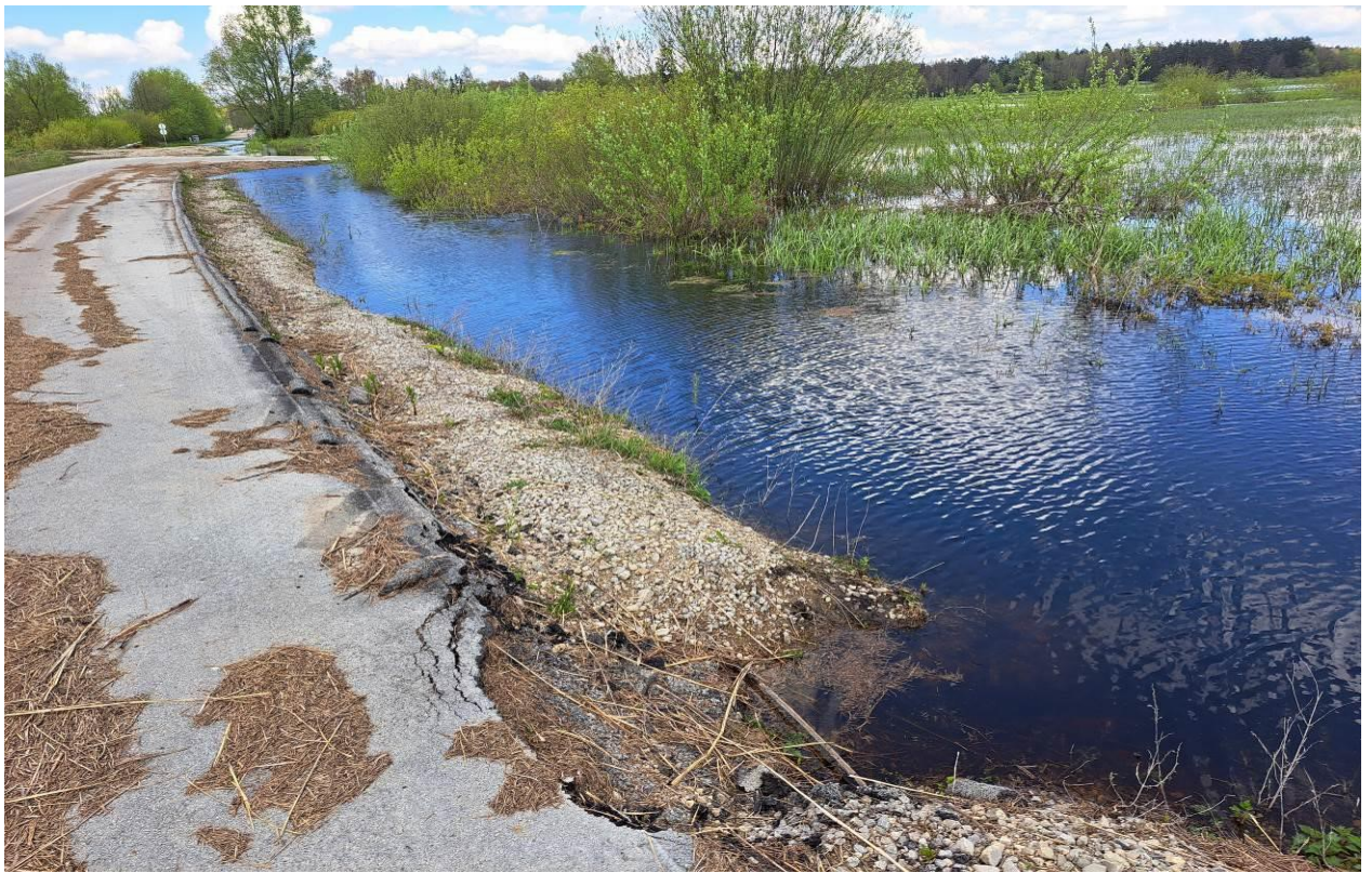
11 pav. Kelio Nr. 4216 antras ruožas nuo 4,860 iki 5,30 km. Kairėje kelio pusėje paplauta kelio sankasa, lokaliaje vietoje išplauta kelio sankasa, nulūžęs kelio dangos kraštas
