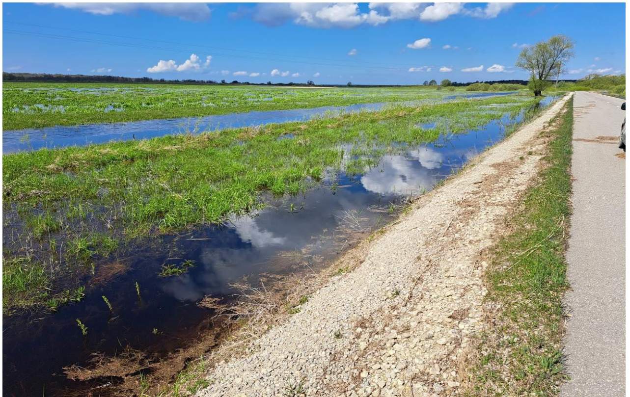
27 pav. Kelio Nr. 4216 trečias ruožas nuo 5,30 iki 5,46 km. Dešinėje kelio pusėje minimaliai paplautas kelio sankasos šlaito sutvirtinimas, kelio dangoje pažeidimų nėra
