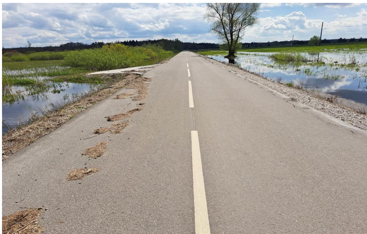
17 pav. Kelio Nr. 4216 antras ruožas nuo 4,860 iki 5,30 km, ties piketu Pk 49+58. Kairėje ir dešinėje kelio pusėse paplauta kelio sankasa, dešinėje kelio pusėje palei kraštą atitrūkusi ir atlūžusi kelio asfaltbetonio danga
