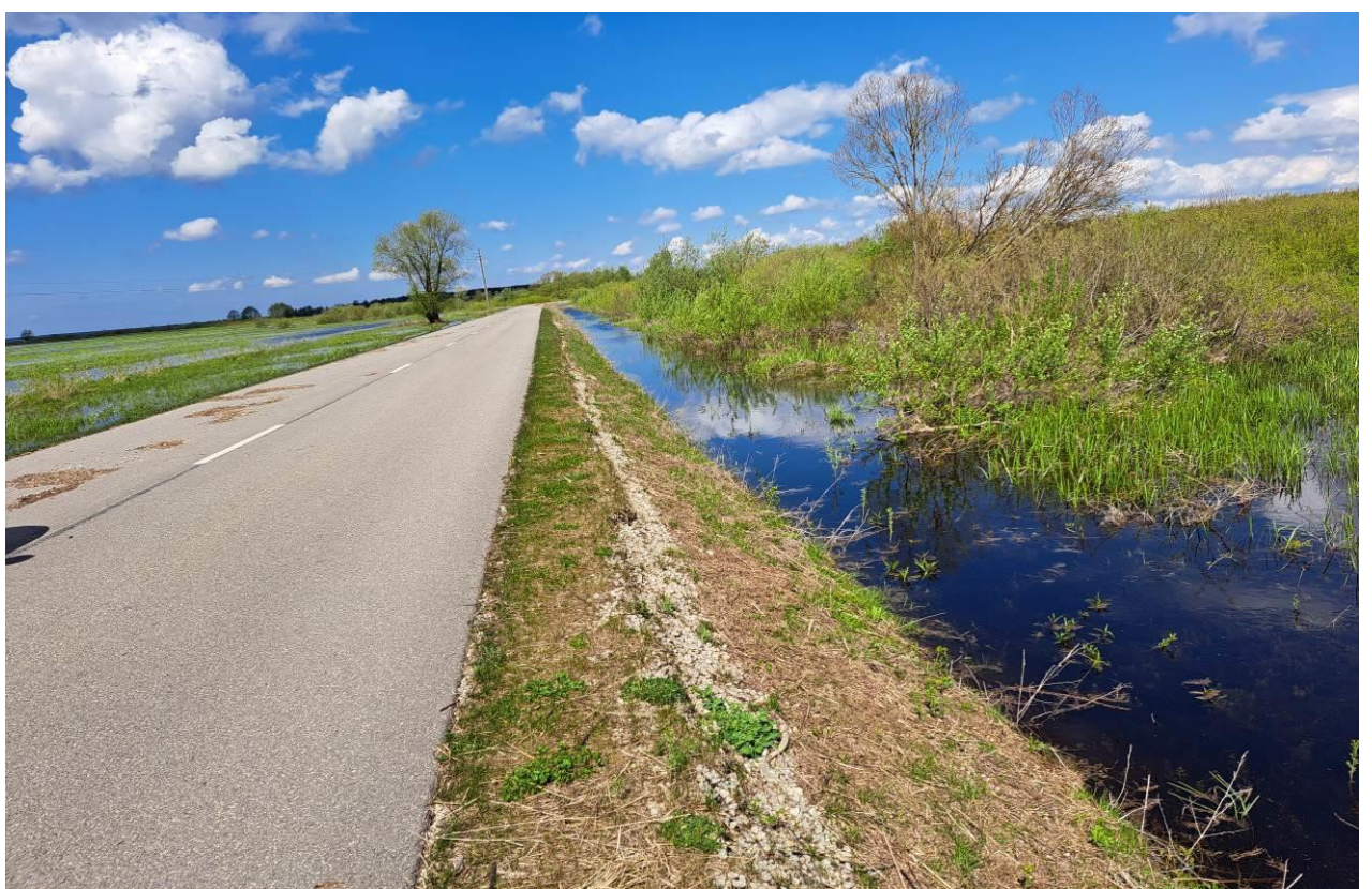
28 pav. Kelio Nr. 4216 trečias ruožas nuo 5,30 iki 5,46 km. Kairėje kelio pusėje minimaliai paplautas kelio sankasos šlaito sutvirtinimas, kelio dangoje pažeidimų nėra
