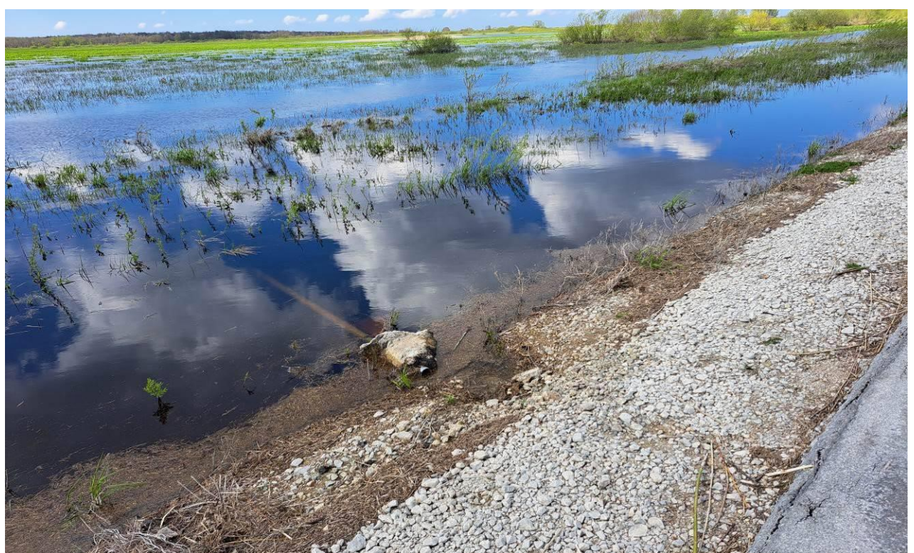
20 pav. Kelio Nr. 4216 antras ruožas nuo 4,860 iki 5,30 km. Dešinėje kelio pusėje, ties piketu Pk 49+75 nuvirtusi atrama su kelio ženklu Nr. 336. Taip pat, dešinėje kelio pusėje paplautas kelio sankasos šlaitas
