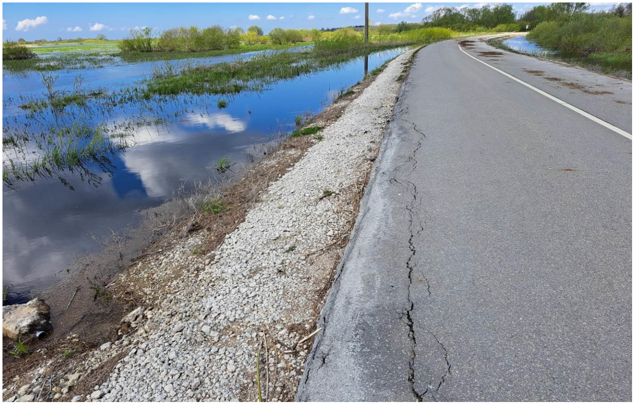
21 pav. Kelio Nr. 4216 antras ruožas nuo 4,860 iki 5,30 km. Dešinėje kelio pusėje, ties piketu Pk 49+75 paplautas kelio sankasos šlaitas, palei kraštą atitrūkusi asfaltbetonio danga, joje matyti išilginis plyšys
