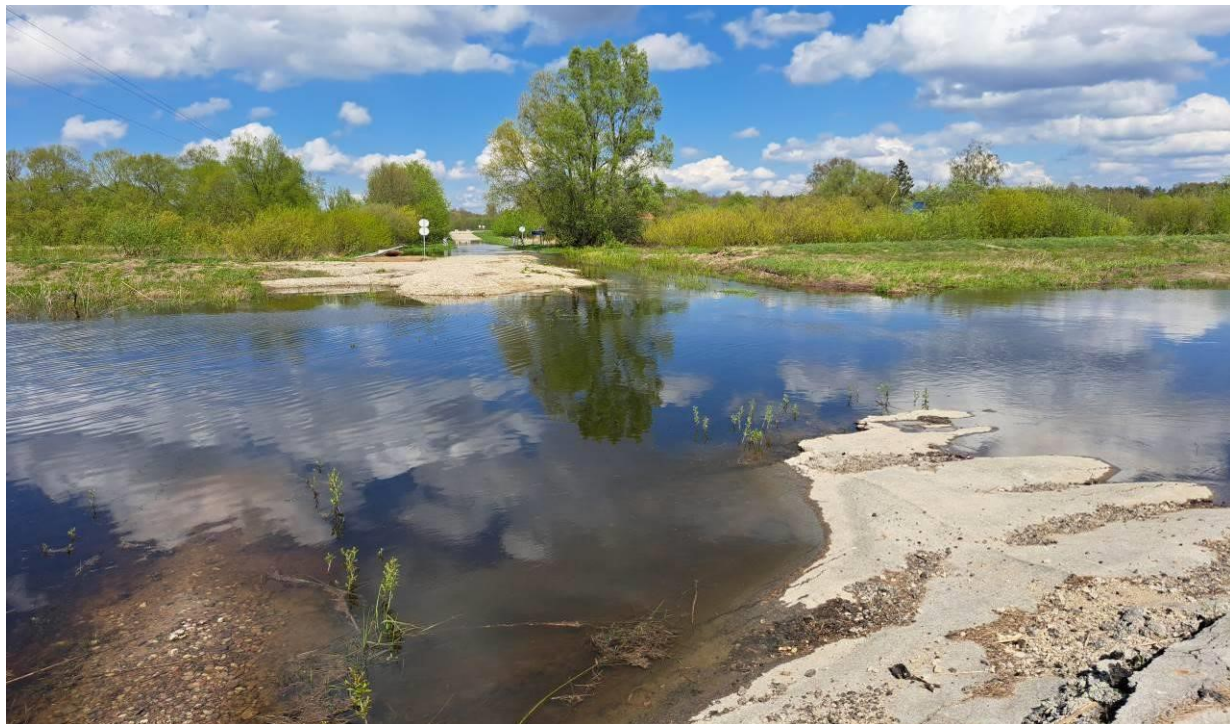
5 pav. Kelias Nr. 4216 pirmas ruožas nuo 4,767 iki 4,860 km. Suardyta ir nuplauta kelio dangos konstrukcija, nuplauta kelio sankasa. Nuplautoje sankasos dalyje, ties piketais Pk 48+12 ir Pk+48+15 buvo įrengtos 2 g/b 1000 mm skersmens pralaidos. Apžiūrint statinį dėl aukšto vandens lygio nebuvo galimybės identifikuoti pralaidų būklės
