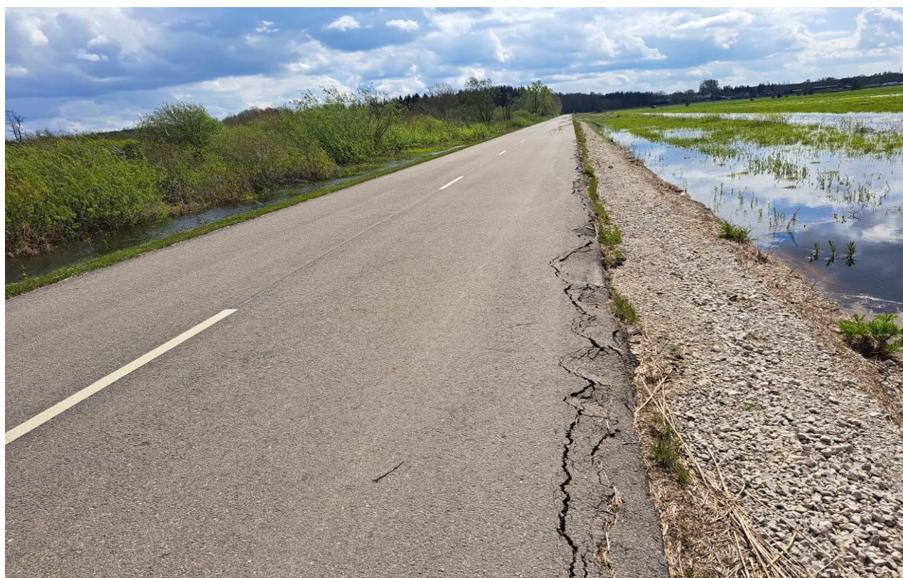
23 pav. Kelio Nr. 4216 antras ruožas nuo 4,860 iki 5,30 km. Dešinėje kelio pusėje, ties piketo Pk 50+47 paplautas kelio sankasos šlaitas, palei kraštą atitrūkusi asfaltbetonio danga, dangoje matyti išilginiai plyšiai
