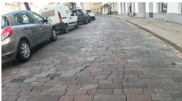
a) dangos nusėdimas su trinkelų dangos trūkiais
