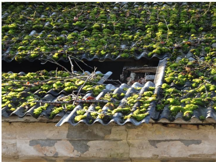
3. Įlūžusi stogo konstrukcija.
