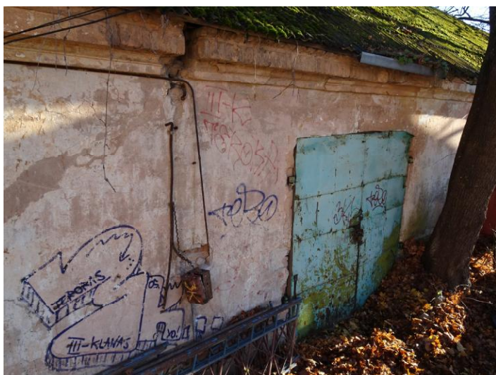
23. Suirusi buvusi elektros instaliacija, susidėvėję vartai.
