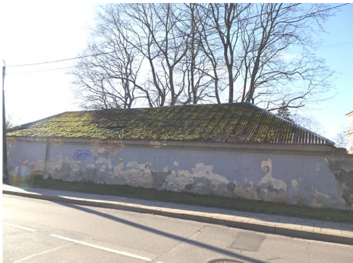
1. Bendras pastato vaizdas iš gatvės pusės. Sienomis kyla kapiliarinė drėgmė.
