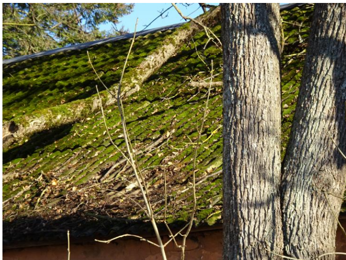
13. Susidėvėjusi stogo, samanomis pasidengusi stogo danga. Prie pastato esančių senų medžių šakos krenta ant pastato stogo.
