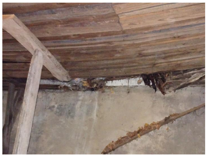
6. Įlūžusi perdanga virš pirmo aukšto.
