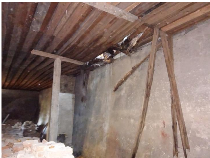
11. Dalis stogo perdangos konstrukcijų suirusios, yra tolimesnės perdangos konstrukcijų griūties pavojus.
