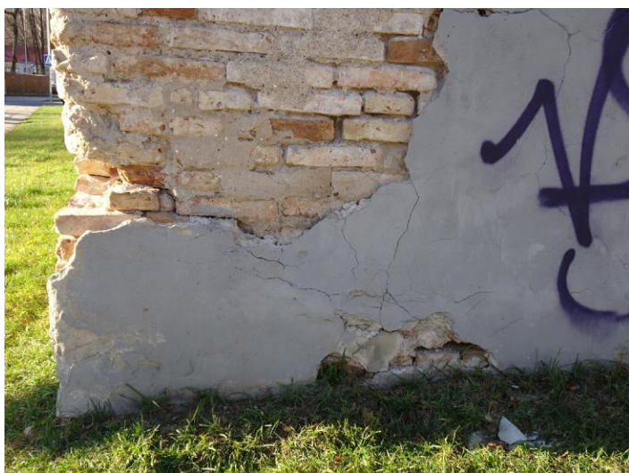
17. Supleišėjęs išorinių sienų mūras ties pastato kampu iš gatvės pusės.
