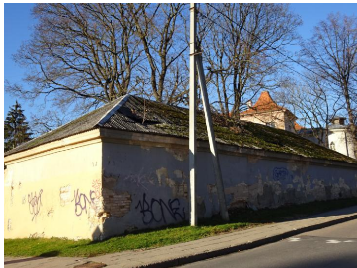
4. Bendras pastato vaizdas, stogas deformuotas, šiferis susidėvėjęs.
