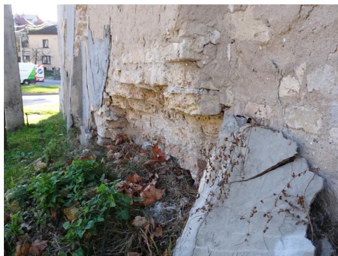
18. Išorinės sienos mūro erozija ties pastato pamatais.
