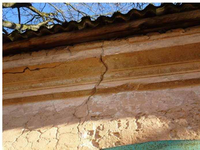
16. Plyšiai karnizo mūre, susidėvėjęs pastato išorinių sienų tinkas.
