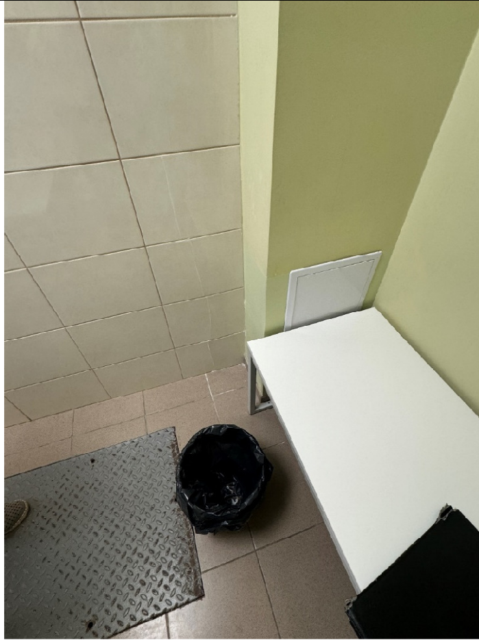
Pusrūsio patalpose fiksuojama drėgmės pažeista sienų apatinė dalis (Patalpa P-61)
