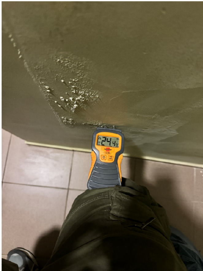
Pamatuota drėgmė pusrūsio patalpose su apdaila (Patalpa P-52)
