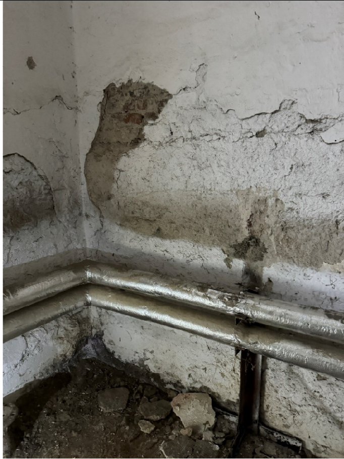
Pusrūsio patalpose fiksuojama drėgmės pažeista sienų apatinė dalis (Patalpa P-48)
