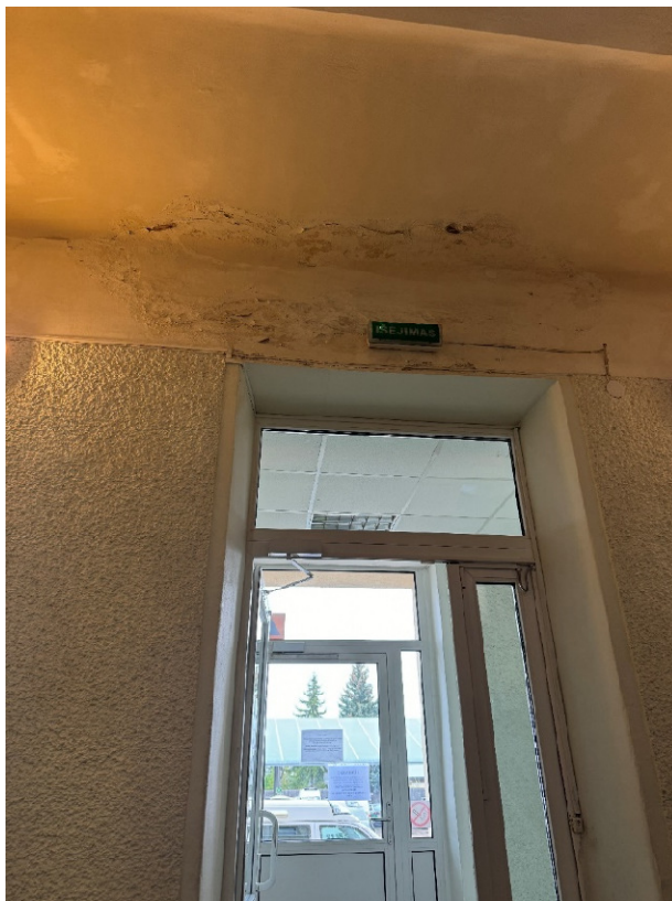
Pirmo aukšto patalpose fiksuojama drėgmės pažeista sienų viršutinė dalis (Patalpa 1-1)
