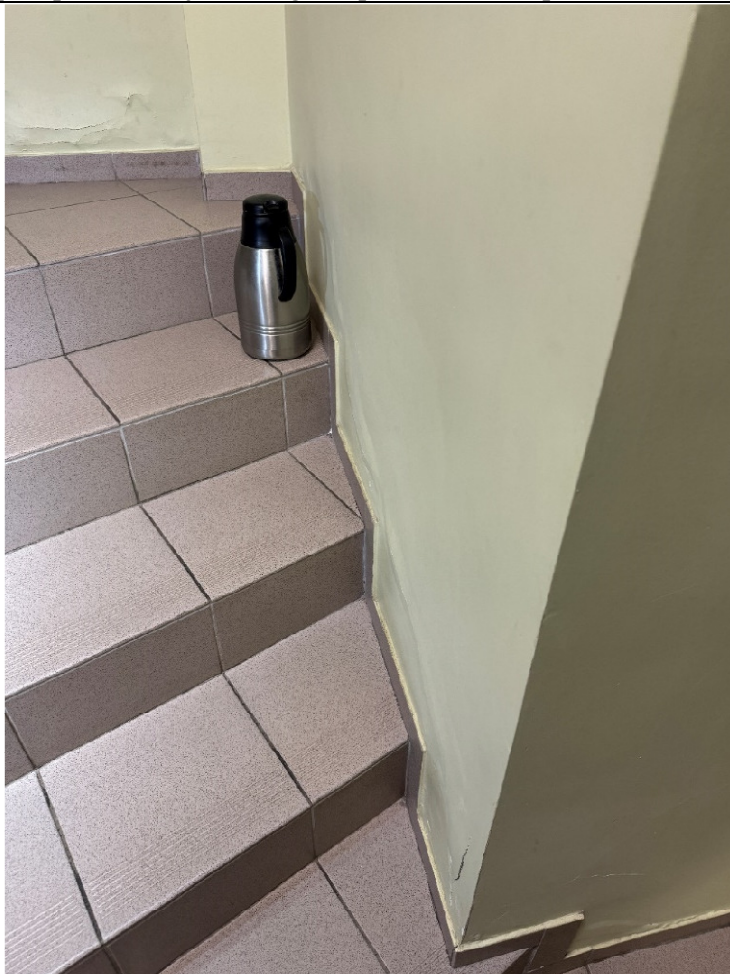
Pusrūsio patalpose fiksuojama drėgmės pažeista sienų apatinė dalis (Patalpa P-52)
