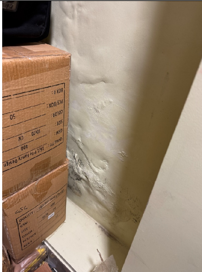
Pusrūsio patalpose fiksuojama drėgmės pažeista sienų apatinė dalis (Patalpa P-59)
