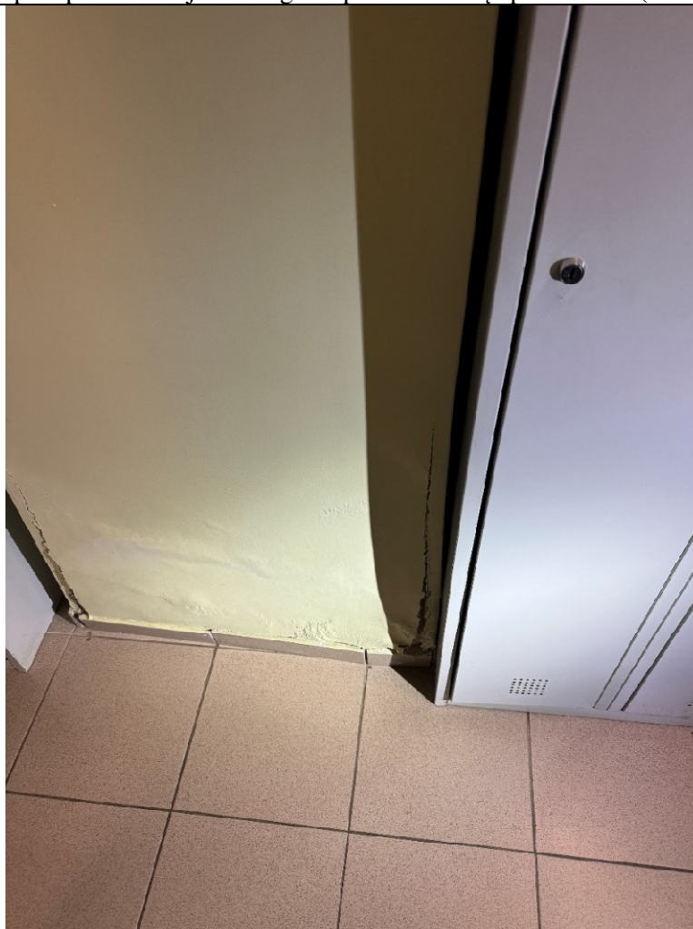
Pusrūsio patalpose fiksuojama drėgmės pažeista sienų apatinė dalis (Patalpa P-60)
