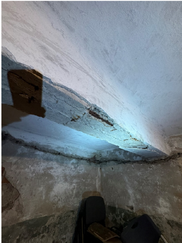
Pusrūsio patalpose fiksuojama pažeista korozijos denginio sijos darbinė armatūra (Patalpa P-38)
