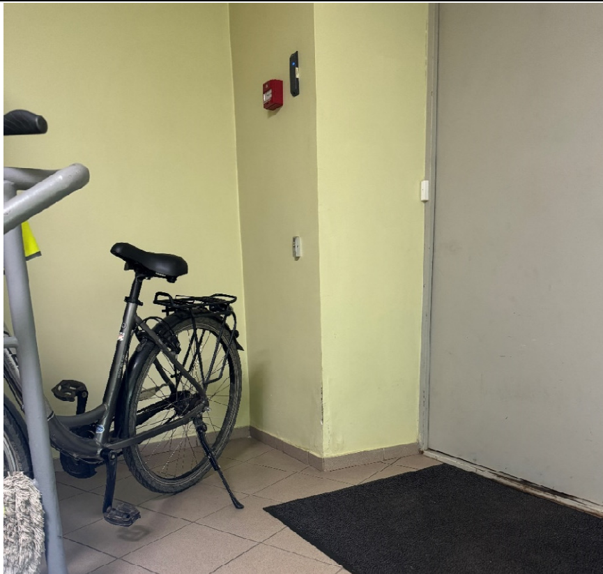
Pusrūsio patalpose fiksuojama drėgmės pažeista sienų apatinė dalis (Patalpa P-52)
