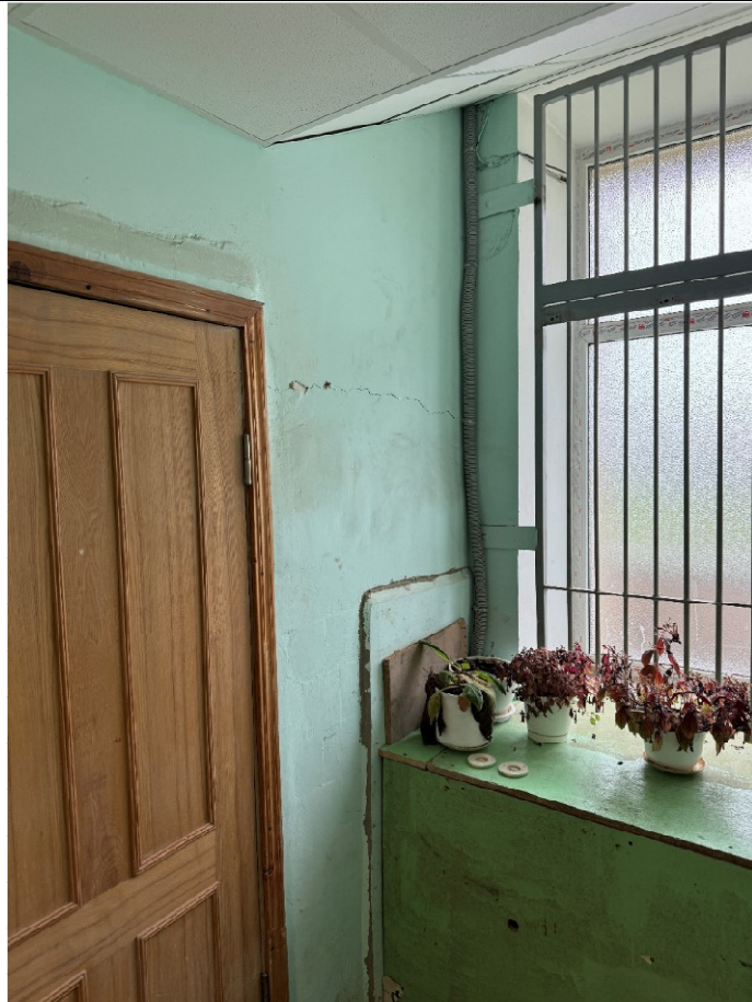
Pirmo aukšto patalpose fiksuojama horizontalūs įtrūkliai
