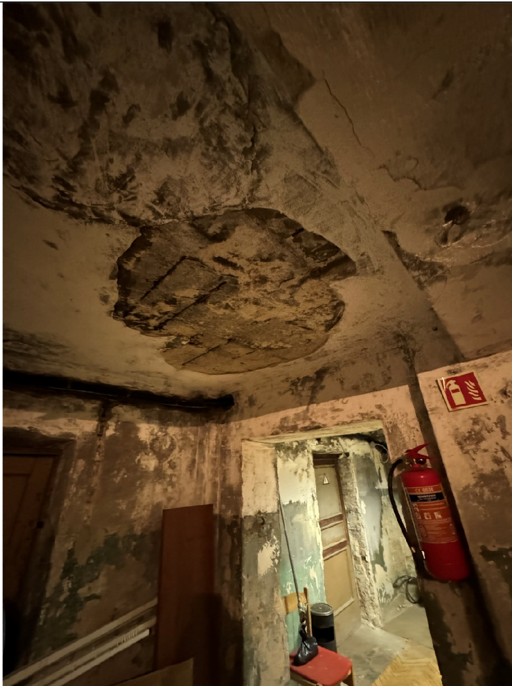
Pusrūsio patalpose fiksuojama pažeista korozijos perdangos armatūra
