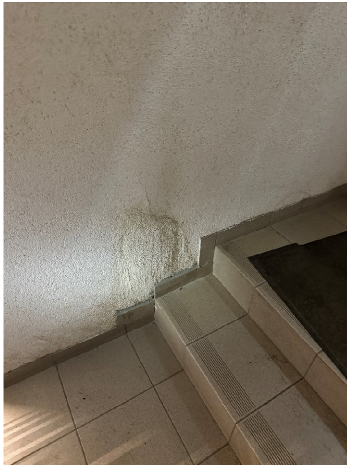
Pirmo aukšto patalpose fiksuojama drėgmės pažeista sienų apatinė dalis
