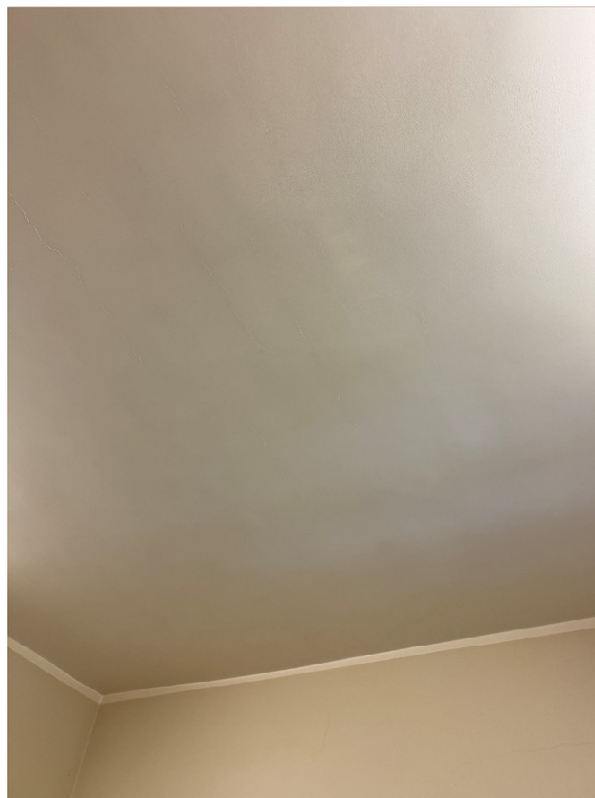
Areštinės patalpose lubose fiksuojami smulkūs daugybiniai įtrūkiai
