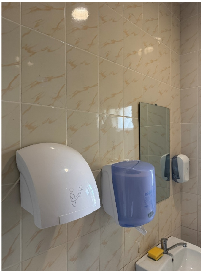
Antro aukšto patalpose apdailoje fiksuojami įtrūkių (Patalpa 2-34)
