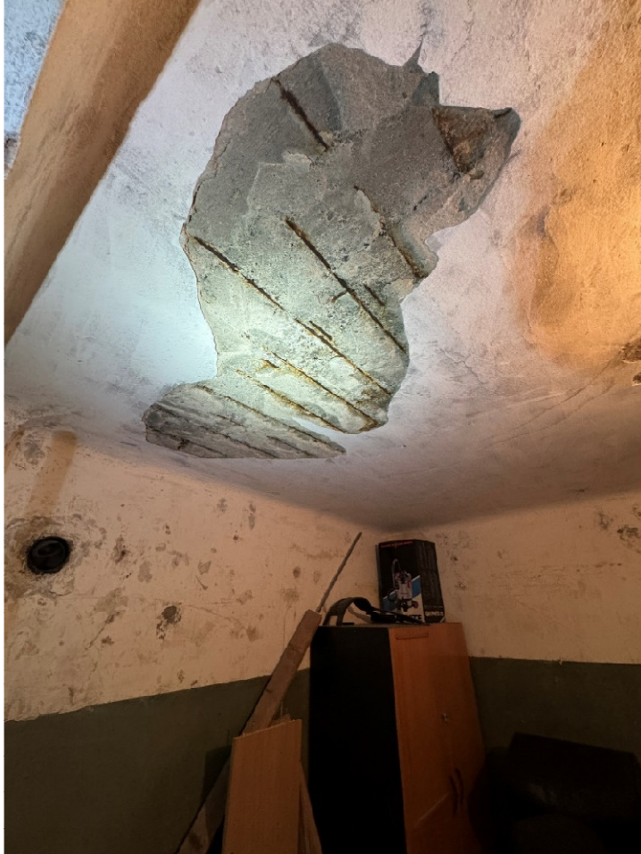
Pusrūsio patalpose fiksuojama pažeista korozijos perdangos armatūra
