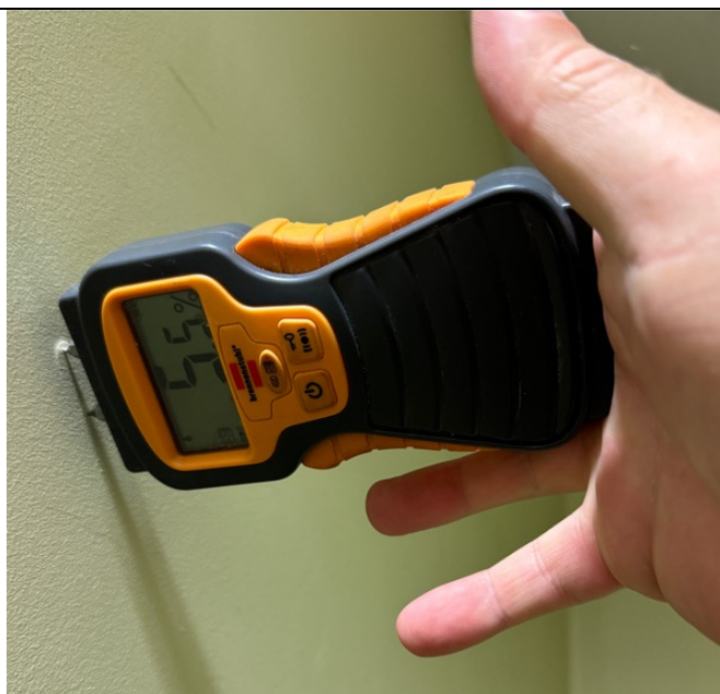
Pamatuota drėgmė pusrūsio sienose, nepažeistoje vietoje (Patalpa P-52)
