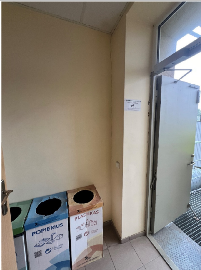
Pirmo aukšto patalpose sienose fiksuojami vertikalūs įtrūkių (Patalpa 1-29)
