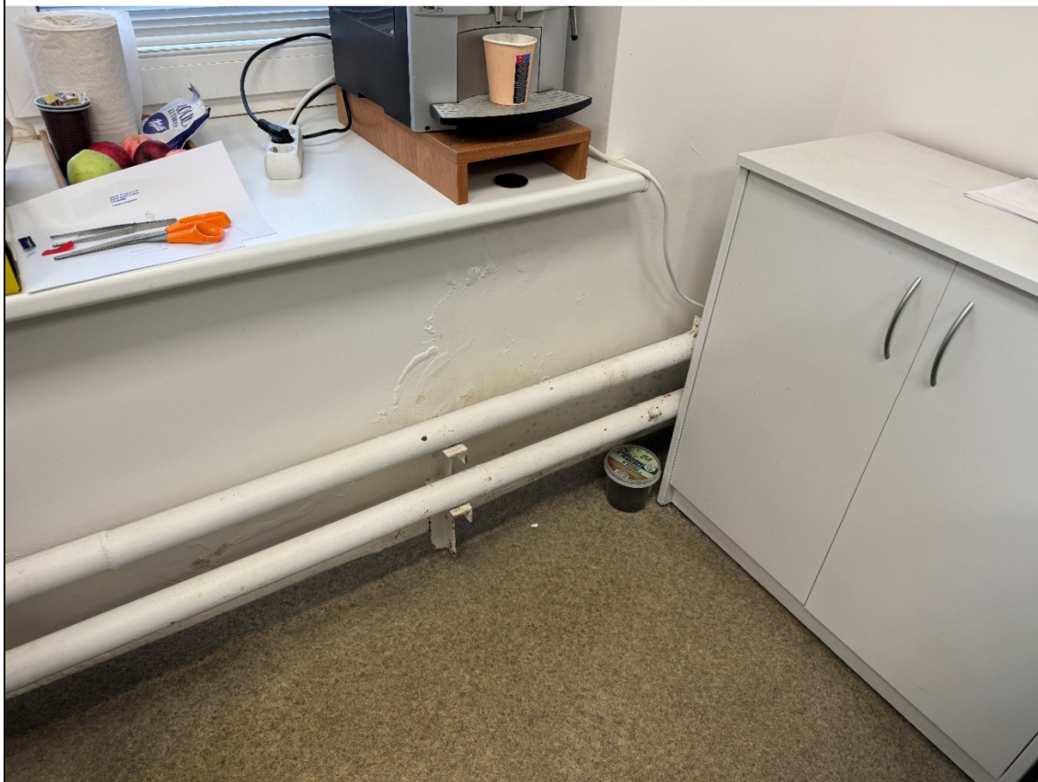
Patalpose fiksuojama drėgmės pažeista sienų apatinė dalis (Patalpa P-32)
