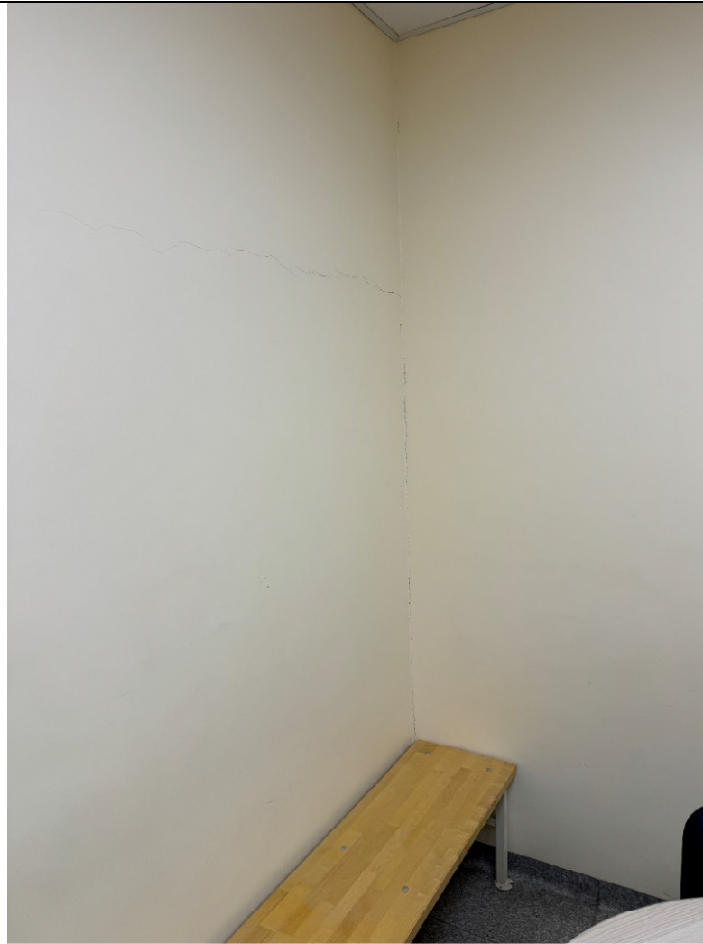
Pirmo aukšto patalpose sienose fiksuojami horizontalūs įtrūkių (Patalpa 1-51)
