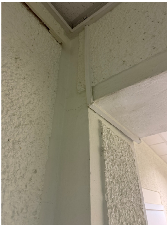
Antro aukšto koridoriuje fiksuojami horizontalūs įtrūkių ties kolona (Patalpa 2-36)
