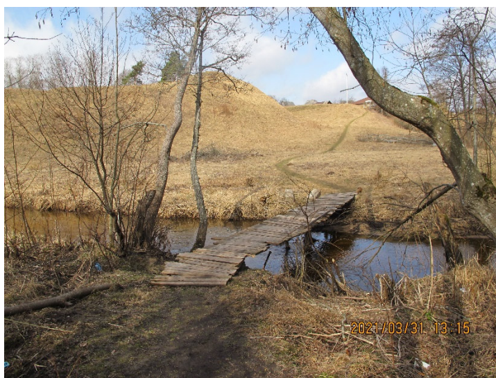
Tiltelis per Nemenčios upę PR sklypo dalyje: planuojamas tiltelio kapitalinis remontas
