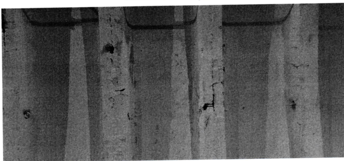
Nuotrauka Nr. 8 vyksta darbo armatūros korozija, atšokęs betono apsauginis sluoksnis
