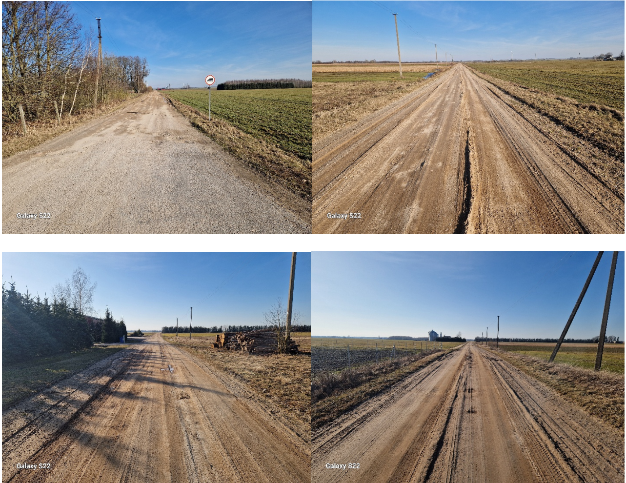
1 pav. Esama kelio būklė
