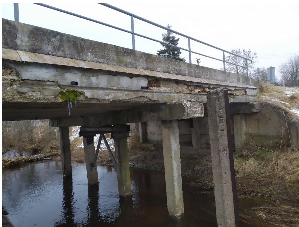
7 pav. Kraštinės plokštės apsamojusios, drėgsta
