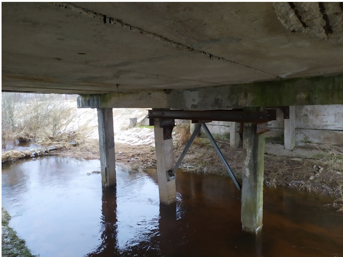
9 pav. Apsamanoję rygeliai su atramomis, nuolat drėkinami. Pažeisti tarpinės atramos poliai.
