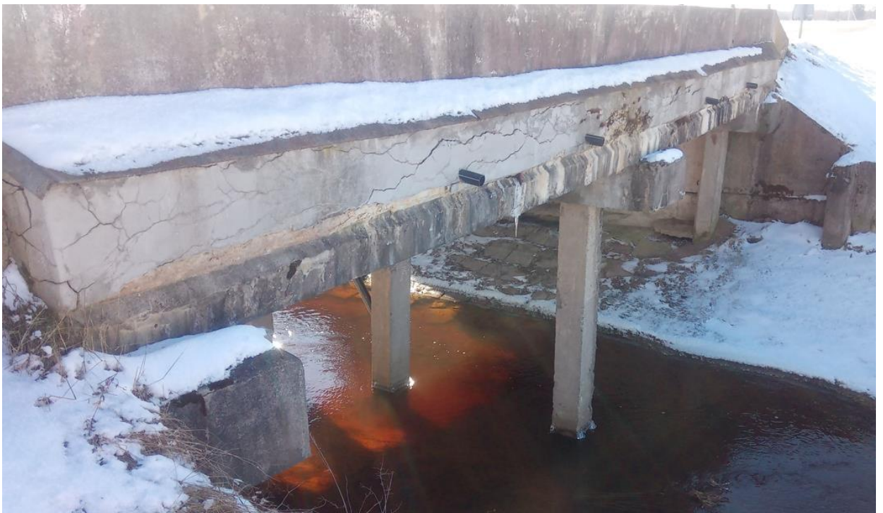
5 pav. Tilto per Suosą būklė. Matomi ryškūs įtrūkimai.
