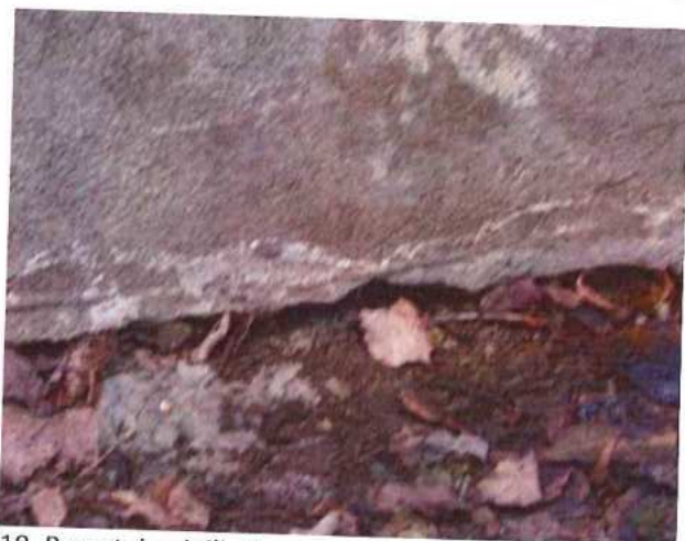
19. Pamatai neįgilinti, matomos ertmės ties sankirta su gruntu.
