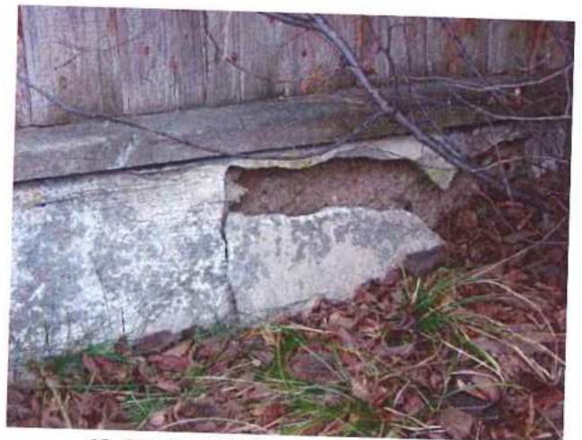
40. Erozijos pažeistas pamatų betonas.
