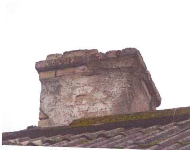
34. Išdegęs kamino mūras.
