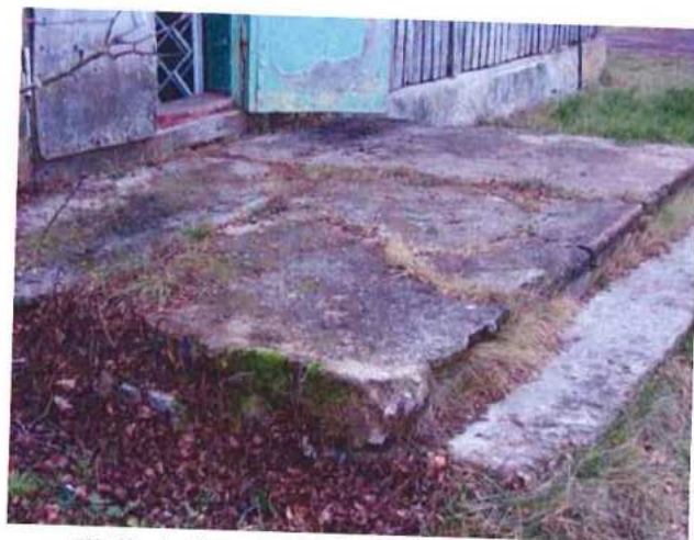
22. Supleišėjusi, deformuota laiptų aikštelė.
