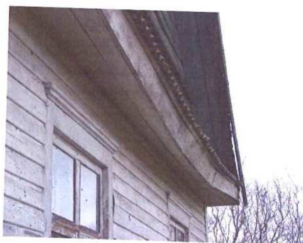
12. Nusėdęs pastato karnizas.
