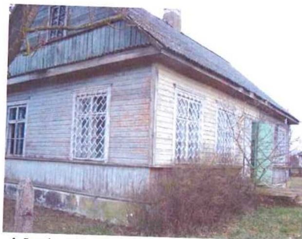
4. Bendras tiriamo objekto vaizdas. Matomi praradę spalvą fasado dailylenčių dažai.
