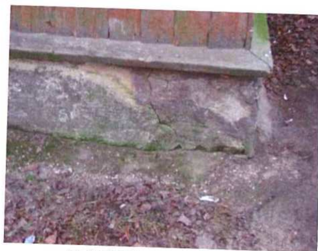
18. Supleišėjęs pamatų betonas.
