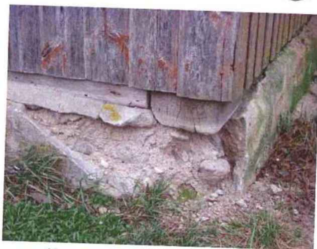
14. Erozijos suardytas pamato betonas.
