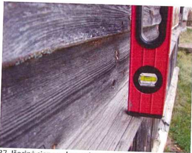
37. Išorinė siena nukrypusi nuo vertikalės į išorinę pusę.
