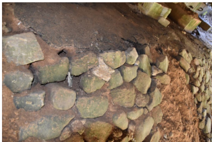
14 pav. Vietomis išplautas gruntas ir suiręs šlaito tvirtinimas akmenimis
