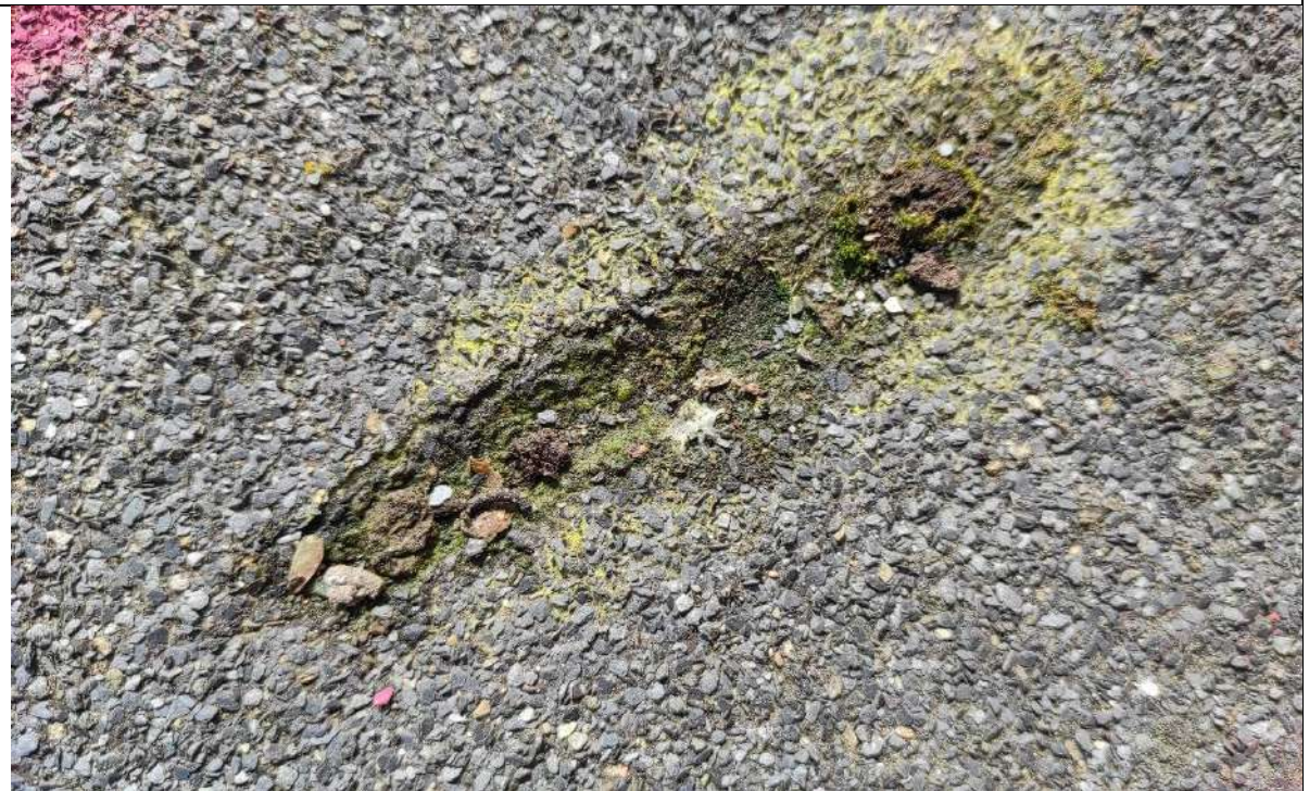
37. Stogo dangos mechaninis pažeidimas.
