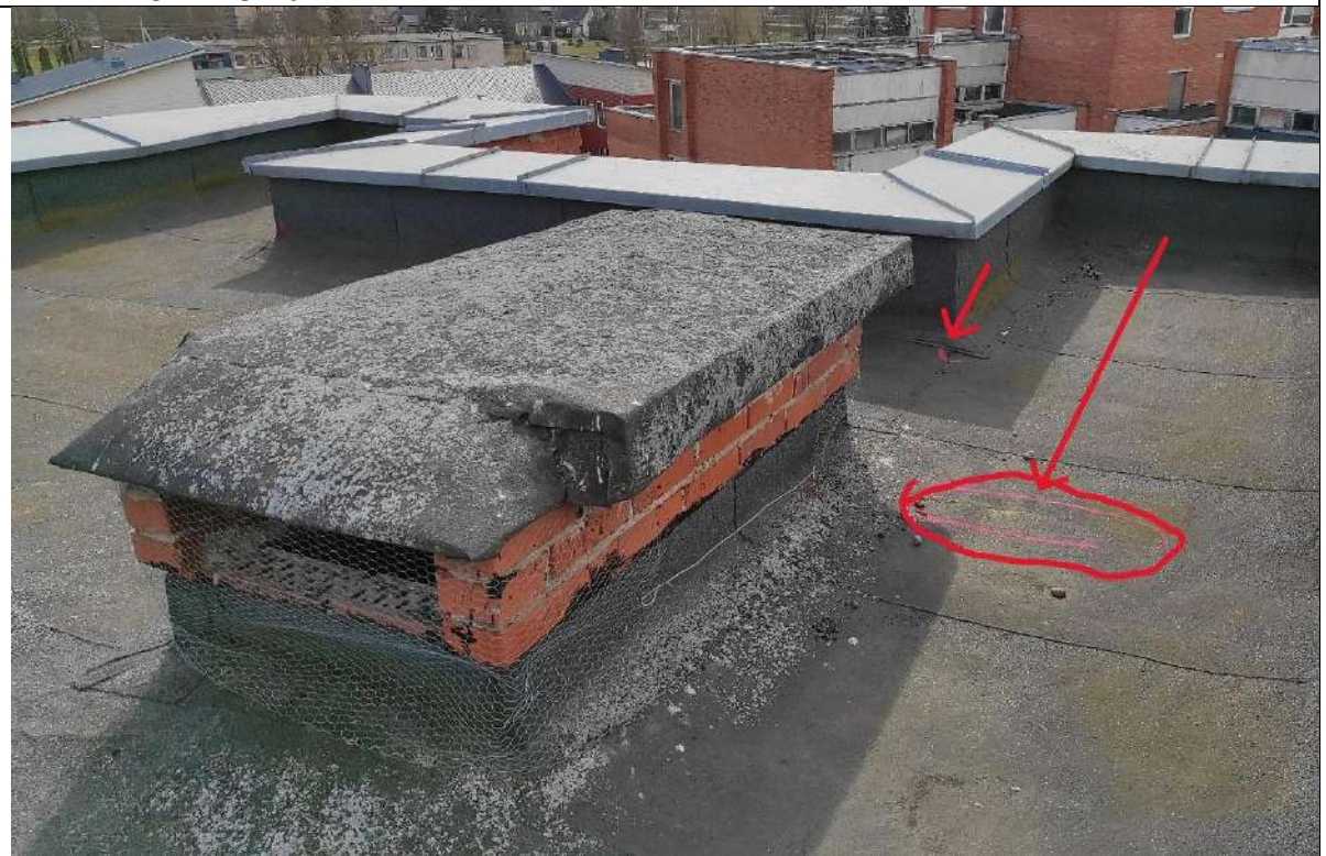
72. Stogo dangos įtrūkimai.
