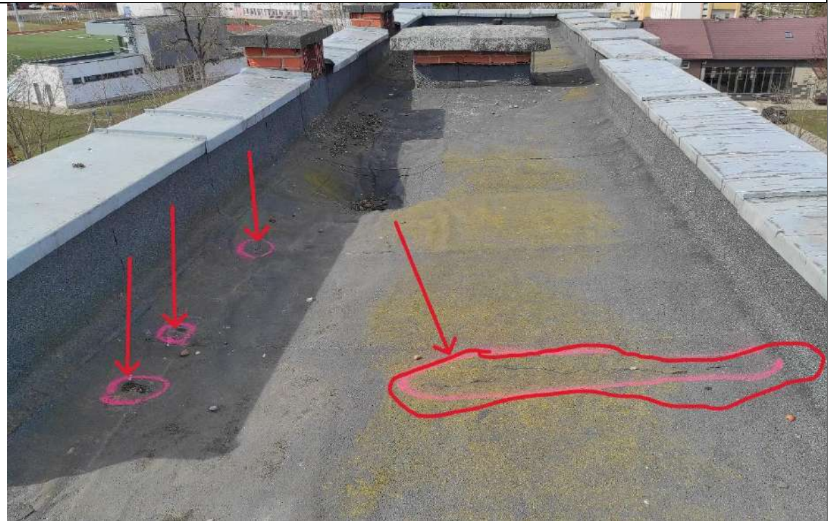
66. Stogo dangos mechaniniai pažeidimai, įtrūkimai.
