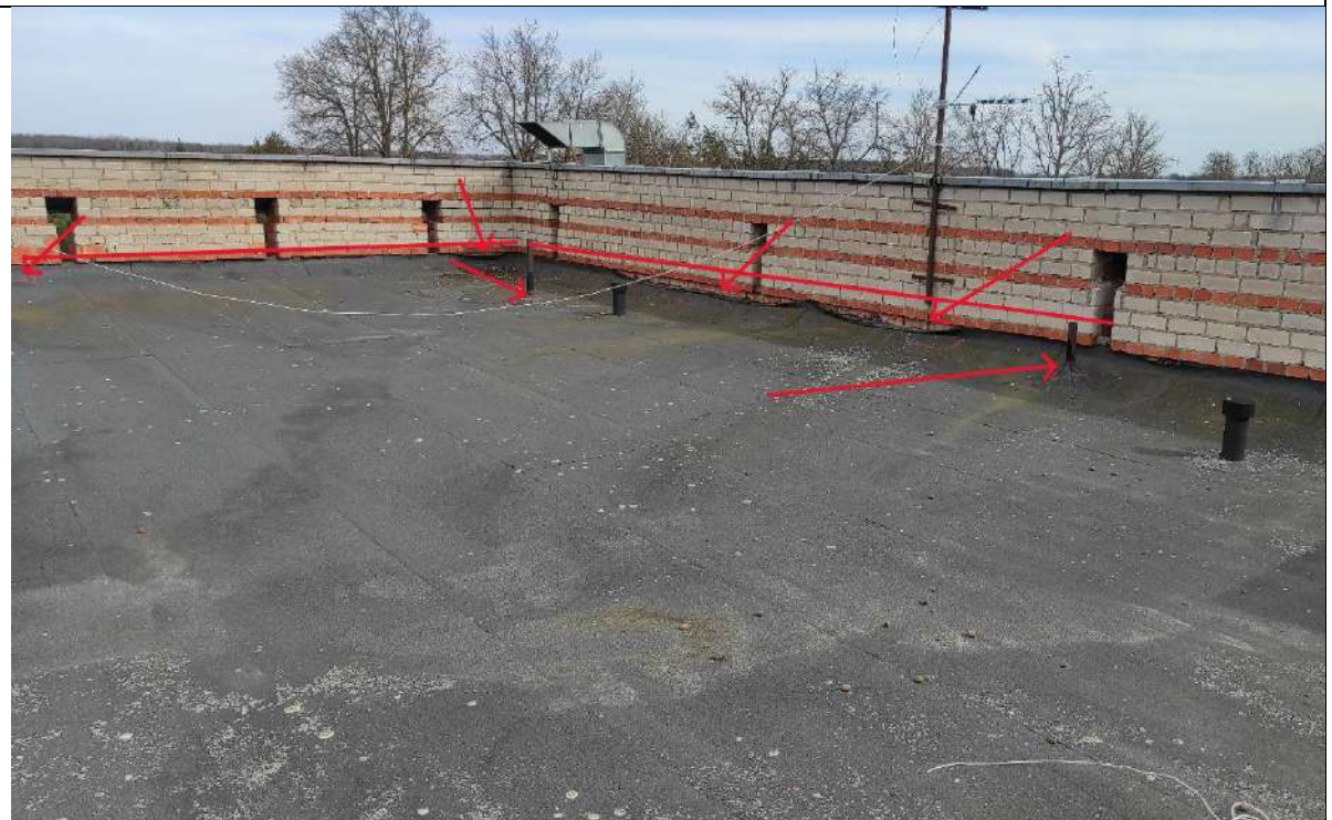
45. Atšokusi stogo danga nuo parapeto vertikaliuos plokštumos, nesandarumai prie įlajos, nėra sumontuotų skardinių prieglaudų.
