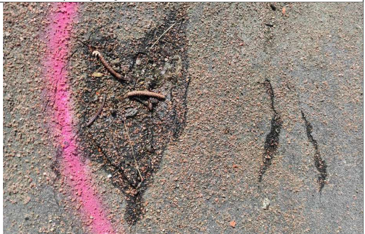
6. Po stogo danga didelis drėgmės kiekis.
