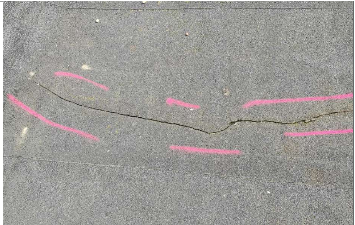
71. Stogo dangos įtrūkimai.
