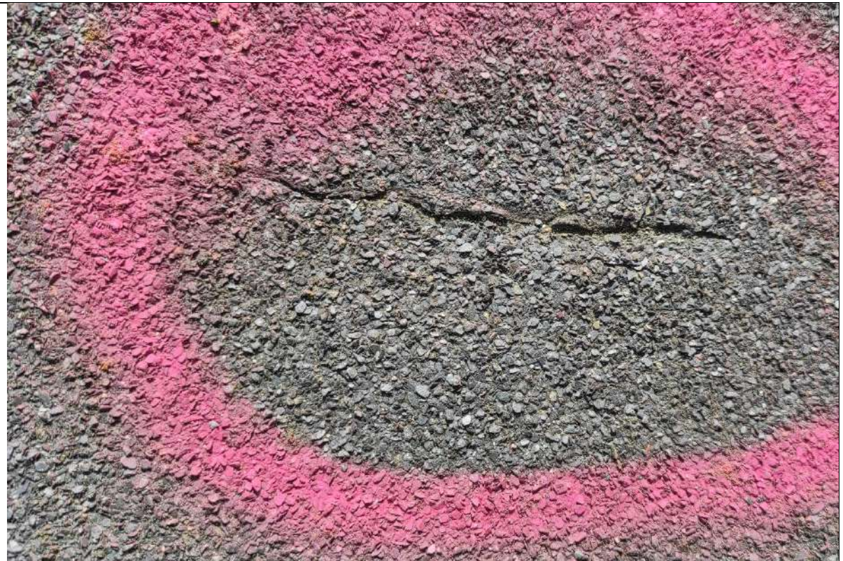
36. Stogo dangos įtrūkimas.
