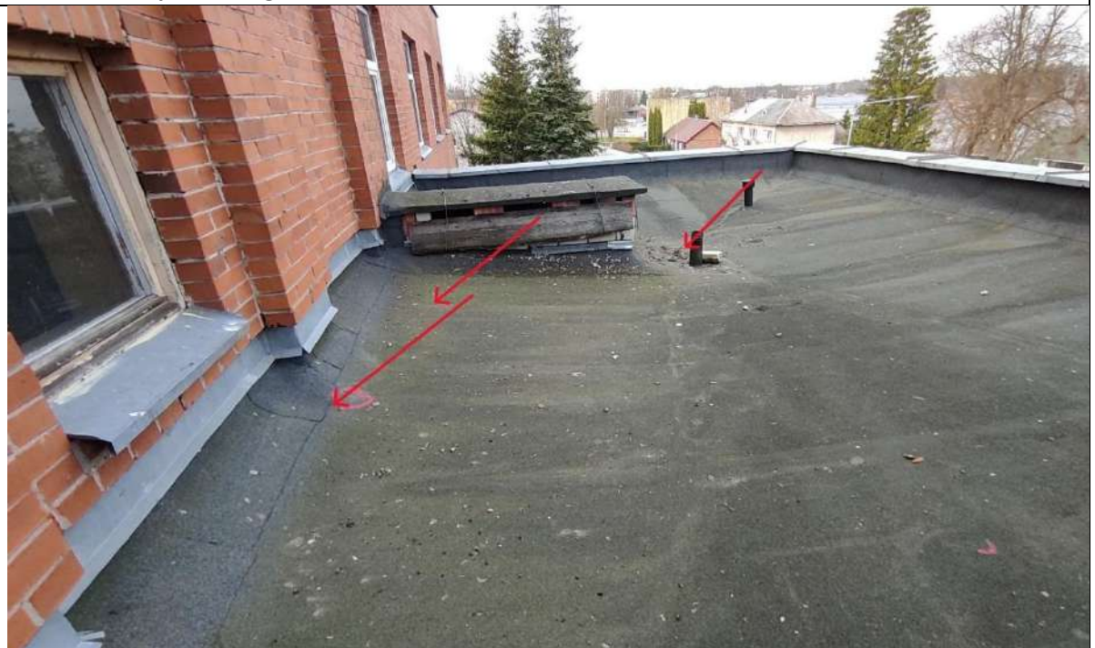
53. Stogo dangos įtrūkimai, mechaniniai pažeidimai, nesandari dangų sulydymo siūlė prie įlajos.
