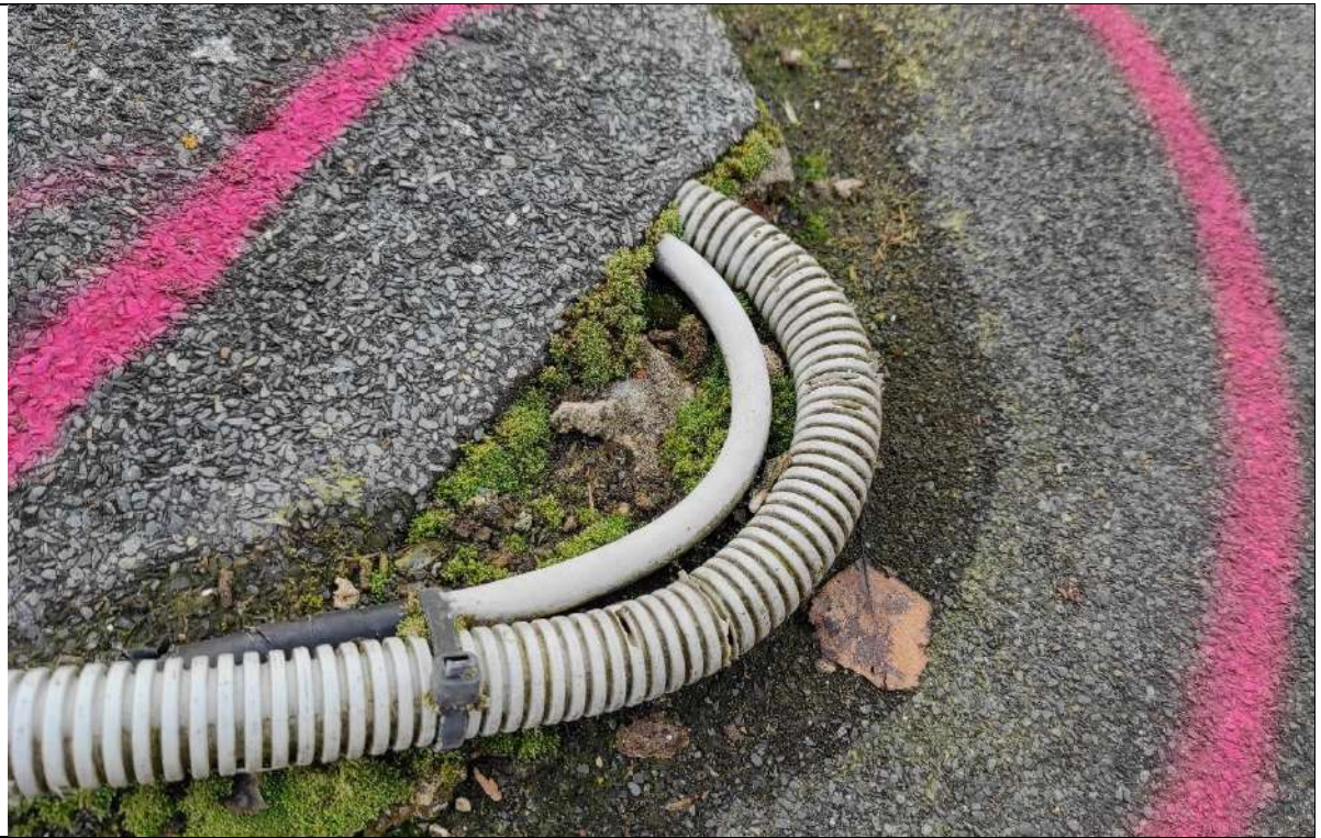
50. Vaizdas iš arti. Neužsandarinti prie ventilacijos išvesti kabeliai.
