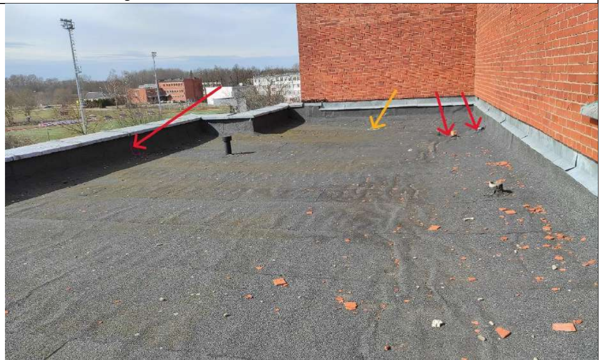
86. Mechanškai pažeista danga prie parapeto. Nesandarumai prie įlajos. Nesandarumai prie alsuoklio.
