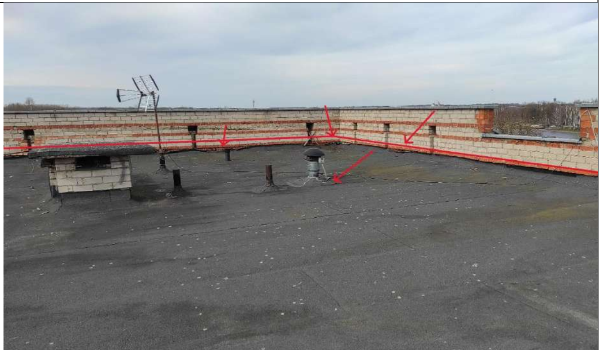
49. Atšokusi stogo danga nuo parapeto vertikalios plokštumos, nesandarumai prie ventilacijos agregato.
