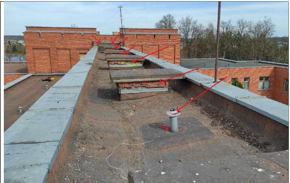
15. Sutrupėjęs ventiliacinių šachtų mūras, erodavęs stogo vėdinimo kaminėlių plastikas, nesandarumai prie įlajų, stogo dangos įtrūkimai.
