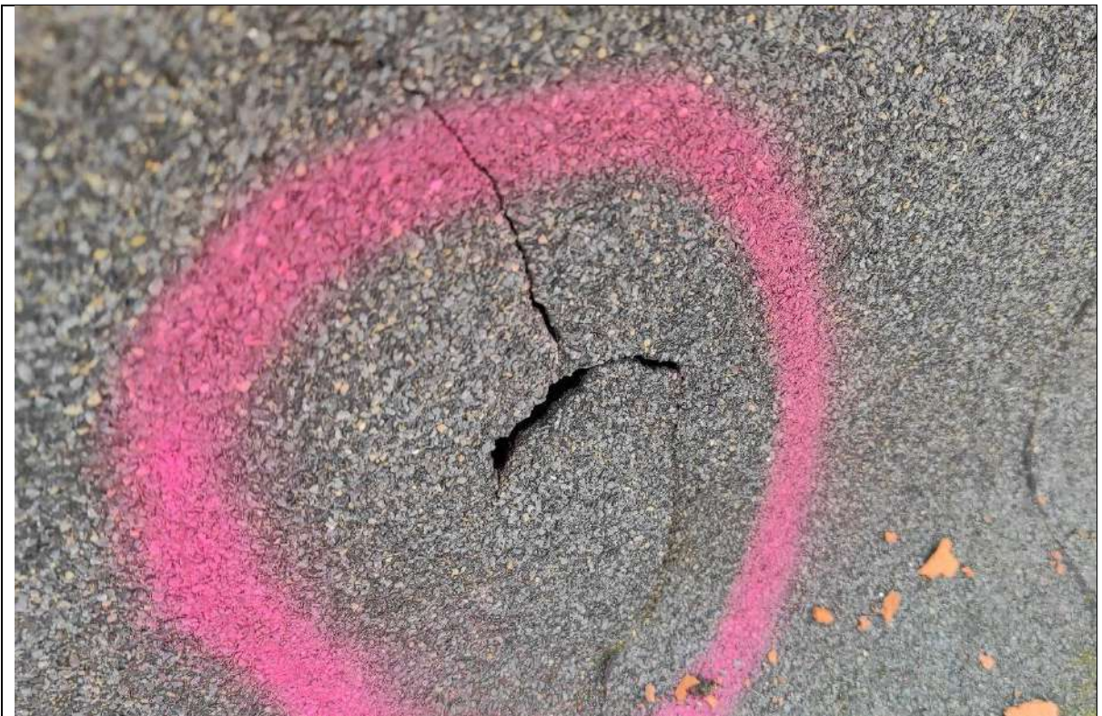
87. Vaizdas iš arti. Parapeto vertikaloje plokštumoje mechaniškai pažeista danga.
