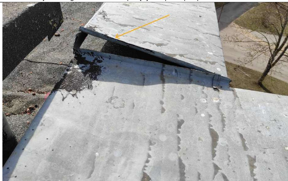
76. Vaizdas iš arti. Atplėšta parapeto skarda.
