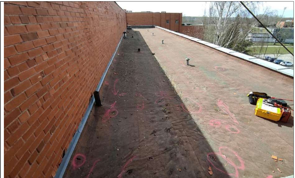
3. Šioje stogo dalyje danga labai nusidėvėjusi – beveik nelikę apsauginio stogo dangos pabarsto, stogo danga sutrūkinėjusi, stogo vėdinimo kaminėliai suirę.
