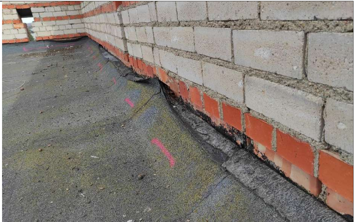
46. Atšokusi stogo danga nuo parapeto vertikaliuos plokštumos, nesandarumai prie įlajos, nėra sumontuotų skardinių prieglaudų.
