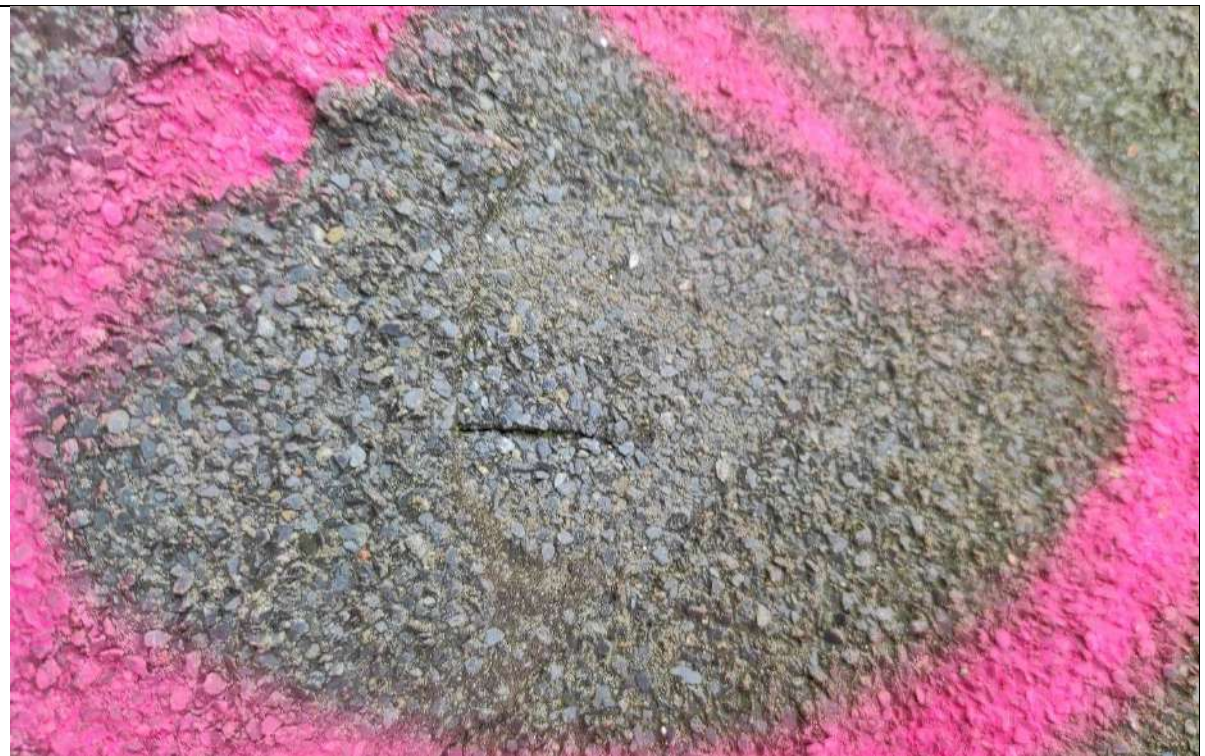
54. Stogo dangos įtrūkimai.
