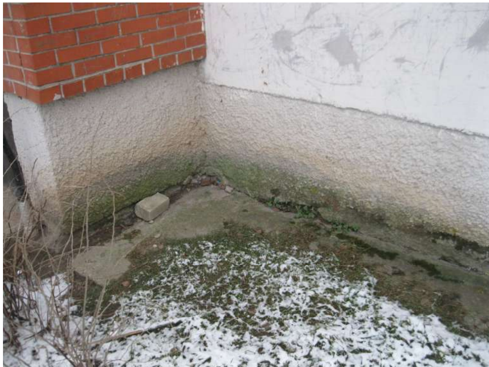
11 pav. Bendras nuogrindos vaizdas. Betoninė nuogrinda išsikreivinus, betonas suskilinėjęs, nuogrinda, pasvirusi į pastato pusę; vietomis nuogrinda iš viso nėra įrengta arba jau yra visiškai sunykusi, to pasekoje gadinama cokolio apdaila ir drėkinami pastato pamatai.
