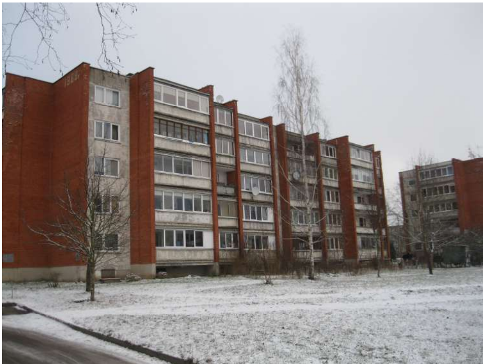
2 pav. Pietinio pastato fasado bendras vaizdas. Kai kurie balkonai neįstiklinti, o likę balkonai įstiklinti plastikiniiais, mediniais langais ar stumdomais aliuminio rėmų įstiklinimais. Nevienodas yra įstiklinimų suskaidymas. Dėl skirtingo balkonų įstiklinimų medžiagiškumo bei įstiklinimų suskaidymų šis pastato fasadas atrodo ypač netvarkingai.
