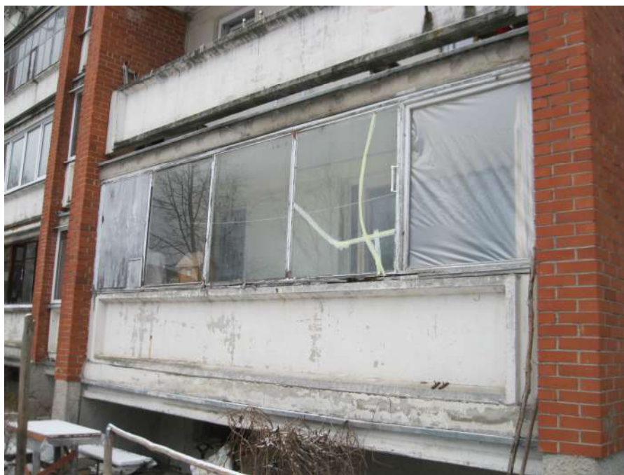
7 pav. Dalis medinių balkonų įstiklinimų visiškai susidėvėję: jų rėmai papuvę, deformuoti, stiklai suskilę ar išdaužyti.
