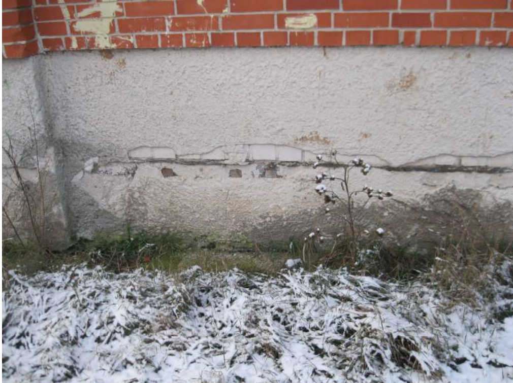
13 pav. Cokolinės pastato dalies tinko pažeidimai: tinkas vietomis nukritęs, su plyšiais, įdrėkęs, apsamojęs.
