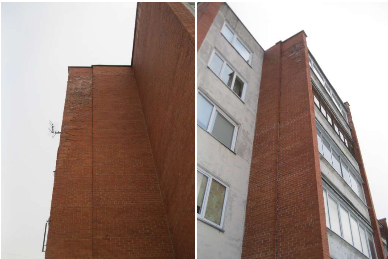
5 ir 6 pav. Nuotraukose matyti apdailinio plytų mūro pažeidimai ir plyšiai tarp pastato sienos ir balkonų sienučių.
