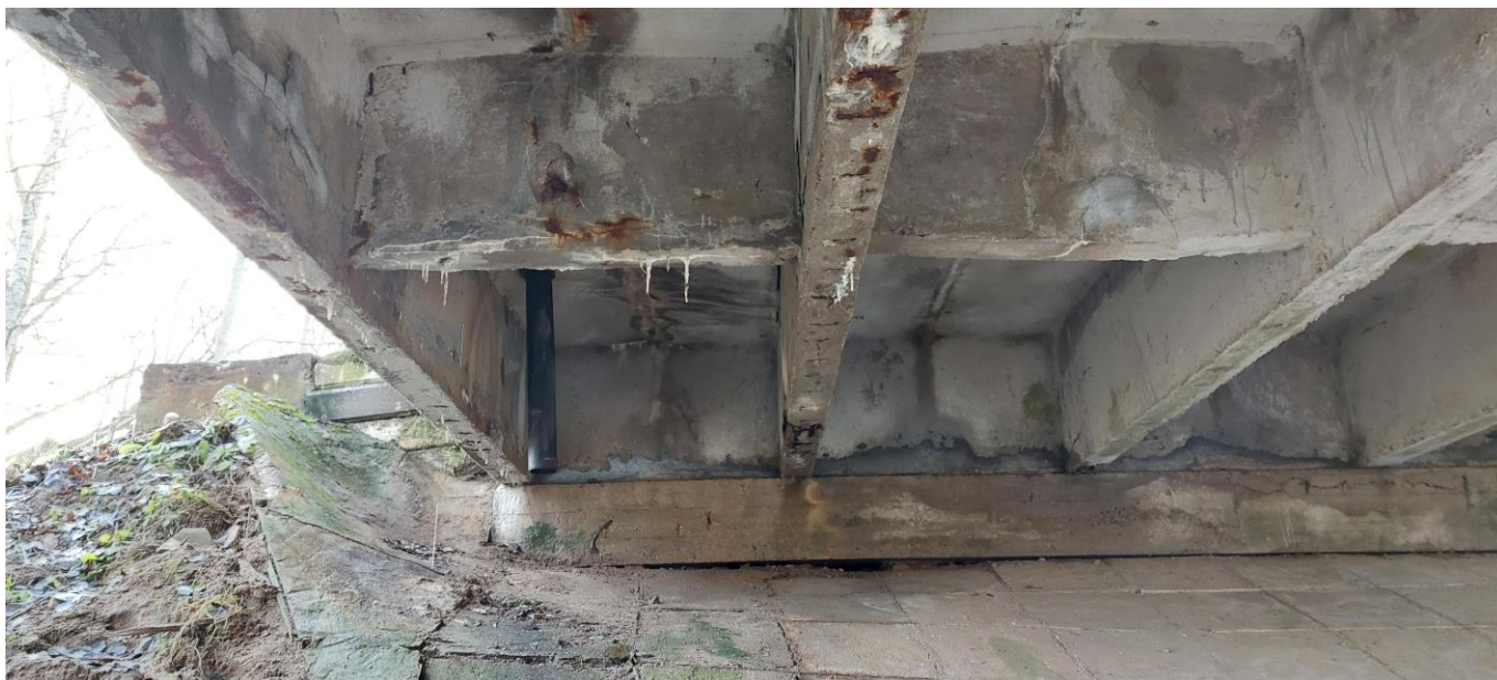
2 pav. Pažeistas perdangos išilginių sijų ir skersinių sijų (diafragmų) apsauginis betono sluoksnis
