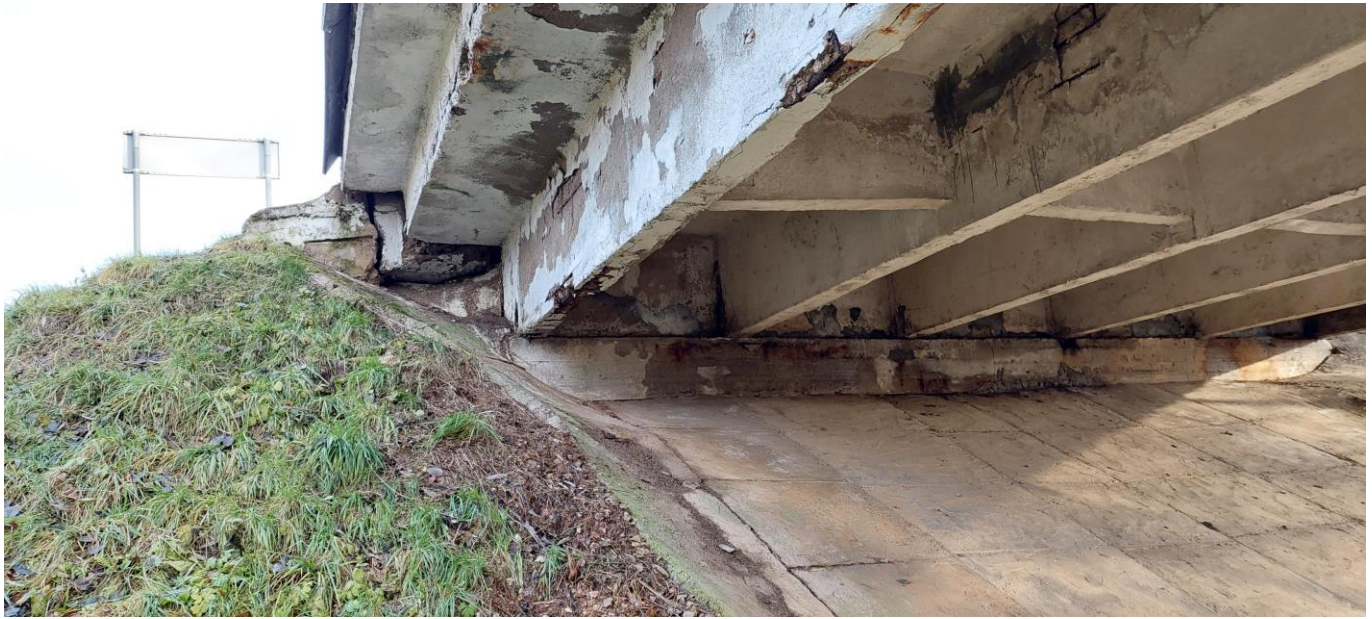
4 pav. Rėmsijėse nutrupėjęs betonas, plyšiai, koroduoja armatūra
