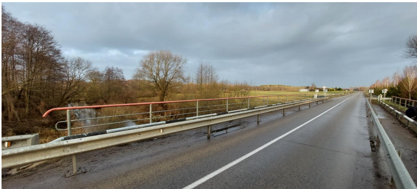
6 pav. Provėžos ir plyšiai kelio dangoje
