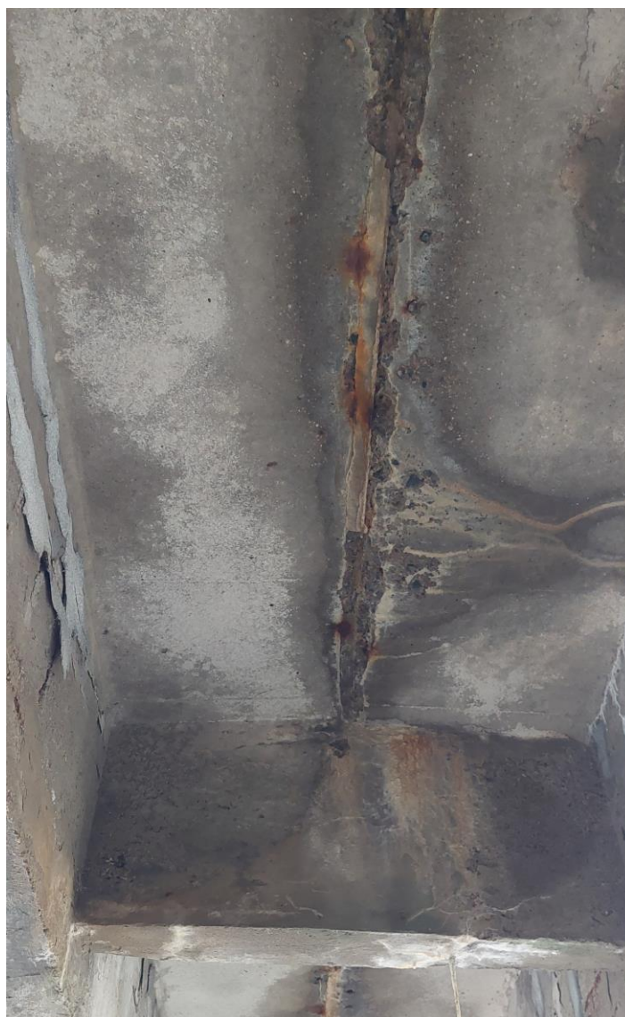
7 pav. Nutrupėjęs betonas išilginių sijų apjungimo vietose
