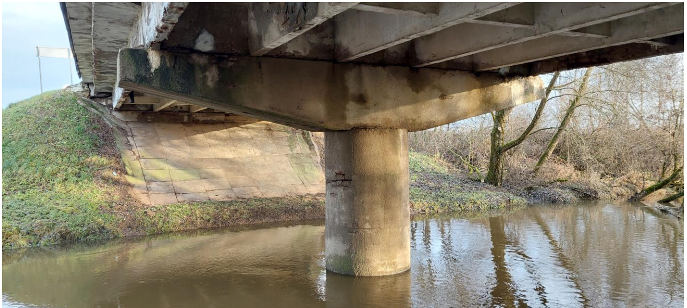
5 pav. Nutrupėjęs tauro betonas, matoma korozijos paveikta armatūra
