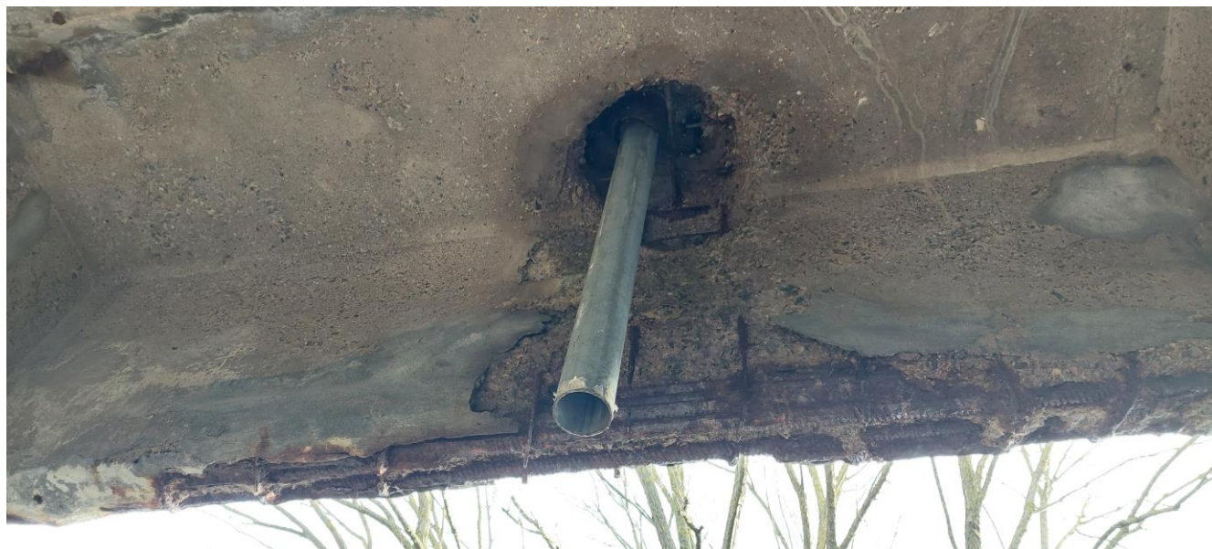
8 pav. Ties šulinėliais ištrupėjęs betonas, matoma koroduojanti armatūra
