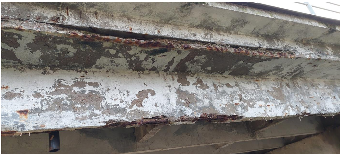
3 pav. Šaltilčio sijų pažeistas betonas
