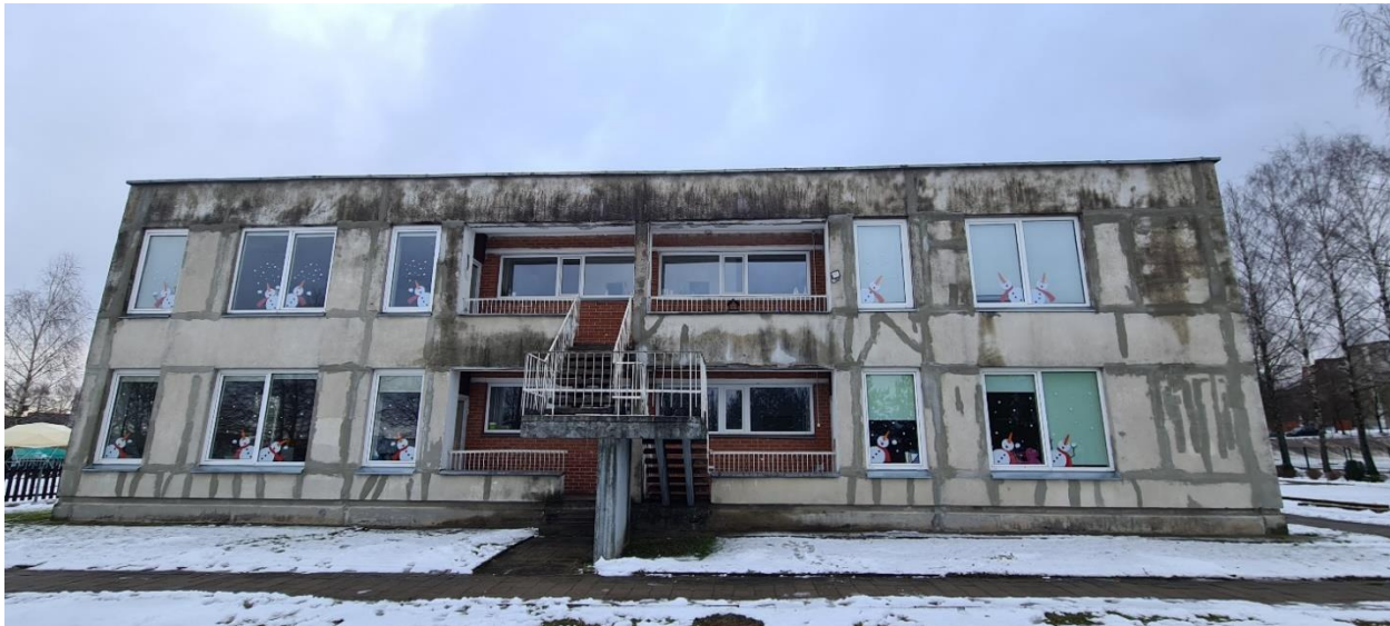
Nuotrauka Nr. 7 Fasadinių dujų silikato plokščių apatinėje dalyje nuo drėgmės ir šalčio poveikio nukritusi dalis dujų silikato, matoma koroduojanti armatūra (keturios plokštės laiptų maršo dalyje)
