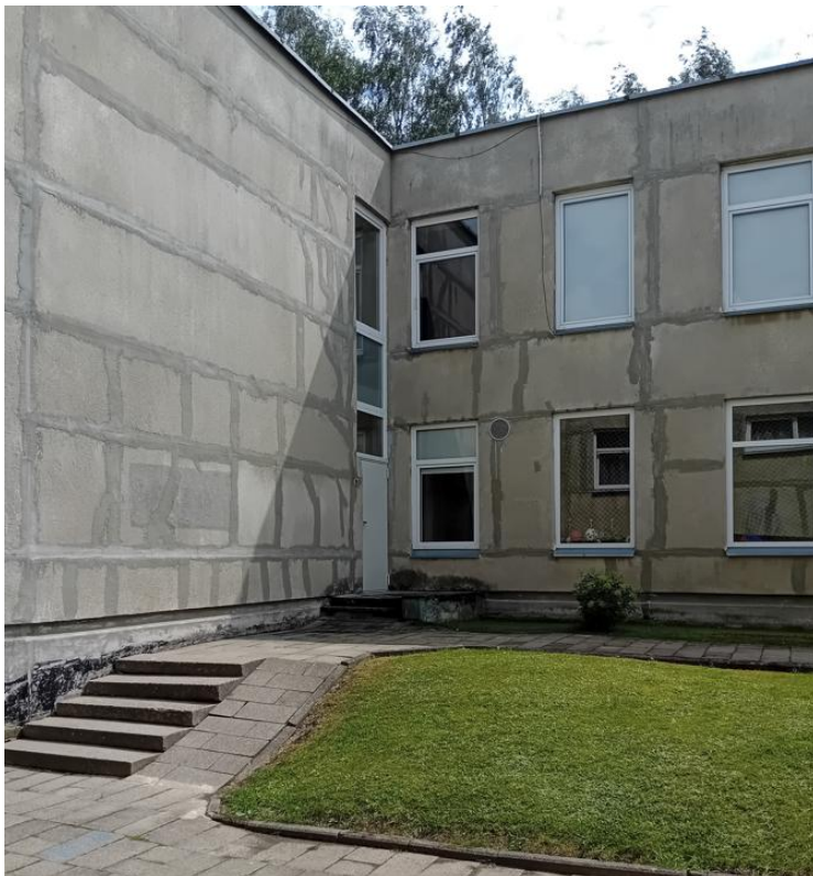
7 pav. Vidiniuose kampuose, prie laiptinės langų, esantys patalpų langai neatitinka šiai dienai keliamų reikalavimų, nėra 2 m atstumo tarp jų. 1 ir 2 aukštuose patalpų šoniniai langai prie laiptinės, bus pakeisti priešgaisriniais, paplatintos durys į lauką iki 1,2 m pločio.
