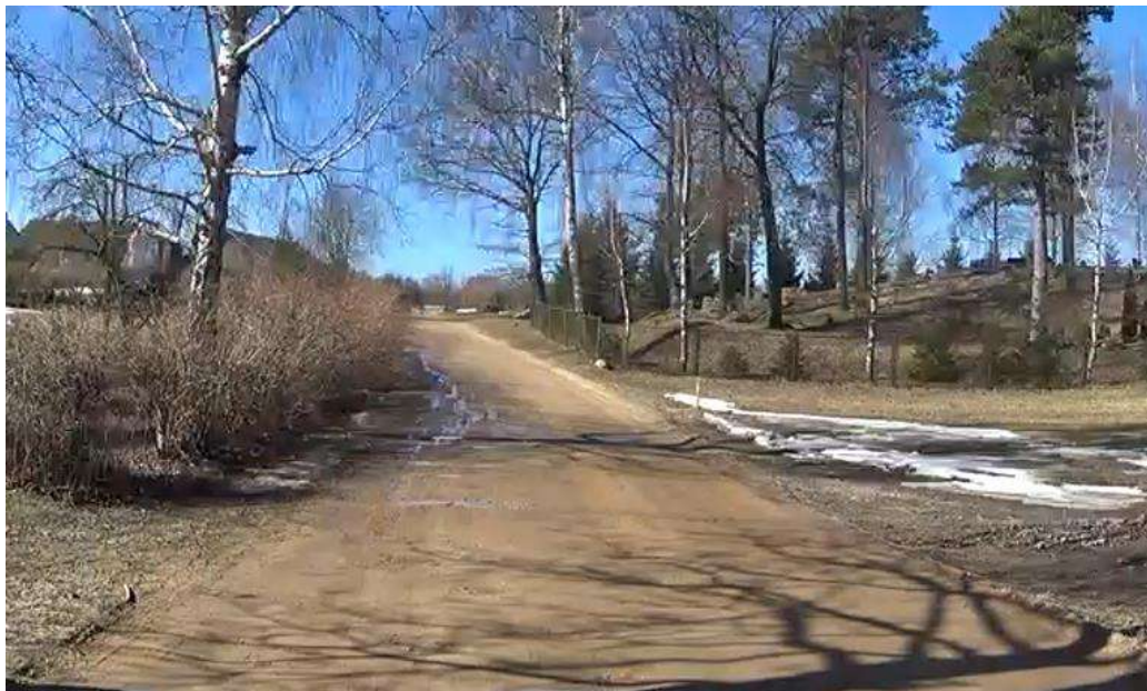
2 pav. Kelio techninė būklė (2022 m.)
