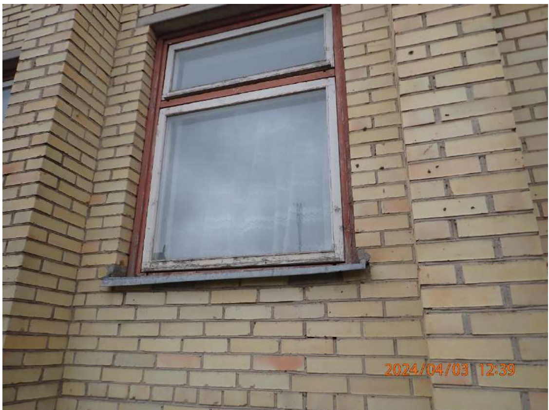
Nuotrauka Nr. 4. Nesandarus langai, puvėsio pažeista langų konstrukcija
