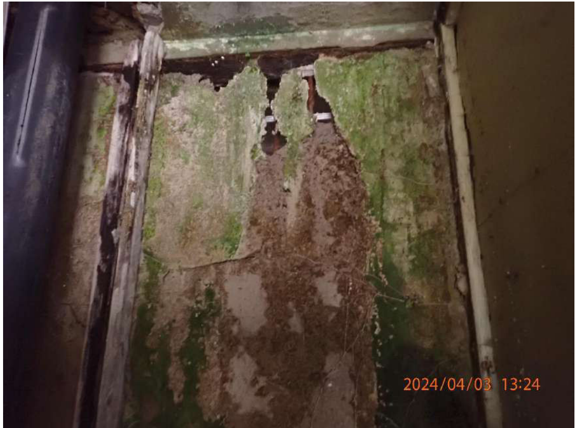
Nuotrauka Nr. 11. Kai kurios medžio-gipso plokščių pertvaros dėl drėgmės poveikio visiškai suniokotos.
