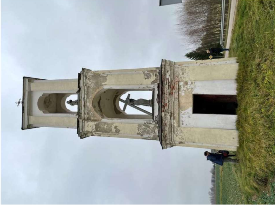
Nuotrauka Nr. 3. Kopolytėlės bendras vaizdas ašyje „A“. Matosi pažėisti dažyti paviršiai, apnuogintas plytų mūras. Nuogrinda neįrengta. Pirmame tarpsnyje įėjimas, durys atsidaro į vidų. II ir III tarpsniuose – statulos.
