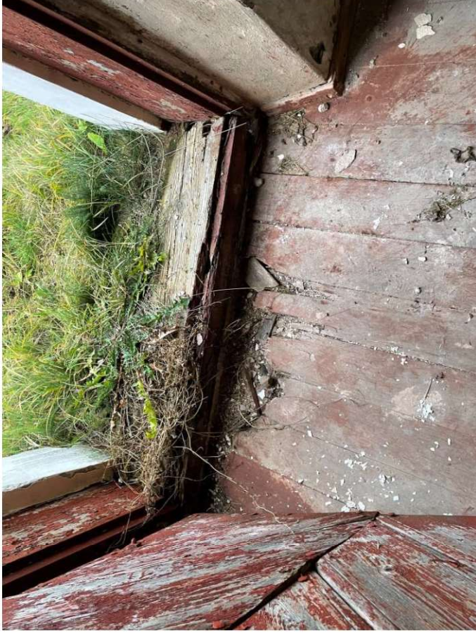
Nuotrauka Nr. 14. Durų fragmentas iš vidaus, matosi durų stakta ir grindys. Stakta pažeista drėgmės ir puvinio, apaugusi žole. Grindys ties durimis supuvę, įrengtos 1979 m projekto metu.
