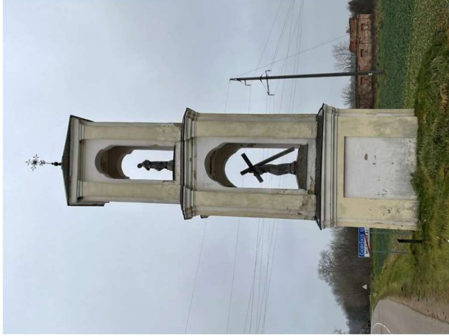
Nuotrauka Nr. 1. Koplytėlės bendras vaizdas ašyje „B“, tarp ašių „2-1“. Matosi statinio pasvirimas ašies „1“ kryptimi. Pažeisti dažyti paviršiai. Nuogrinda neįrengta. Kopyčios stogų danga medinių čerpių – malksnų. Karnizai apskardinti.
