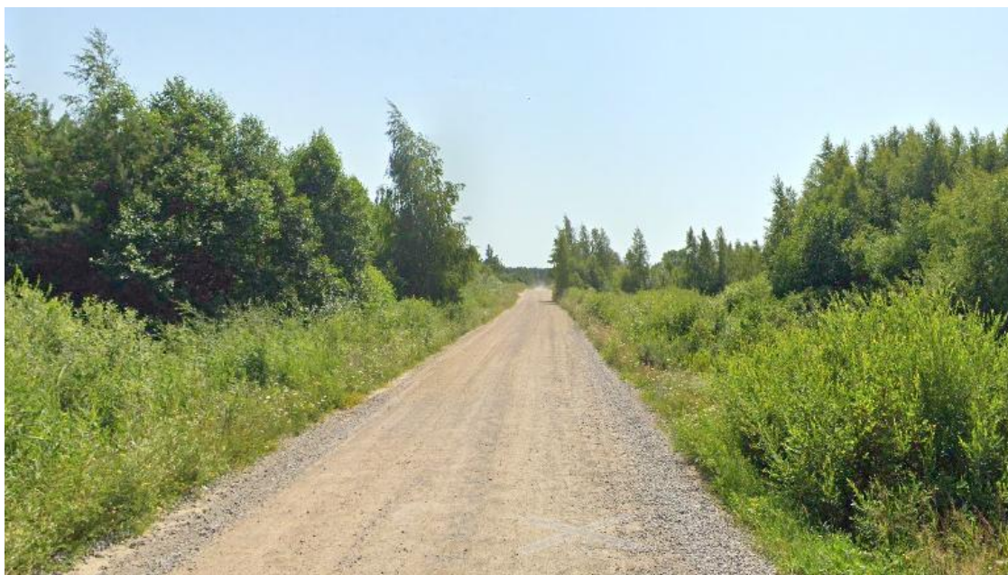
Pav. 5. Gatvės techninė būklė
