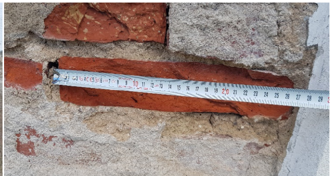
FF-13. V fasado fragmentas: nutrupėjęs tinkas, atsidenęs plytų mūras I tarpinio nišoje
