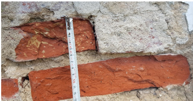
FF-12. V fasado fragmentas: nutrupėjęs tinkas, atsidenęs plytų mūras I tarpinio nišoje
