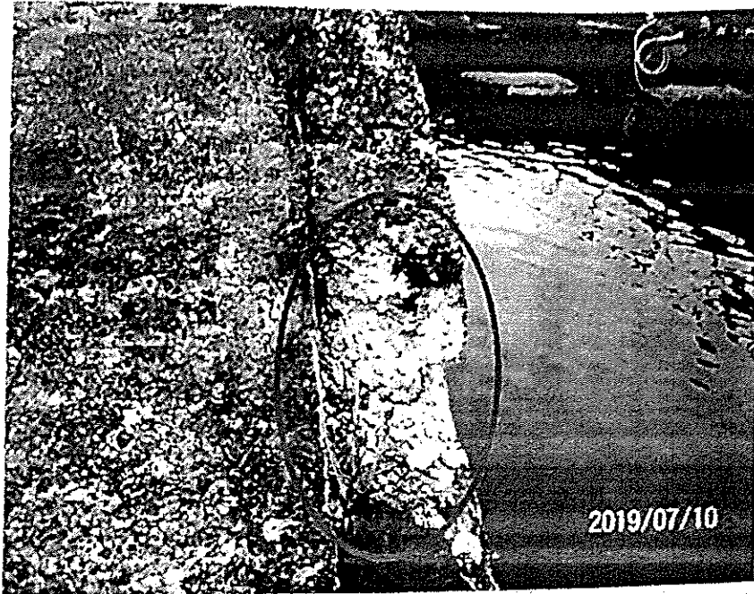
4.25 pav. Dėl prastos kokybės betono vyksta betono irimas užslenksčio dešiniojo ramto gale
