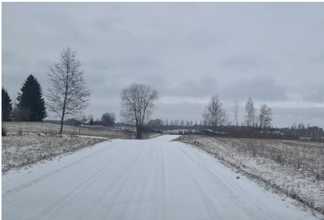
2 pav. Kelio techninė būklė (2023 m.)
