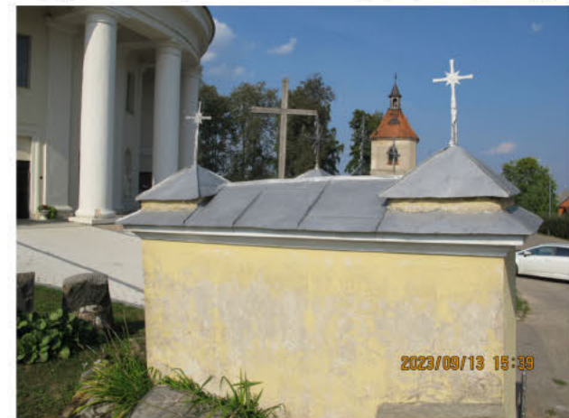
Susidėvėję vartų koplytėlės viršaus apskardinimai
