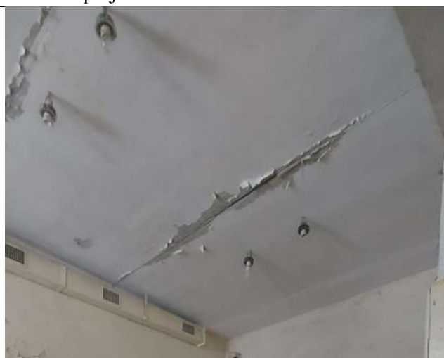
5 pav. Dažų atsilupinėjimas išilgai perdangos plokščių
