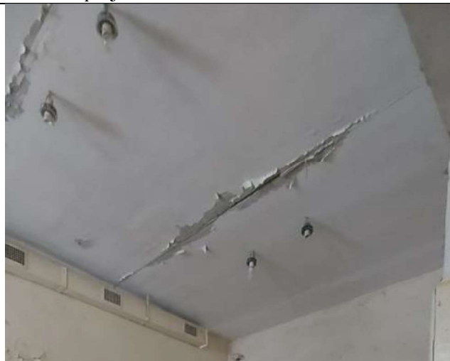
5 pav. Dažų atsilupinėjimas išilgai perdangos plokščių
