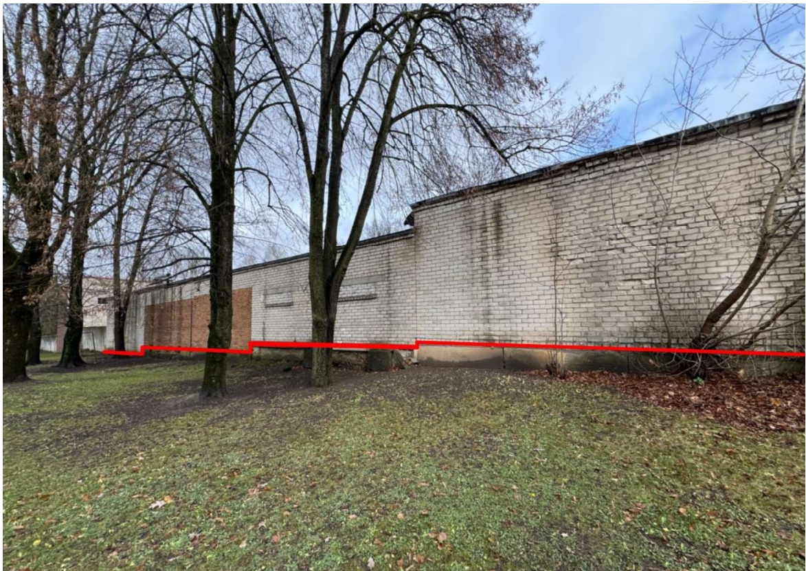
7 pav. Pastatų pamatų aukščių skirtumai ties sienų plyšių vietomis
