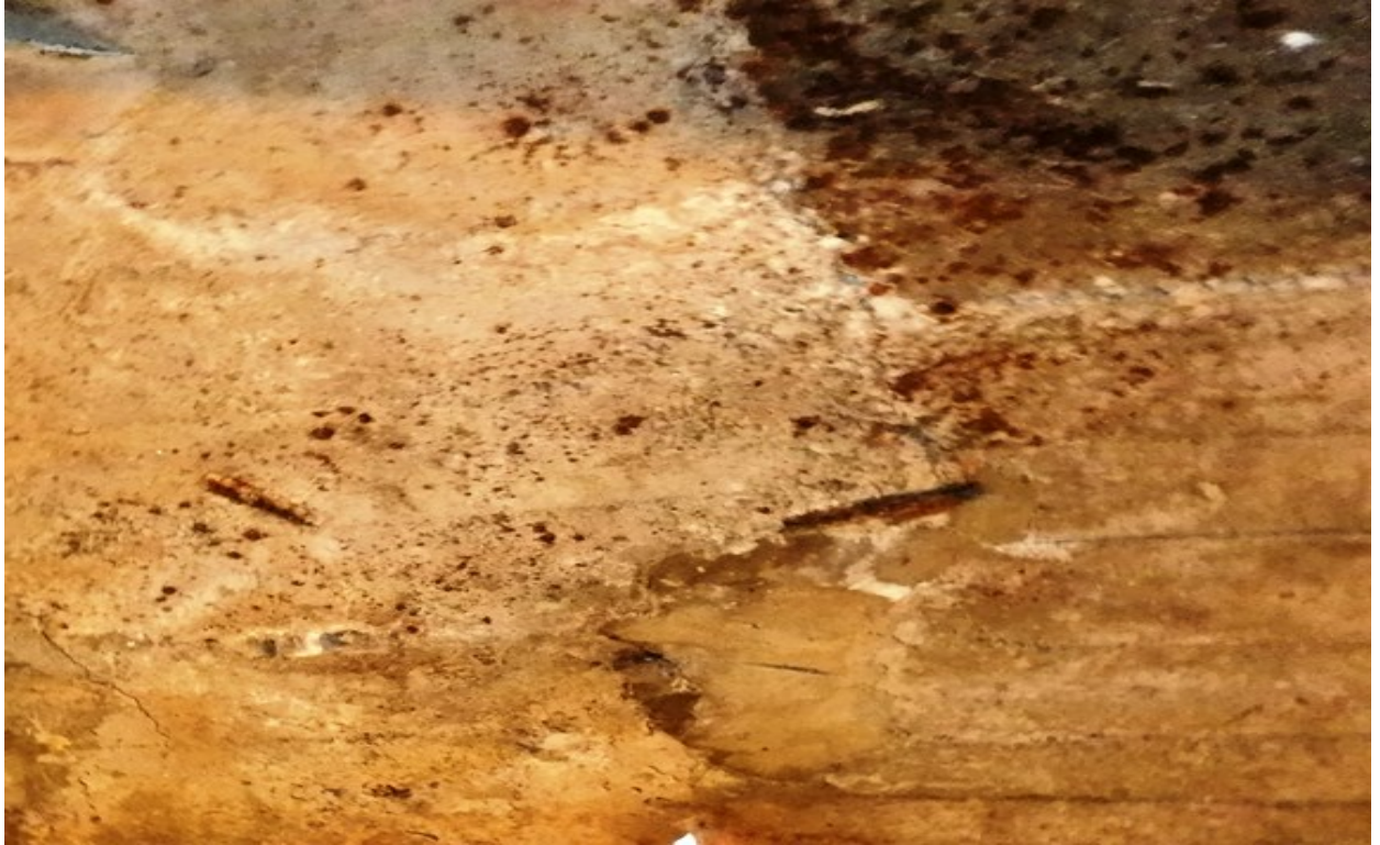
S 5 – stiebo jungtyje su rezervuaru betono paviršiuje susidariusios balkšvos kalkių nuosėdos, įdėtinių detalių korozija.
