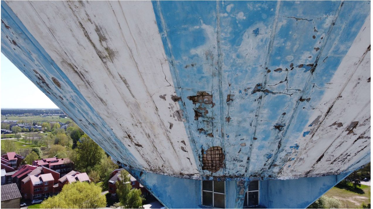
Armatūros apsauginio sluoksnio ištrupėjimai Alt. +40,00 - +43,00 m. (2024 m) – Šiaurės-Rytų pusė
