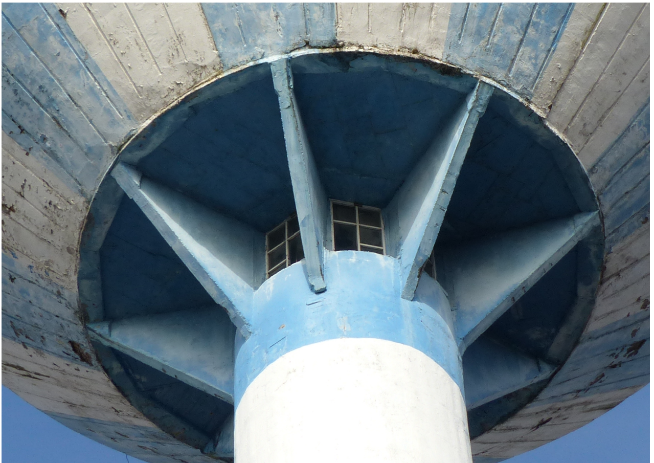
Laikančiųjų atramų apsauginio betono sluoksnis (2021 m.)
