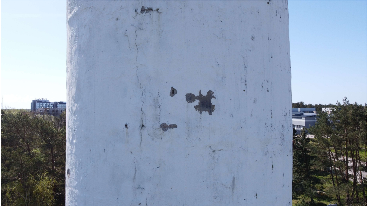
Įtrūkis gelžbetoniniame kamiene Alt. +13,00 - +18,00 m. (2024 m.) Šiaurinė pusė
