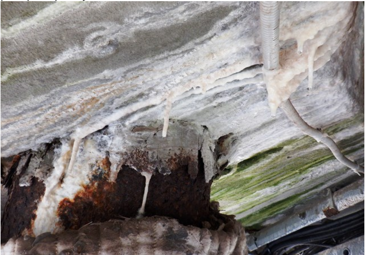
R 1 – skersiniai ir išilginiai įtrūkiai armatūros apsauginiame betono sluoksnyje
