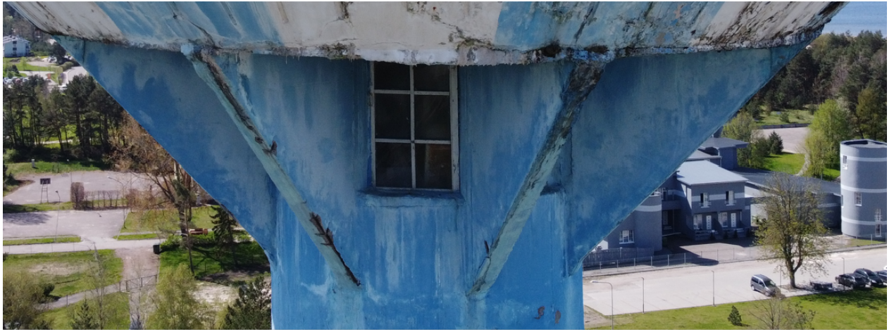
Laikančiųjų atramų apsauginio betono sluoksnio erozija (2024 m.)
