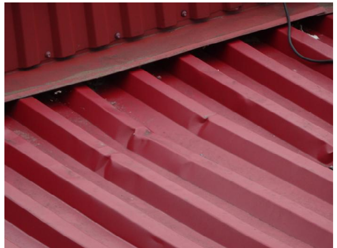
76. Deformuota stogelio skardos danga
