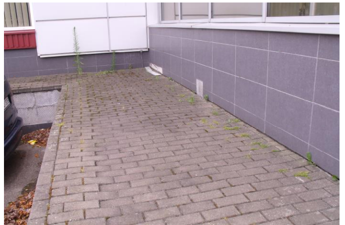
48. Nuogrinda nelygi, susidėvėjusi. Taip pat matomos nukritusios apdailinės laiptų aikštelės plytelės.
