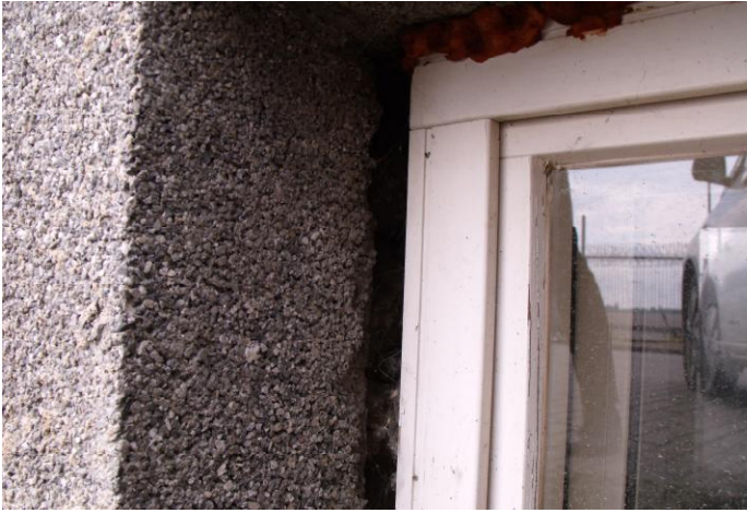
26 pav. Ties rūšio langu atsiradęs plyšys.
