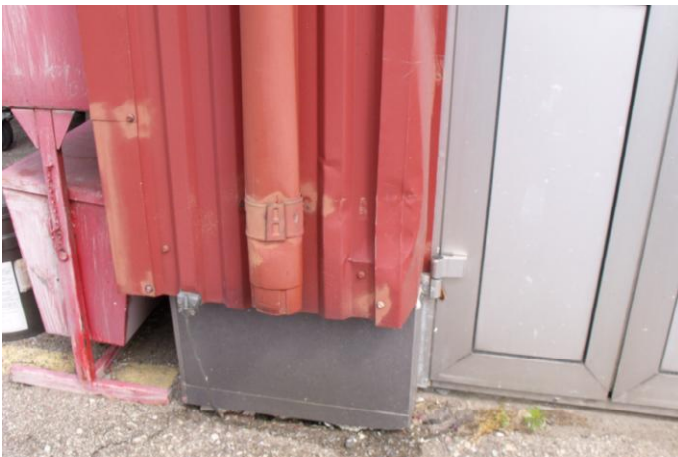
19 pav. Pastato fasado profiliuotas lakštas mechaniškai pažeistas. Surinktas vanduo nuo stogo nuvedamas ties pamatais.
