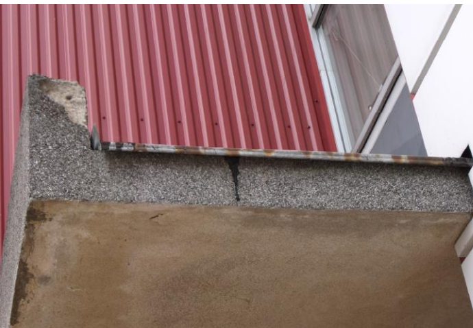
21. Stogelio virš laiptinės parapeto tinkas nukritęs, apskardinimo detalės paveiktos korozijos.
