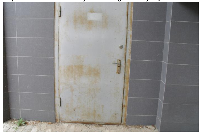
25 pav. Metalinės durys pažeistos korozijos.
