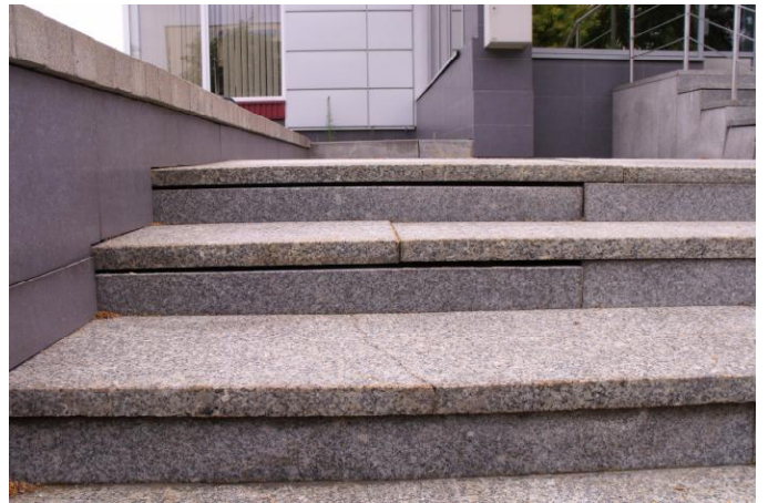
46. Paradiniuose laiptuose atsiradę plyšiai tarp laiptų apdailinių plokščių.
