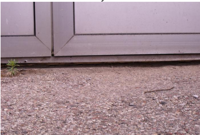
24 pav. Atsiradęs tarpas ties durų apačia per kurį vyksta šilumos mainai.
