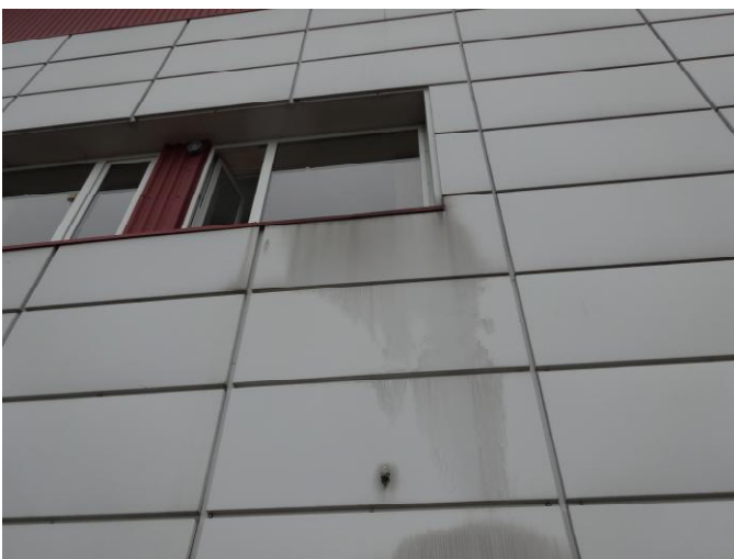
71. Dėl per mažo palangės išsikišimo drėkinamos fasadinė plokštės
