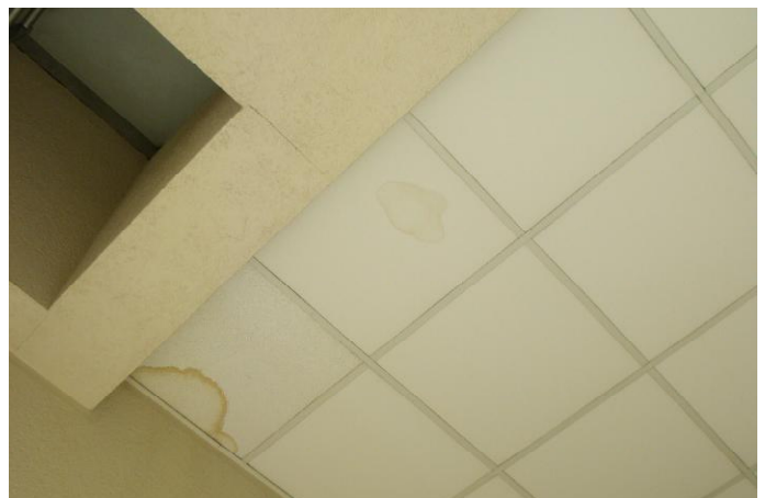
60. Užfiksuota drėgmės pažeista pakabinamų lubų plokštė.
