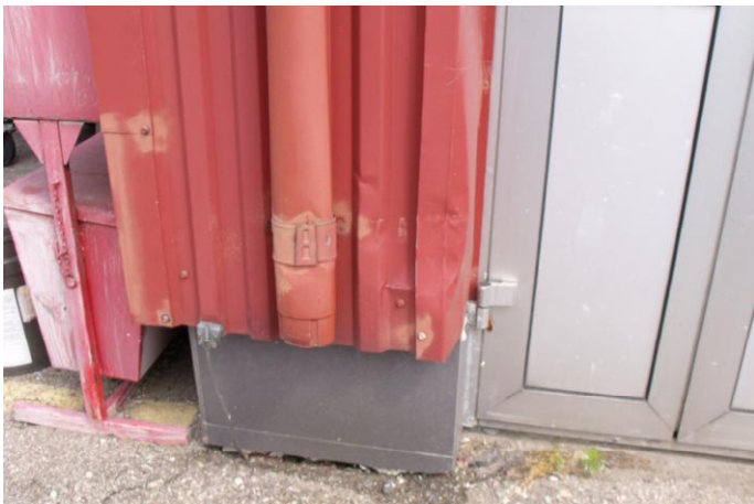
31. Pastato fasado profiliuotas lakštas mechaniškai pažeistas. Surinktas vanduo nuo stogo nuvedamas ties pamatais.
