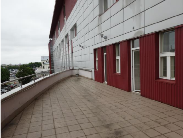
67 pav. Pastato terasos paviršiuje užsistovi vanduo, reikalingas nuolydžių užtikrinimas.
