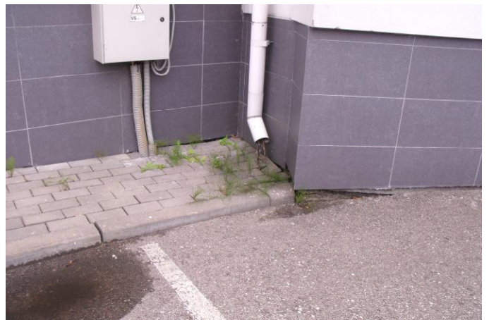
6 pav. Vanduo nuo stogo nuvedamas ties pamatais ir šalia elektros įvado. Nuogrinda nusėdusi.
