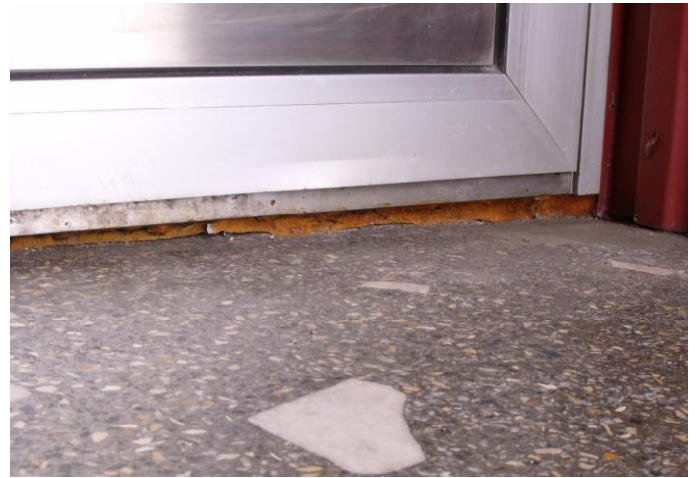
23 pav. Montažinės putos ties durų anga apačia praradusios savo savybes – lengvai subyra į dulkes.
