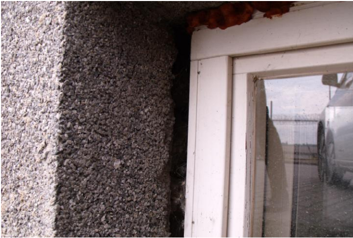
13. Ties rūsio langu atsiradęs plyšys.
