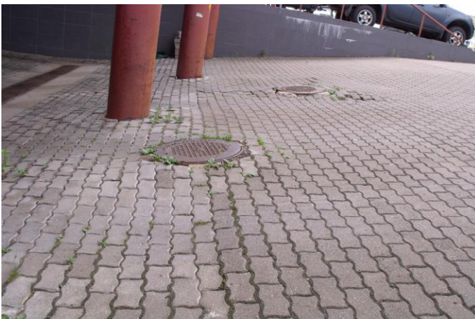
9 pav. Nuovaža, esanti vakarinėje pastato dalyje, vietomis nusėdusi, betoninių trinkelių danga iškilnota.
