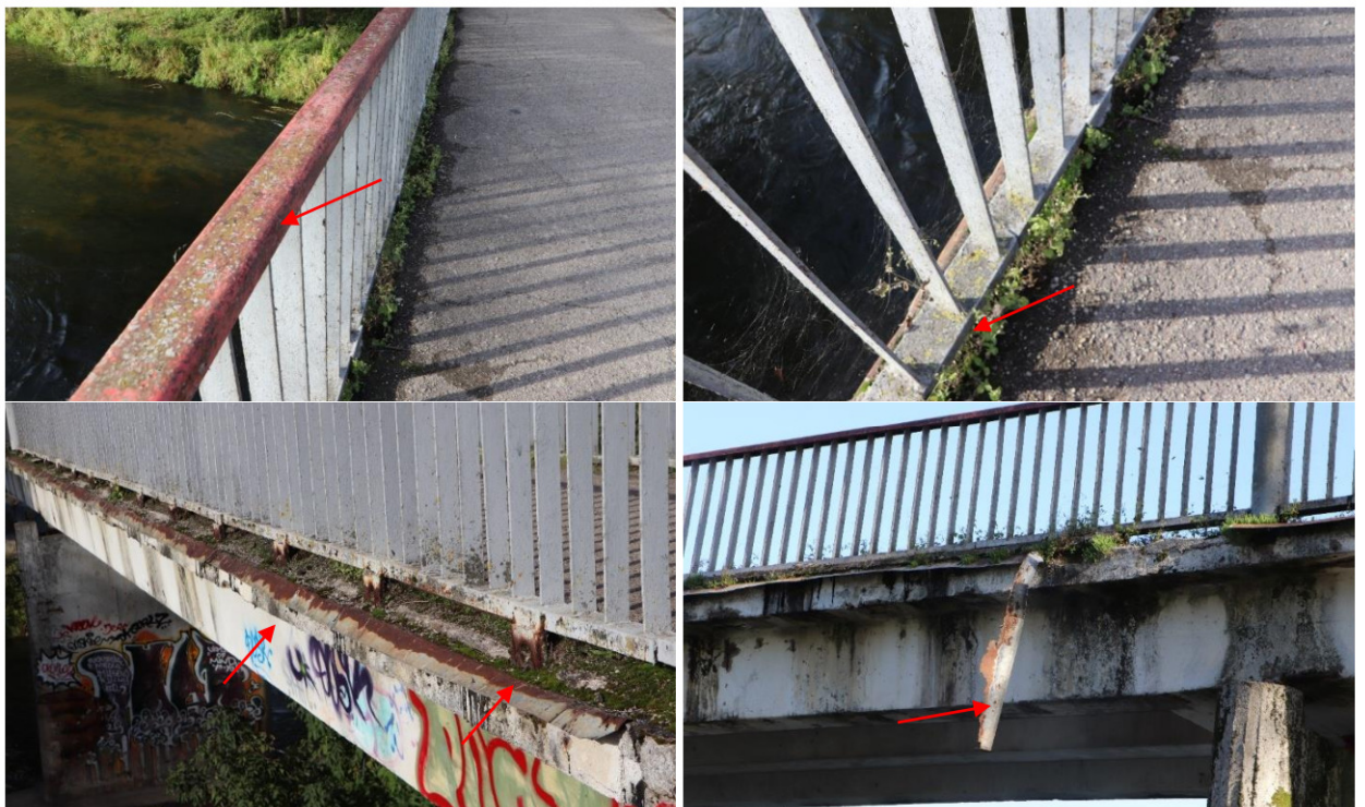
19 pav. Turėklų defektai: apsamoję paviršiai (viršuje), sukorodavę turėklų tvirtinimo elementai ir pakloto plokščių kraštus apsauganti plieninė skarda (apačioje kairėje), pažeistas skardos elementas (apačioje dešinėje)
