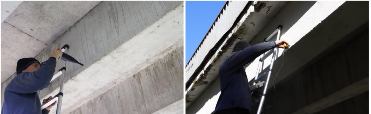
9 pav. Tilto laikančiųjų konstrukcijų betono gniuždomojo stiprio tyrimai neardančiuoju būdu (kairėje) ir plyšių pločių matavimas (dešinėje)
