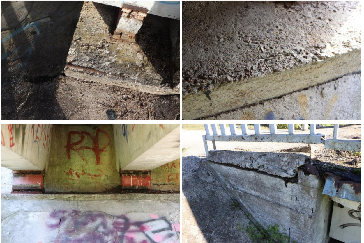
27 pav. Ramtų defektai: porėti rygelių viršutiniai paviršiai, apsauginio sluoksnio pažaidos, prasidėjusi armatūros korozija, supleišę paviršiai, nešvarumai ant rygelių, atsiskyrę gelžbetoniniai elementai atramos 8 žemupio pusėje (apačioje dešinėje)
