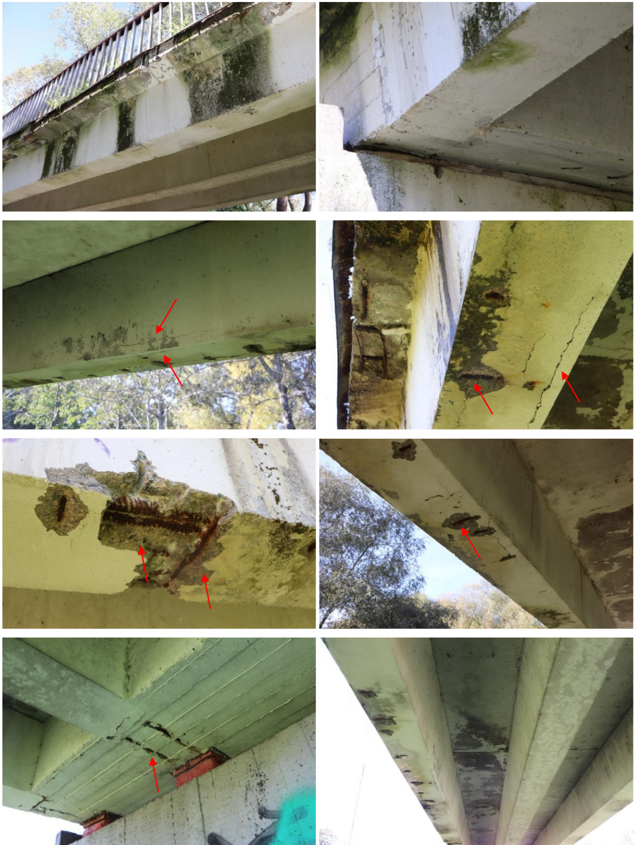
21 pav. Gelžbetoninių perdangos sijų defektai: drėkinami sijų paviršiai, betono ir armatūros korozija, armatūros korozijos sukelti išilginiai plyšiai, apsauginio sluoksnio defektai ir nuoskėlos lokaliuose zonose, prasidėjusi išilginės ir skersinės armatūros korozija
