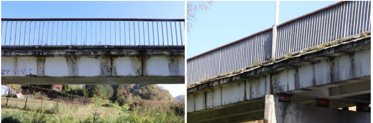
17 pav. Dėl blogos hidroizoliacijos perdangos kraštinių sijų išoriniuose paviršiuose matomos vandens pratakos bei jų sukelta betono ir armatūros korozija
