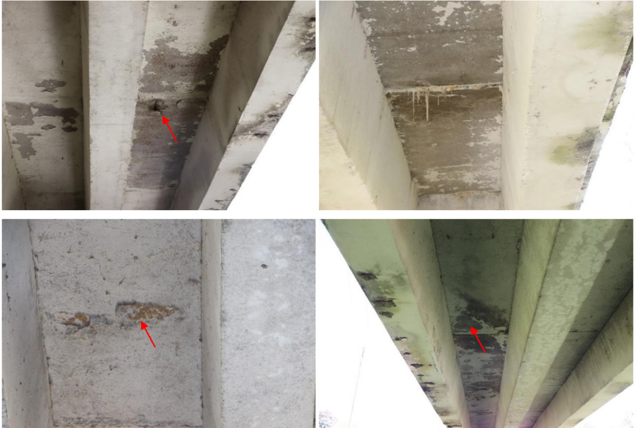
25 pav. Gelžbetoninių paklotą laikančių plokščių lokalūs defektai ir pažeidos ruožuose tarp pagrindinių sijų
