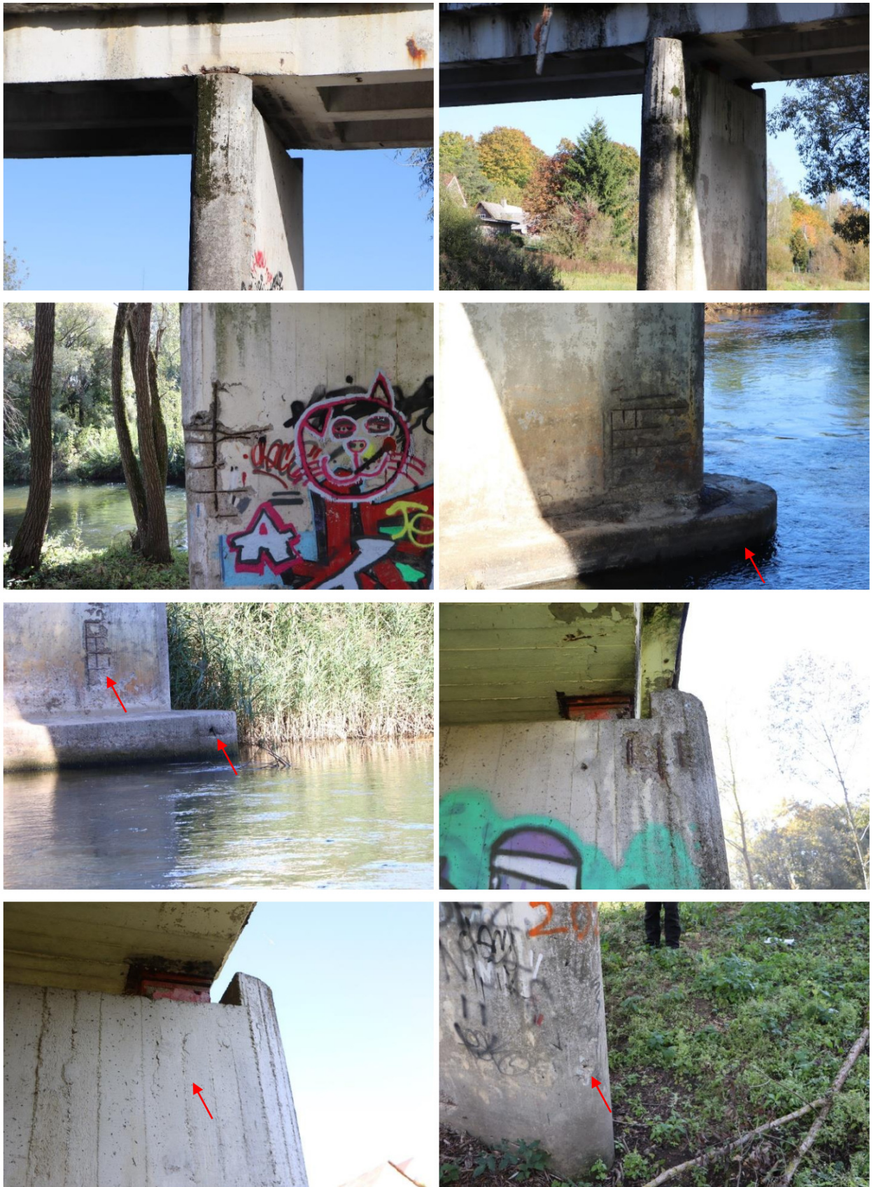
28 pav. Taurų defektai: drėkinami ir koroduojantys betono paviršiai, apsauginio sluoksnio defektai, armatūros korozija, korozijos sukelti išilginiai plyšiai, lokalūs mechaniniai pažeidimai
