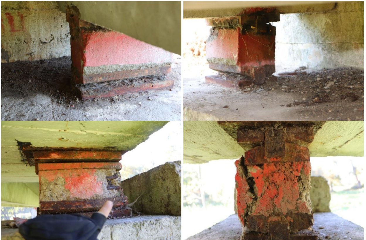
26 pav. Paslankių atraminių guolių defektai: nesutepti ar nešvarumais apsinešę kontaktiniai paviršiai, netinkamai sureguliuoti guoliai, pažeisti guolių armuoto betono užpildai
