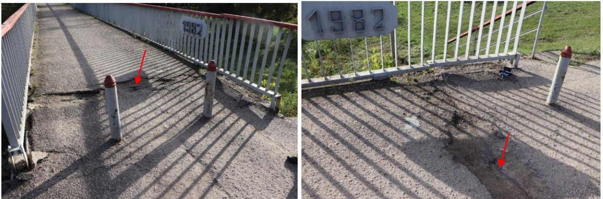
18 pav. Susidėvėję ir nefunkcionuojantys pakloto deformaciniai pjūviai
