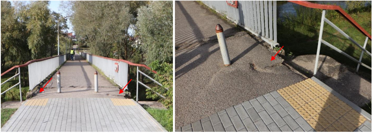
20 pav. Deformuota tako danga prietiltyje ties ramtu 1
