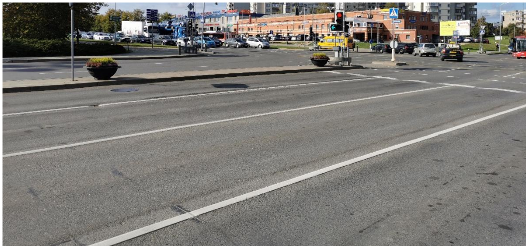
10 pav. Gelvonų gatvės netolygi danga, su įtrūkimais
