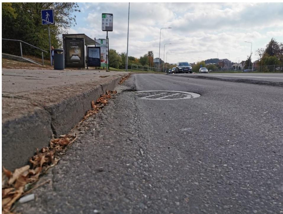
8 pav. Ukmergės gatvės dangos nelygumai
