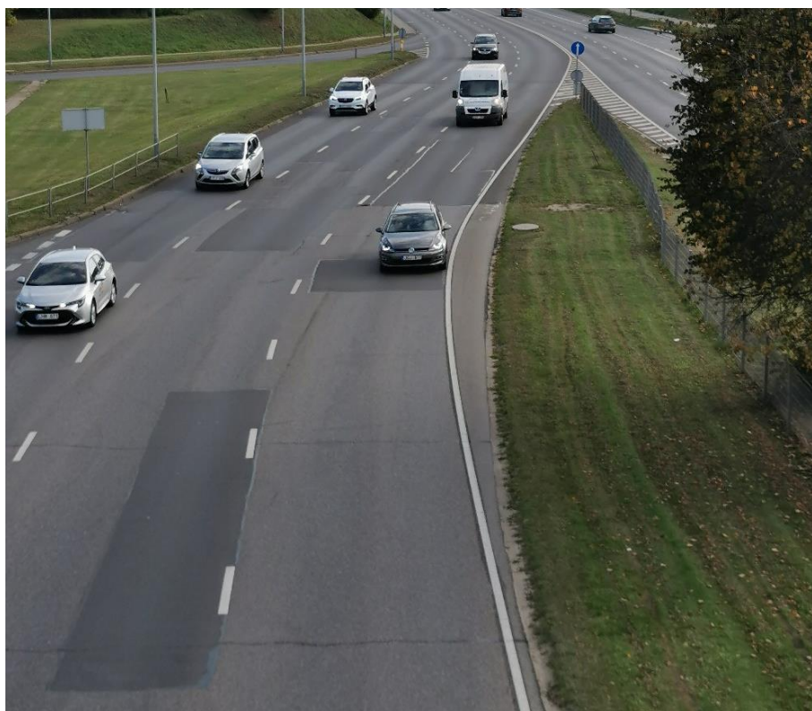
9 pav. Ukmergės gatvės dangos taisymai, įtrūkimai, nelygumai
