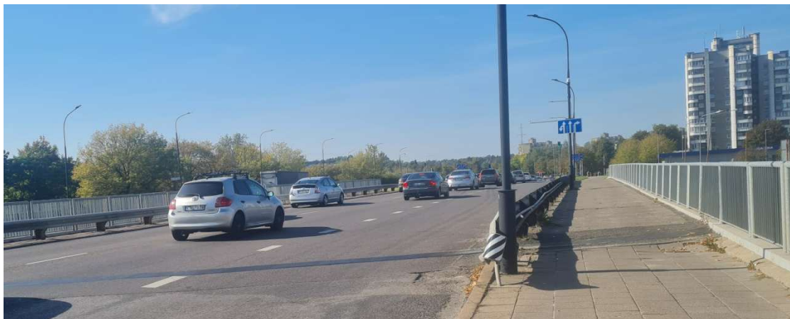
2.1 pav. Ozo g. viaduko šiaurinės pusės pakloto būklė
