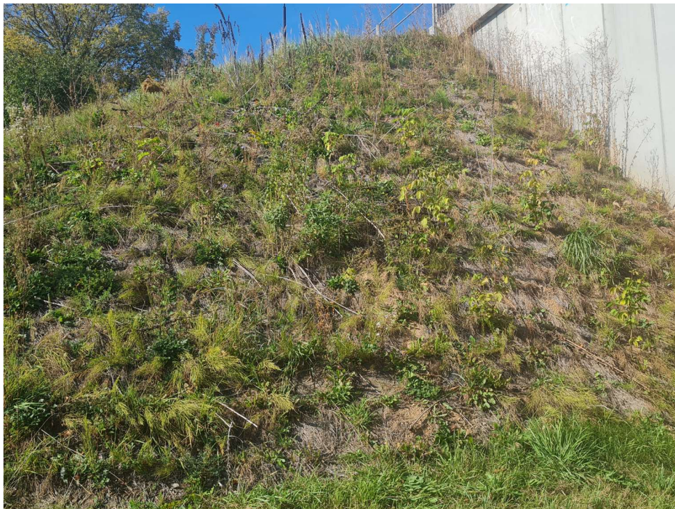
2.5 pav. Ozo g. viaduko kūgių šlaitų tvirtinimų būklė
