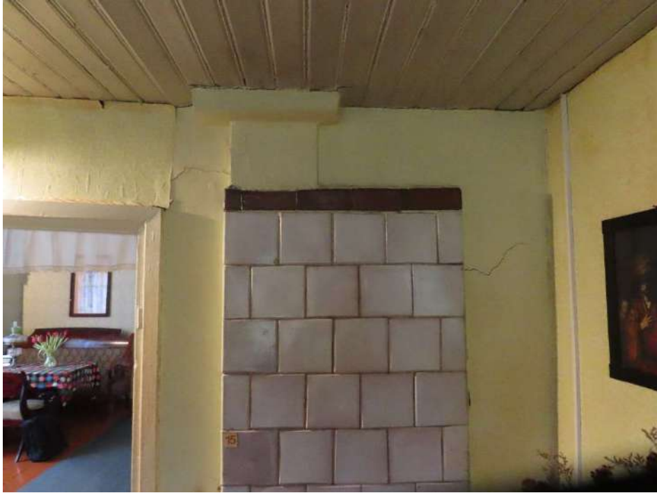
7. Mūrīnēs 0,5 plytās storio sienas mūrē atsivērē horizontālūs įtrūkimai.
