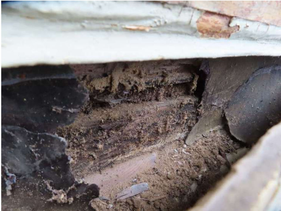
16. Sodybos name po dailylentėmis įrengtas ruberoido sluoksnis neleidžia sienojų medienai kvėpuoti, tarp sienojų ir ruberoido sluoksnio kaupiasi drėgmė, taip pažeisdama medines sienų konstrukcijas.
