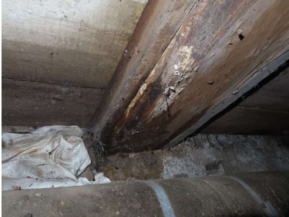
19. Rūsio perdangos medinių sijų galai įrengti be hidroizoliacijos sluoksnio, sijų galai drėgni ir pažeisti puvinio.
