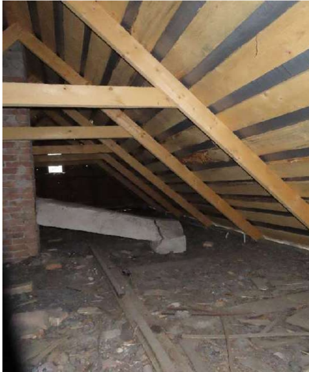
10. Sodybos muzikos namo stogo laikančios gegnės 145(h)x50 mm išdėstytos ~1,4 m žingsniu. stogas įrengtas konstrukcijos fragmentas.
