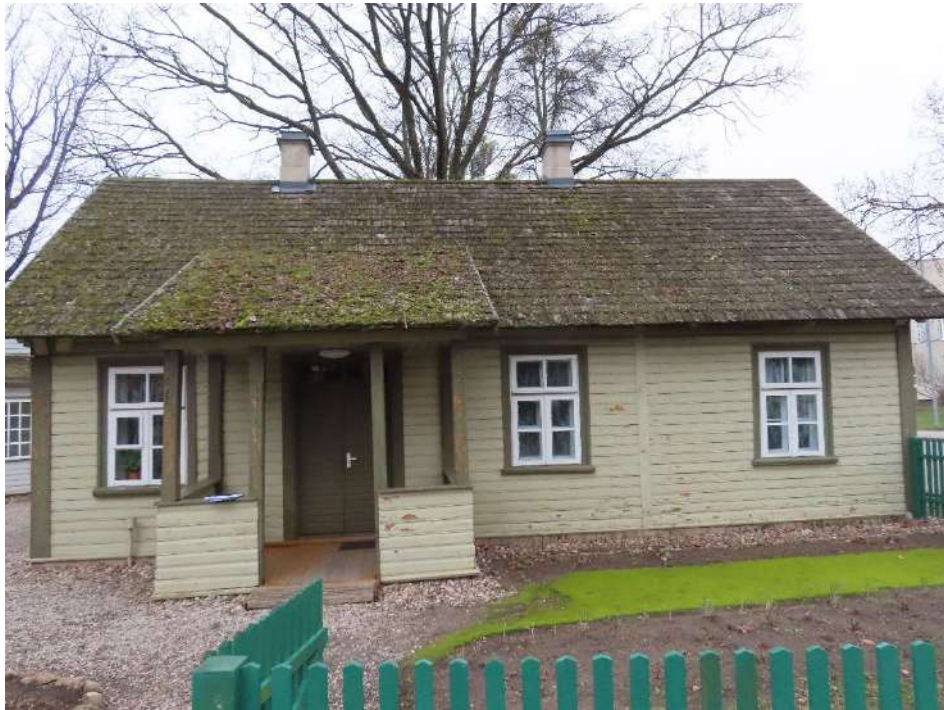
14. Mikalojaus Konstantino Čiurlionio sodybos namo rytinės pusės fasadas. Fasadai apkalti medinėmis dailylentėmis, dažai vietomis atsiluksniavę.
