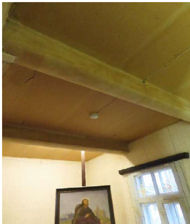
20. Aukšto perdanga medinių perdangos sijų 190(h)x150 mm išdėstytų ~1,4÷1,5 m žingsniu.
