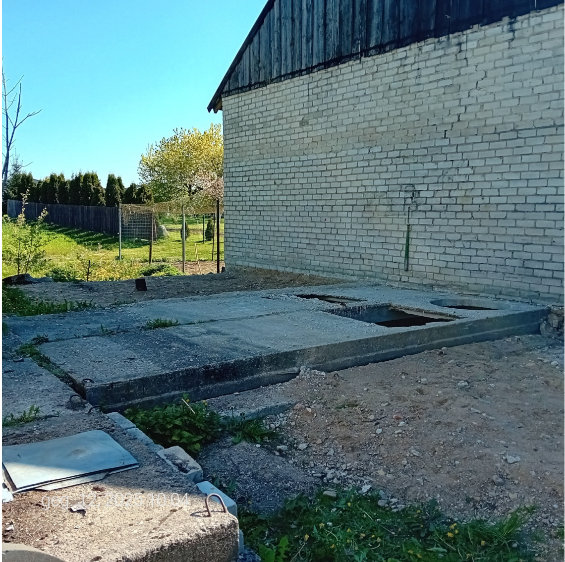
2025-05-12 Patikrinimo metu nustatyta, kad liko neišardytos pastato, kurio matmenys buvo: ilgis 10,50 m, plotis 4,15 m., betoninių pamatų dalys ir rūsiai, bei nesutvarkyta statybvietė.
