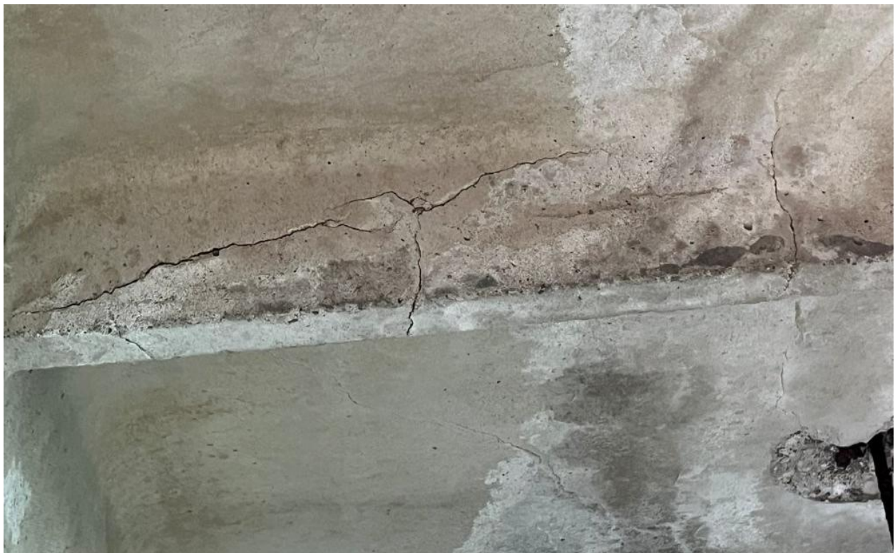
7 pav. Skersinėse denginio plokščių briaunose apsauginis betono sluoksnis suaižėjęs
