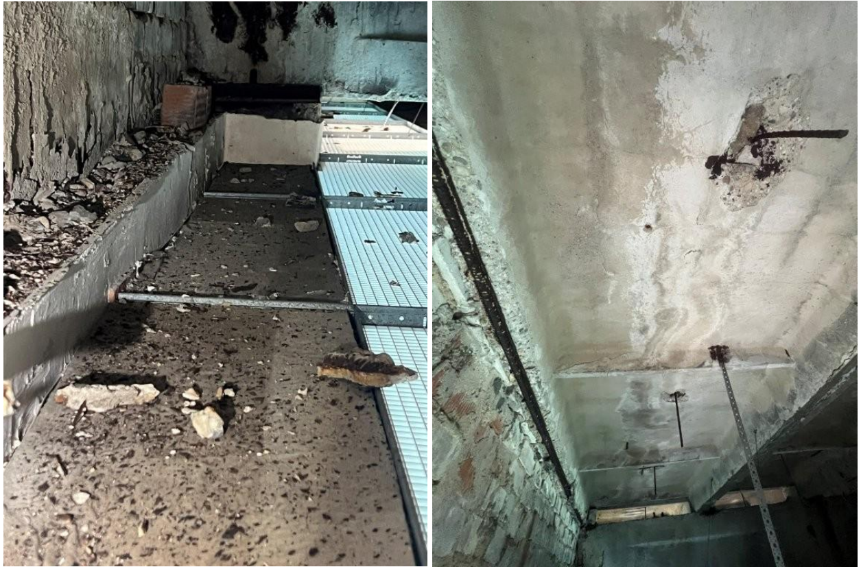
5, 6 pav. Atšokęs apsauginis betono sluoksnis, pavieniai jo trupiniai nukritę ant pakabinamų lubų.
