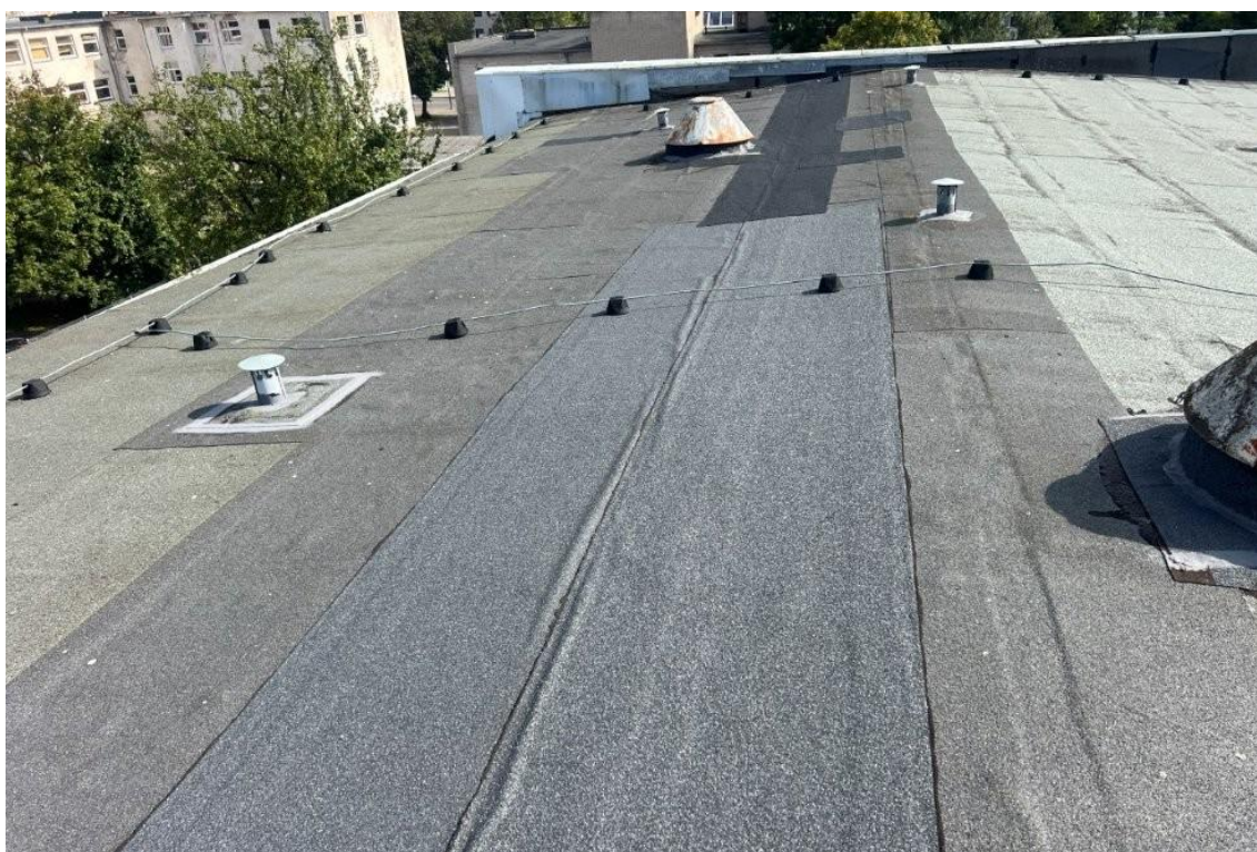
15 pav. Stogo dangos būklės fotografacija
