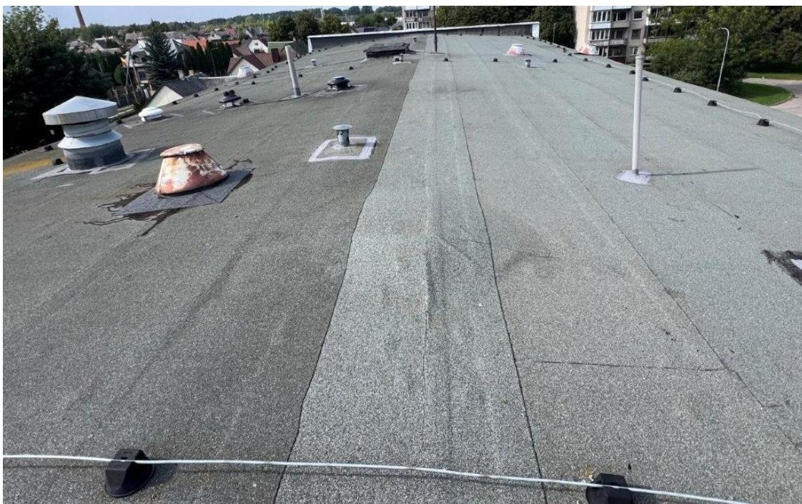
14 pav. Stogo dangos būklės fotografacija
