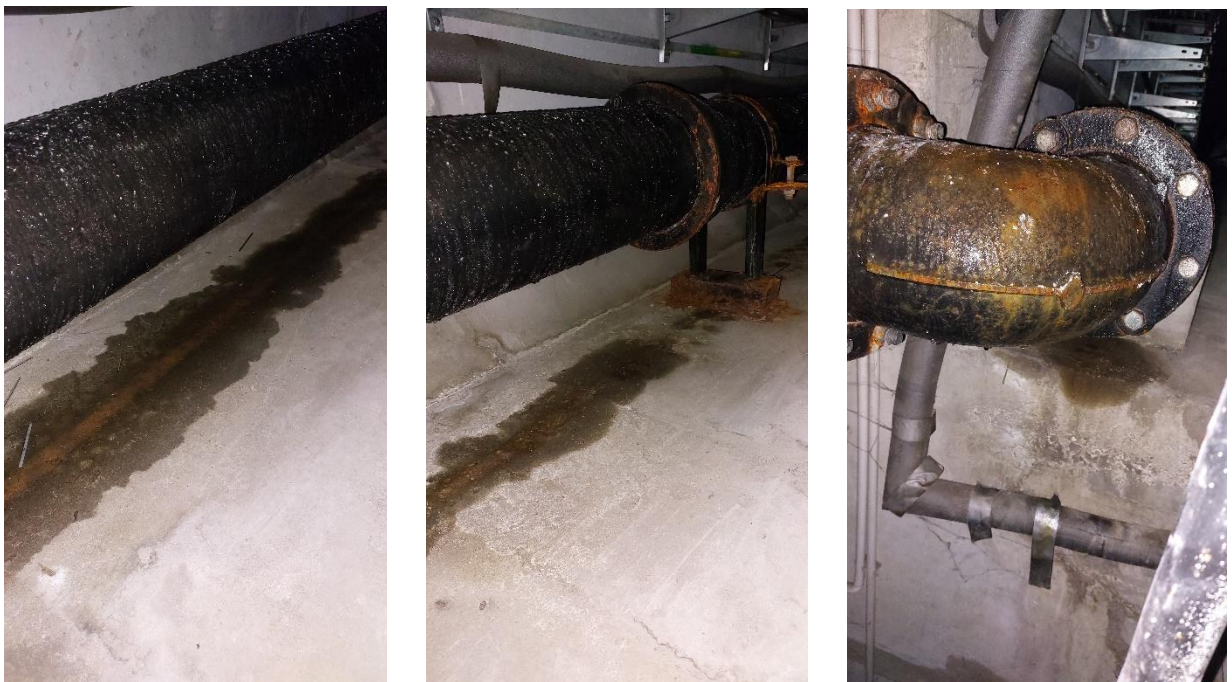
2.24 pav. Korpusas B. Kondensatas ant vamzdžių kolektoriuose
