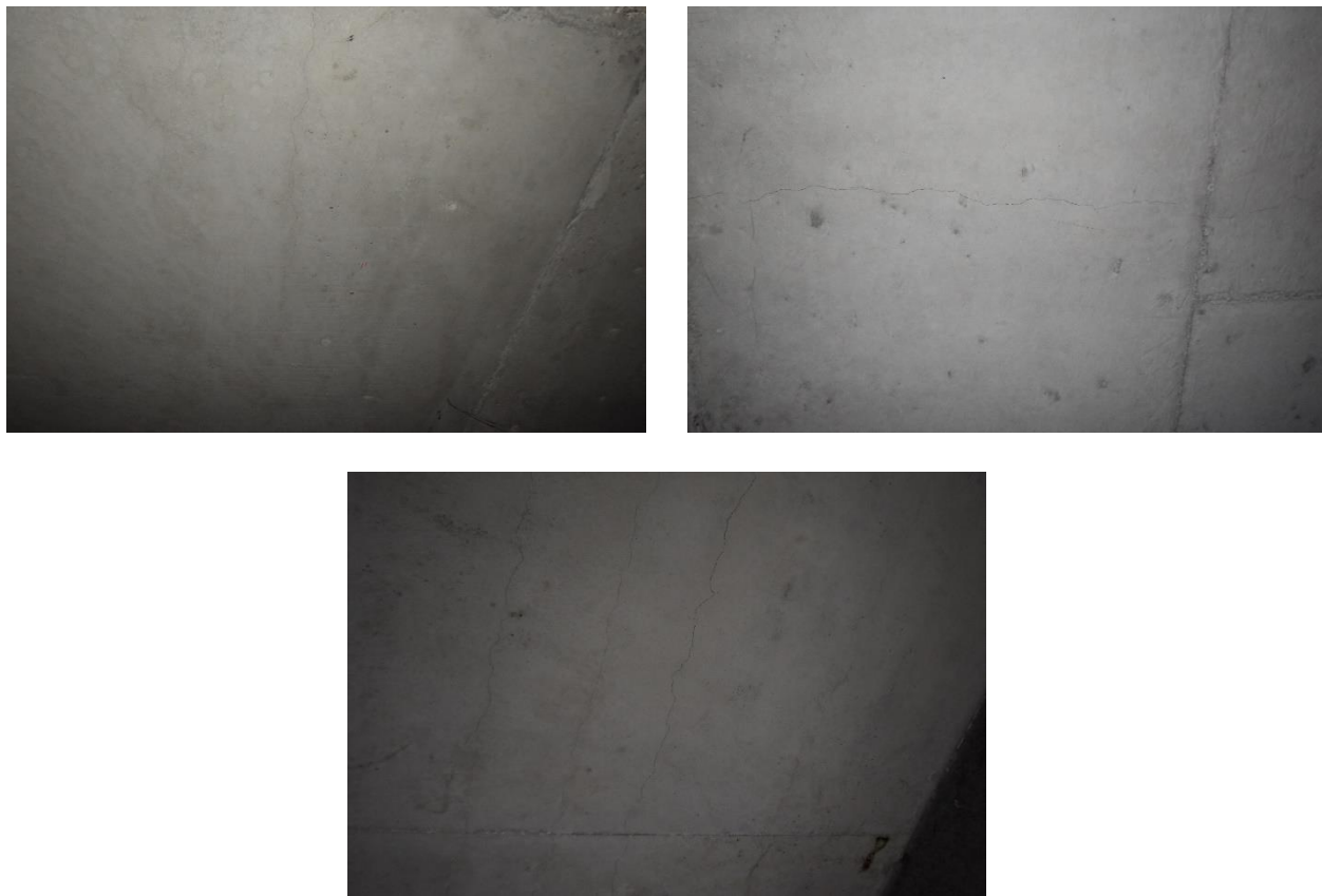
2.13 pav. Korpusas A. Plokščių pleišėjimas
