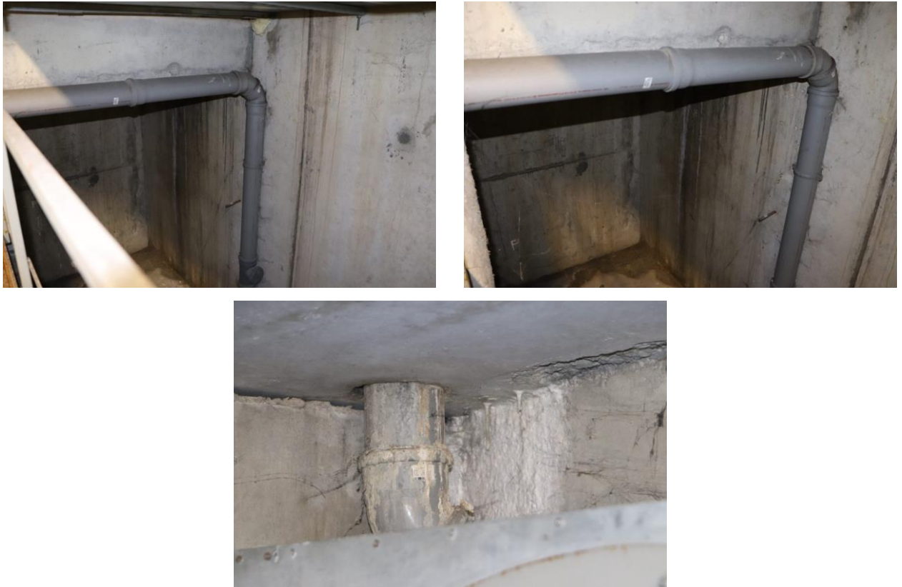
2.50 pav. Vandens pratekėjimai pagalbinėse patalpose tarp aš. F-F'/11
