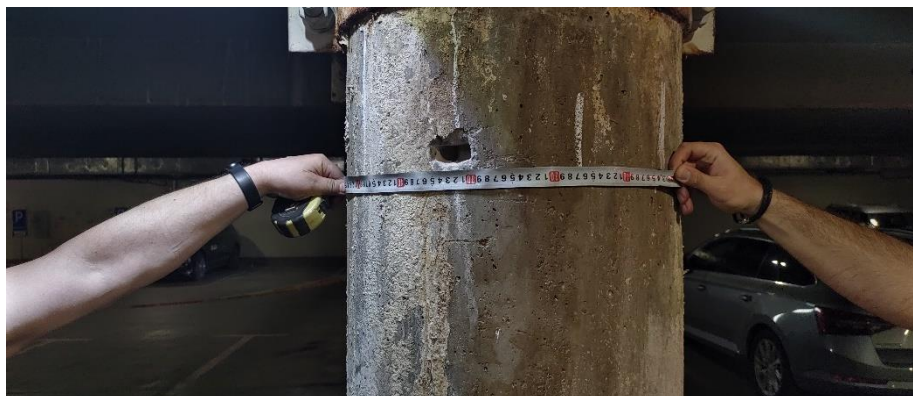
1.9 pav. Kolonos armavimo ir armatūros būklės nustatymas
