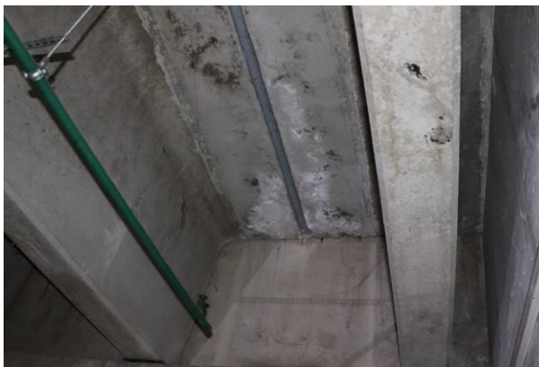
2.29 pav. Korpusas B. Vandens pratekėjimai tarp ašių C-D/12-13
