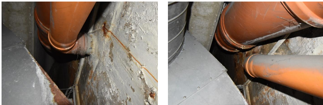
2.25 pav. Korpusas B. Aptekėjusios sienos kontakte su kolektoriumi
