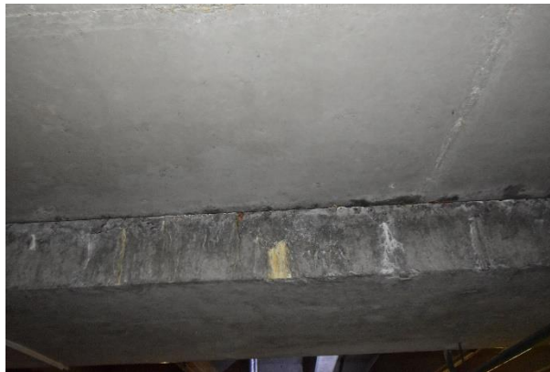
2.17 pav. Korpusas A. Glemžiamame betone susidarę plyšiai
