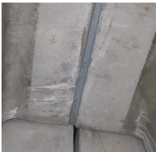
2.31 pav. Korpusas B. Vandens pratekėjimai ir atitrūkusi deformacinė siūlė tarp ašių C-D/17-18
