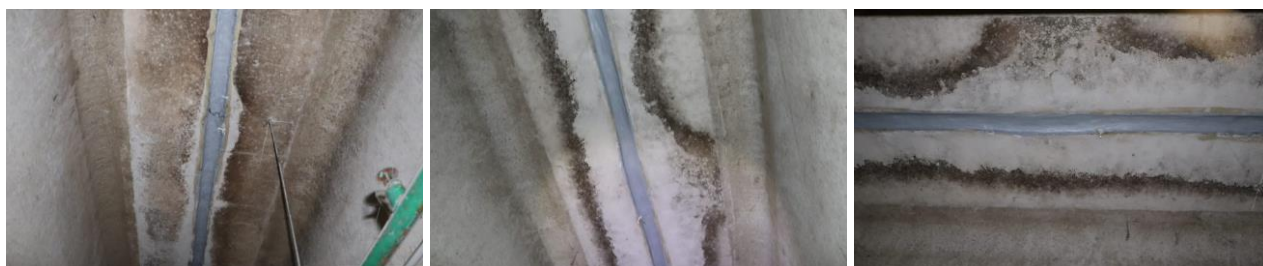
2.41 pav. Korpusas C. Vandens pratekėjimai tarp ašių G-H/34-35
