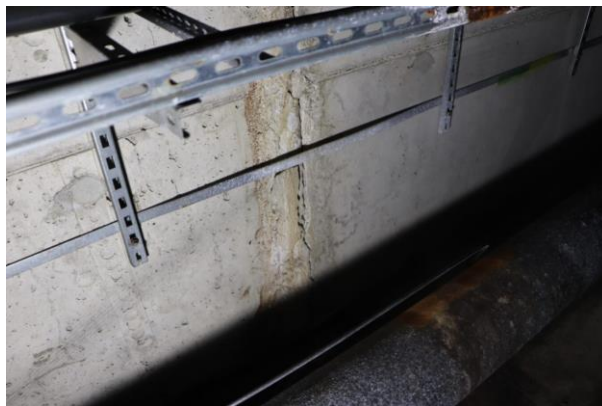
2.48 pav. Vandens pratekėjimai kolektoriuje tarp aš. 1-11/E ties deformacinėmis siūlėmis
