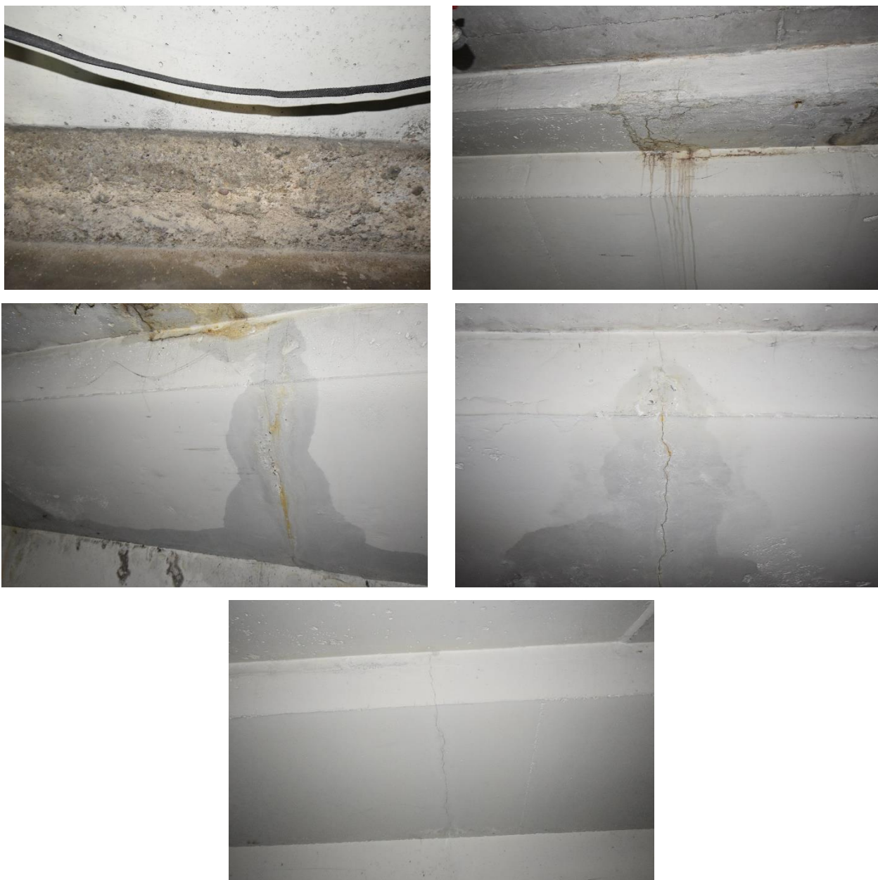
2.22 pav. Korpusas B. Betono korozija ir pratekėjimai per plyšius sienose
