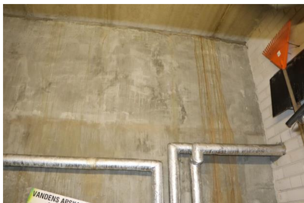
2.49 pav. Vandens pratekėjimai pagalbinėse patalpose tarp aš. 8-9/F-F*
