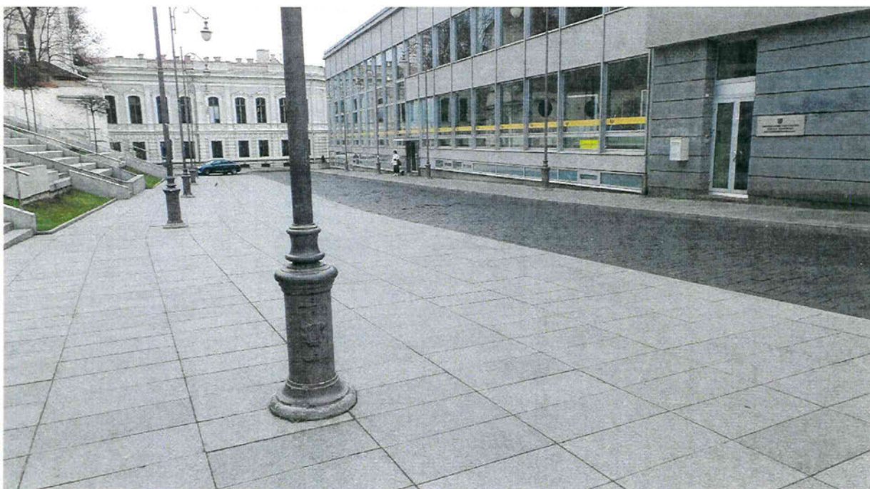
4.21 pav. Apšvietimo stulpas ties vandens pratekėjimo vieta
