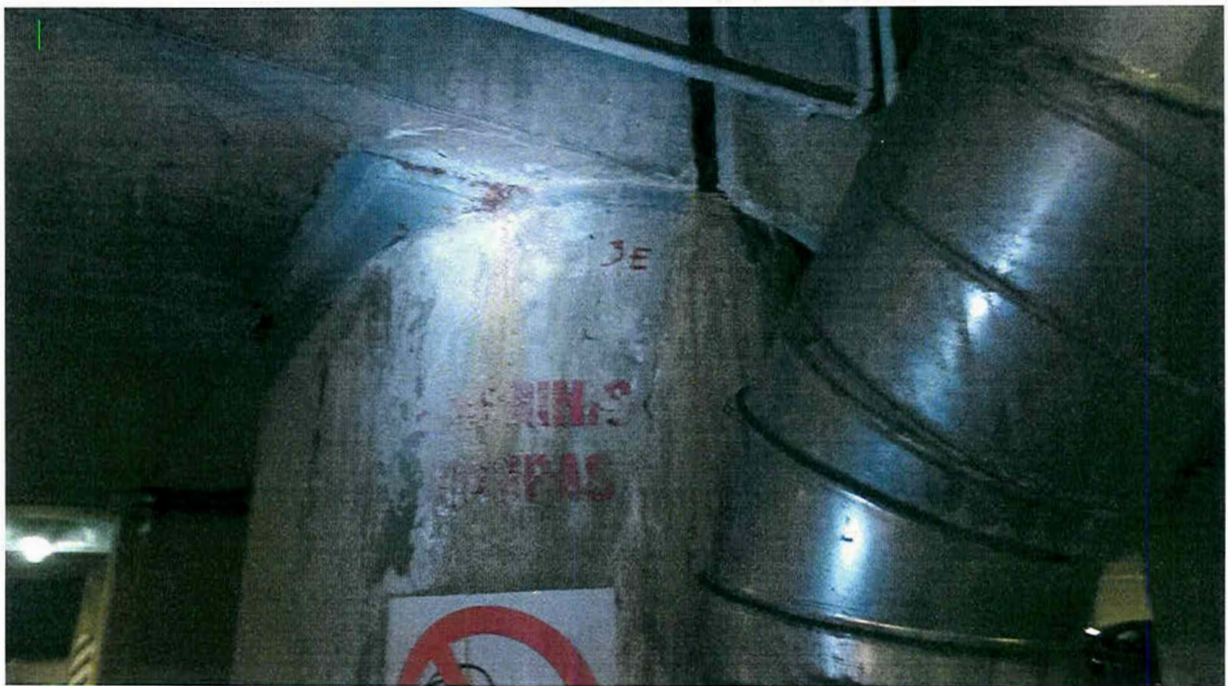
1P.4 pav. A korpuso D3 ašies kolonos viršutinės dalies vaizdas su vertikaliu plyšiu
