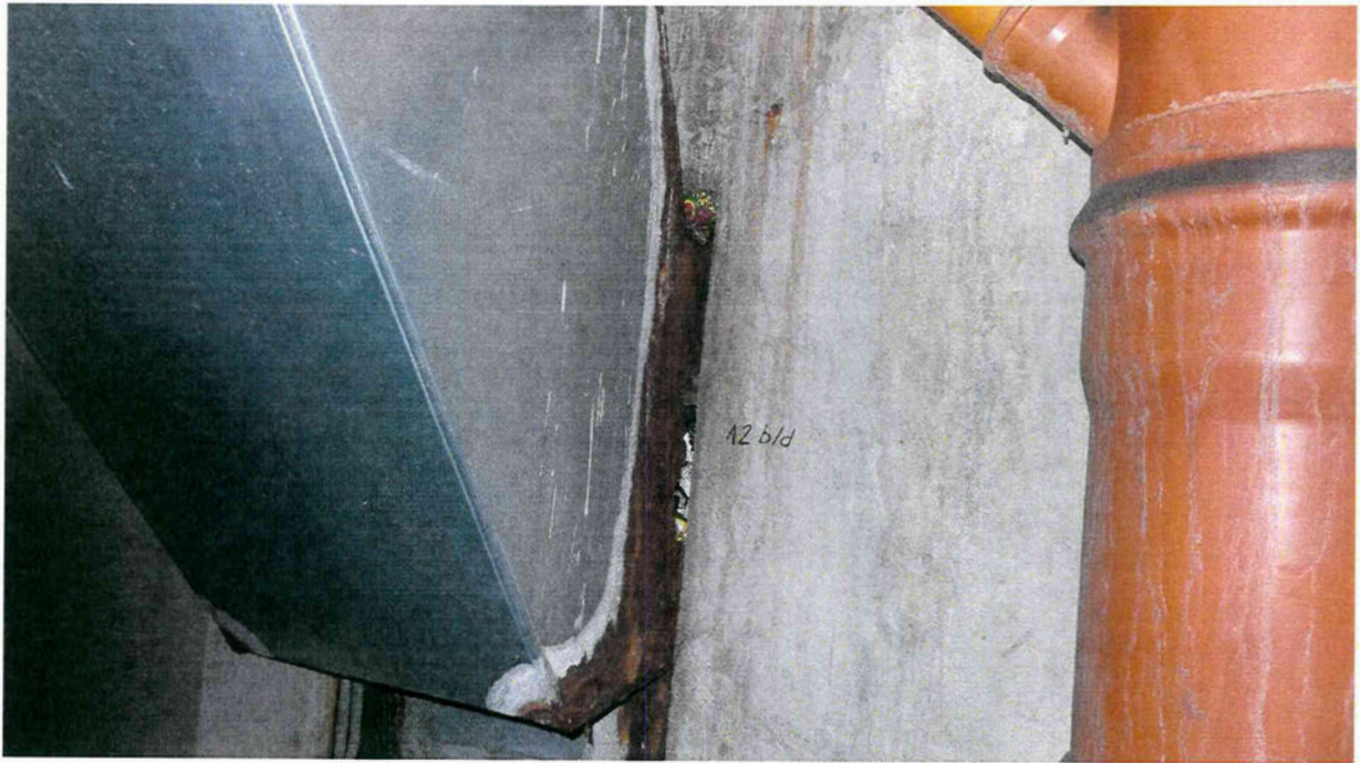
4.12 pav. Vandens pratekėjimas ties ašimis 12-E
