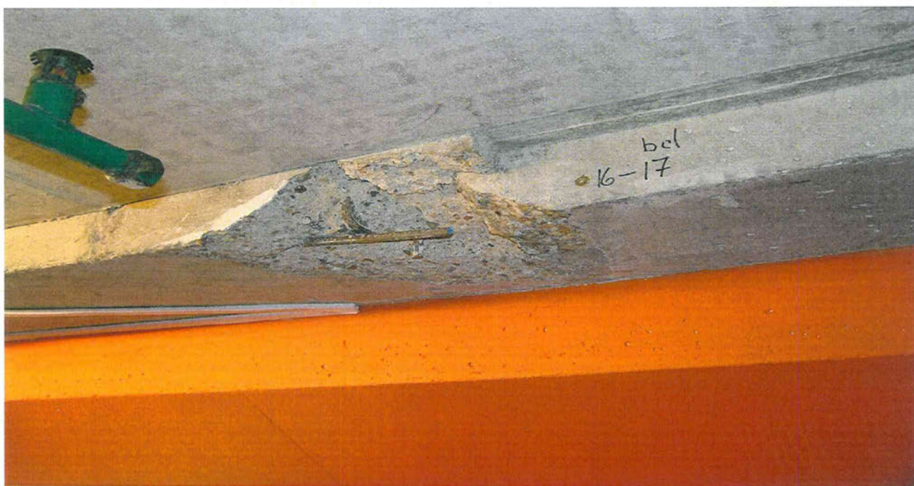
3P.11 pav. Kolektoriaus pažaidos B korpusas.
