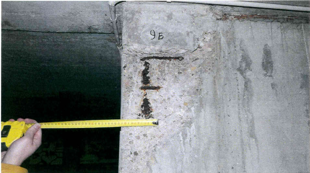
1P.9 pav. A korpuso B9 ašies kolonos viršutinės dalies vaizdas su akivaizdžiais kolonos armatūros korozijos požymiais
