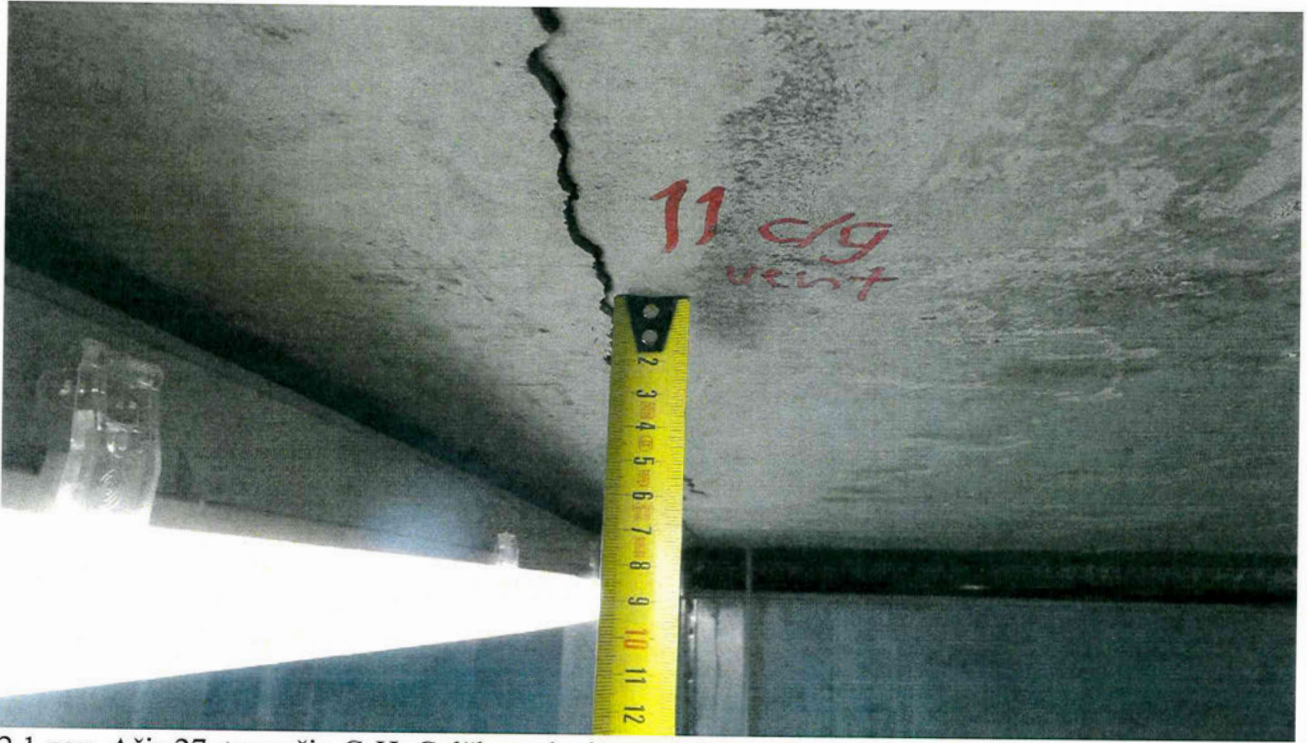
2.1 pav. Ašis 27, tarp ašių G-H. Gelžbetoninėje monolitinėje perdangoje neįrengta deformacinė siūlė. Plyšio vieta sutampa su dalyje denginio tarp surenkamų gelžbetoninių elementų įrengta siūle.
