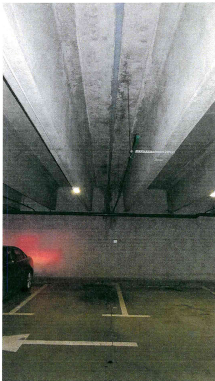
4.19 pav. Ties temperatūrine siūle C korpuse
