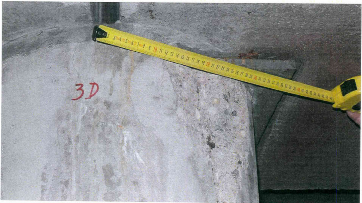
1P.2 pav. A korpuso D3 ašies kolonos viršutinės dalies vaizdas su vertikaliu plyšiu ir atskeltų apsauginiu betono sluoksniu
