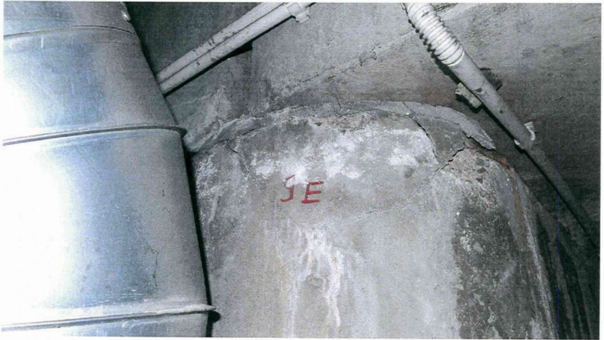
1P.13 pav. A korpuso D9 ašies kolonos viršutinės dalies vaizdas su nuskeltu apsauginiu betono sluoksniu
