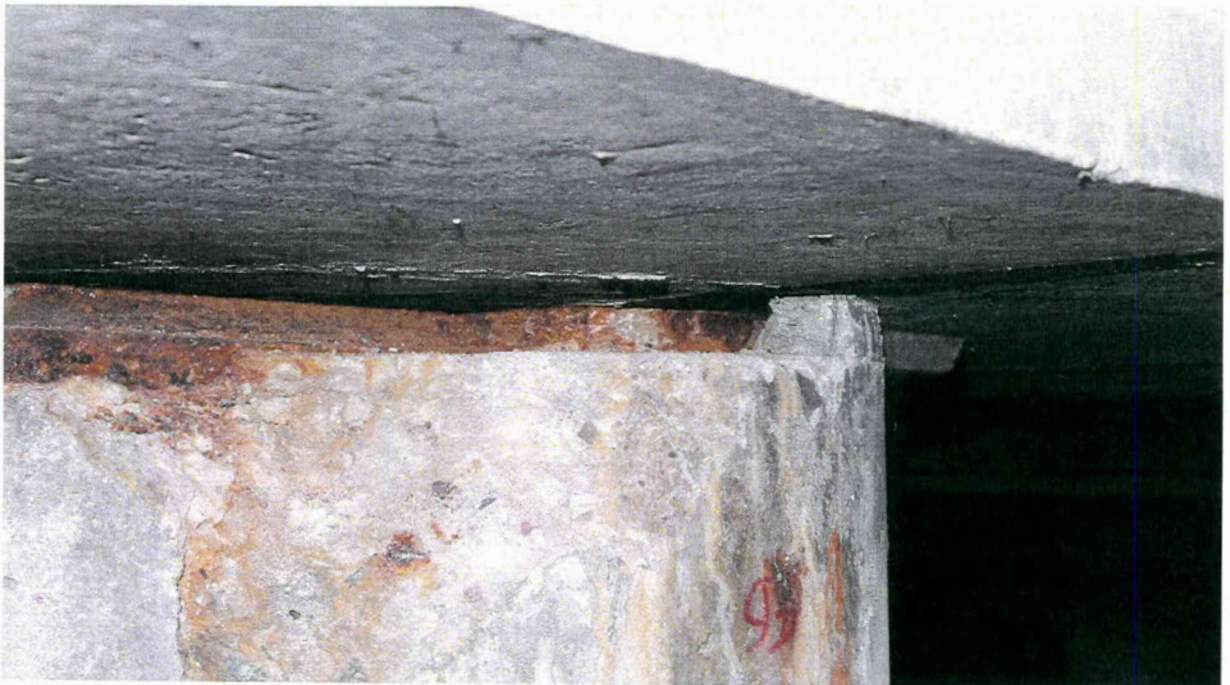
1P.12 pav. A korpuso D9 ašies kolonos viršutinės dalies vaizdas su nuskeltu apsauginiu betono sluoksniu ir aiškiai matomu tarpo tarp kolonos ir sijos užtaisymo būdu – užtaisytas tik apie 20 mm pločio ruoželis, o ne visas plotas per atraminių plokščių aukštį
