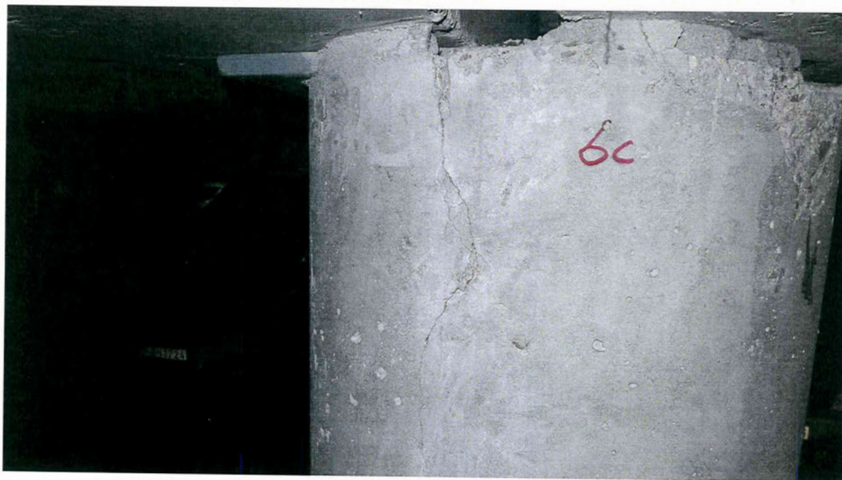
1P.6 pav. A korpuso B6 ašies kolonos viršutinės dalies vaizdas: a) su atskilusiu ir užtaisytu apsauginio betono sluoksnio dalimi; b) stačiuoju plyšiu, aiškiai matomu tarpo tarp kolonos ir sijos kontūriniu užtaisymu ir atskelta apsauginio betono sluoksnio dalimi
