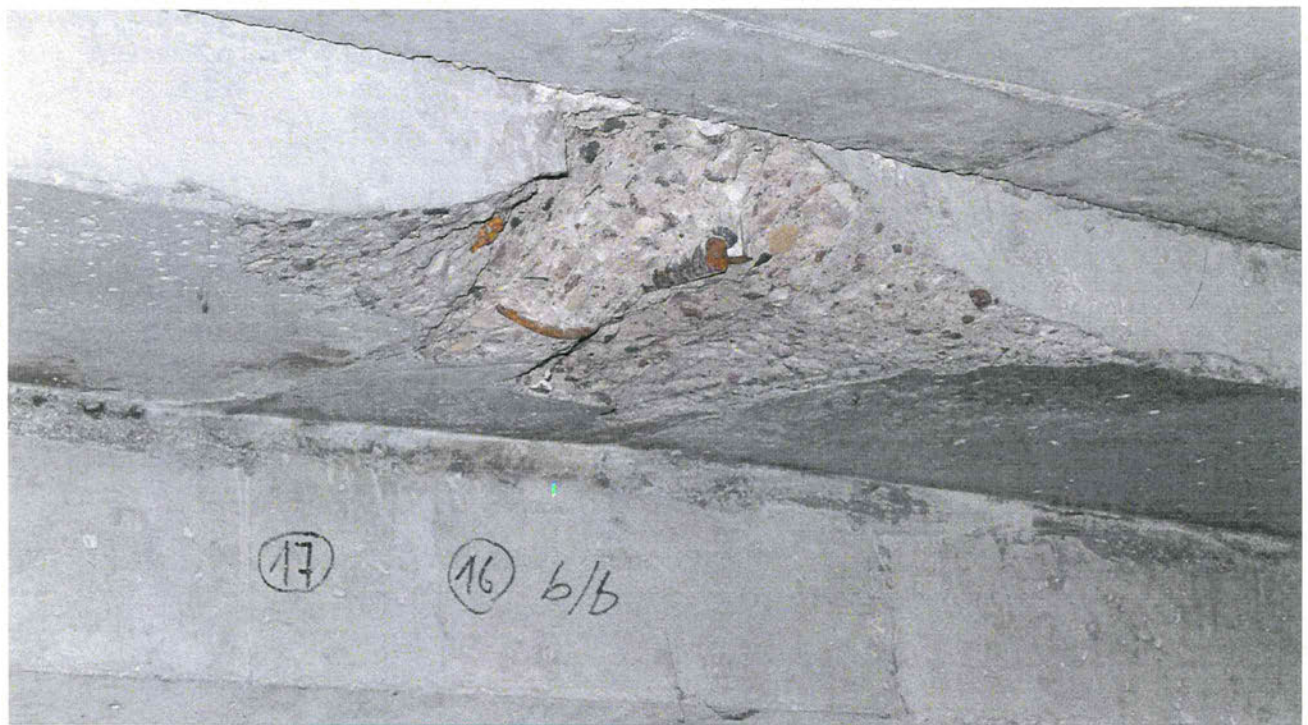
3P.15 pav. Kolektoriaus pažaidos B korpusas.
