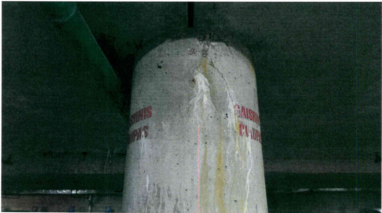
1P.10 pav. A korpuso C9 ašies kolonos viršutinės dalies vaizdas su vertikaliais plyšiais
