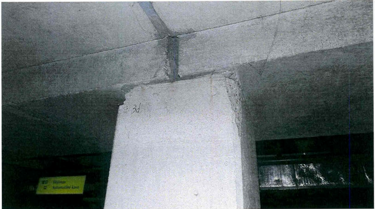
1P.3 pav. A korpuso D3 ašies kolonos viršutinės dalies vaizdas su atskeltais apsauginiu betono sluoksniais kolonos kampuose
