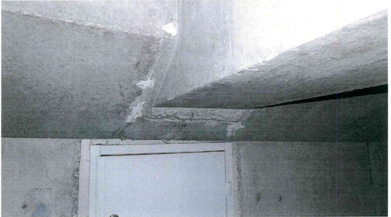
3P.6 pav. Plyšiai sienose tarp surenkamų ir monolitinių gelžbetoninių elementų B korpusas.
