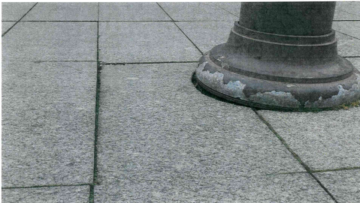
4.20 pav. Apšvietimo stulpas ties vandens pratekėjimo vieta
