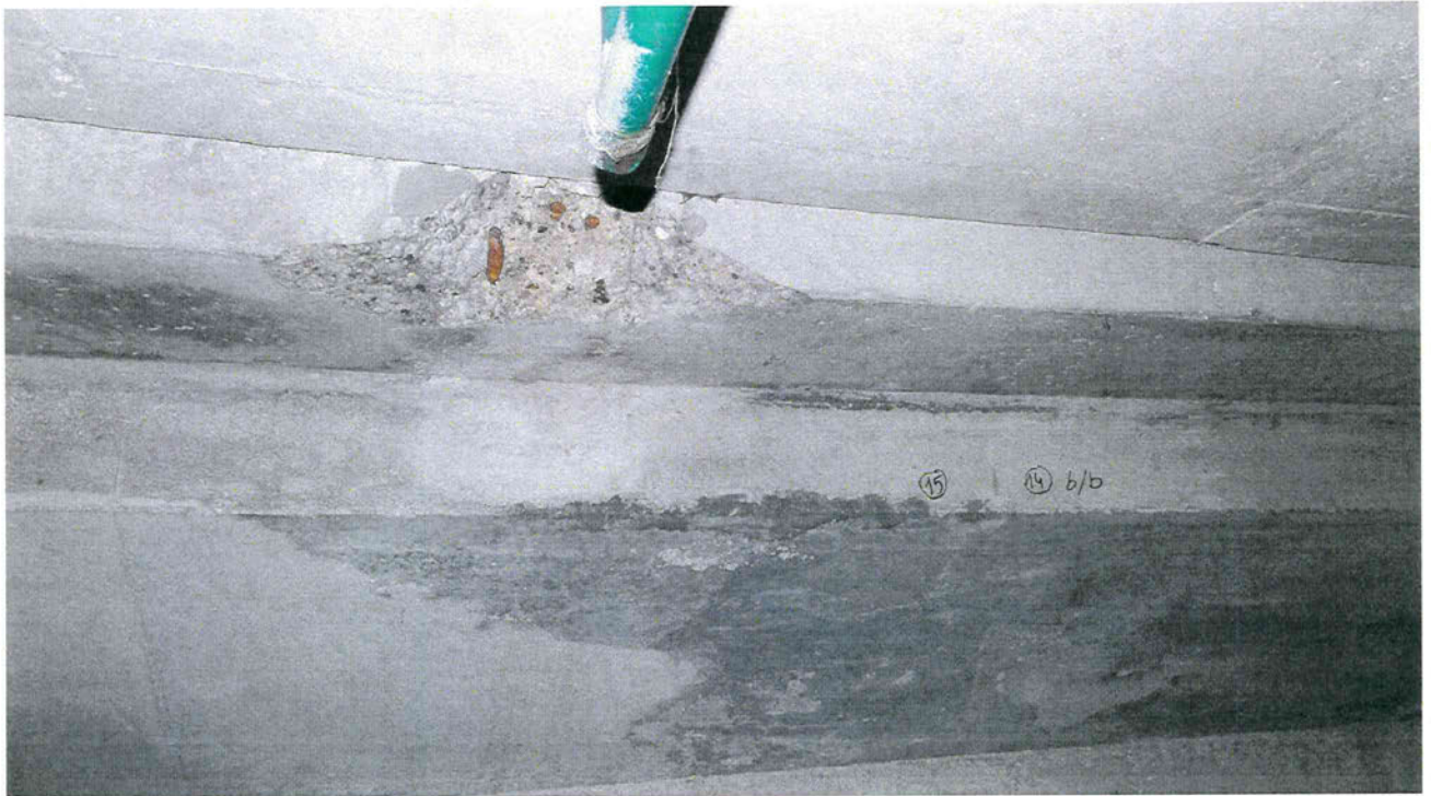
3P.14 pav. Kolektoriaus pažaidos B korpusas.
