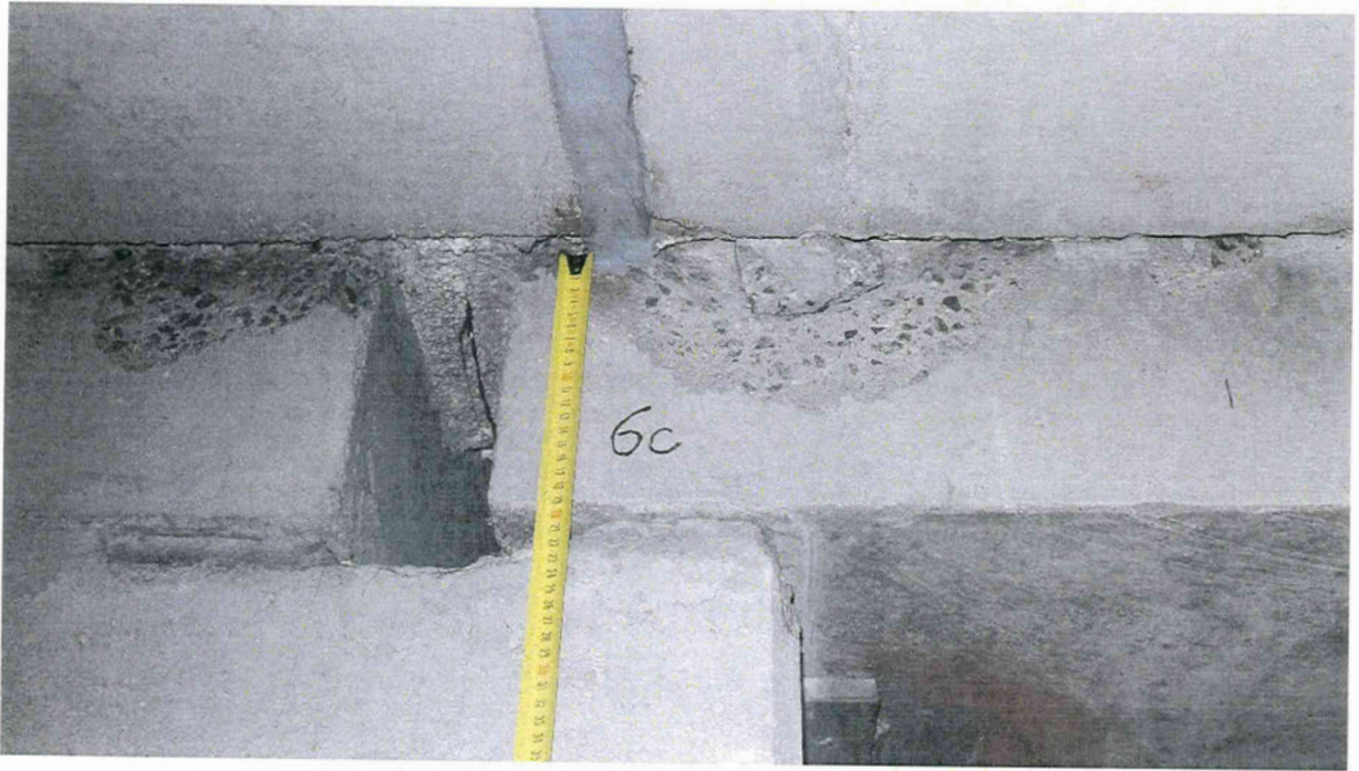
1P.7 pav. A korpuso C6 ašies kolonos viršutinės dalies vaizdas – ne visiškai vietoje įrengtas deformacinis statinio pjūvis ir dėl to nugremžtas išilginės sijos lentynos betonas
