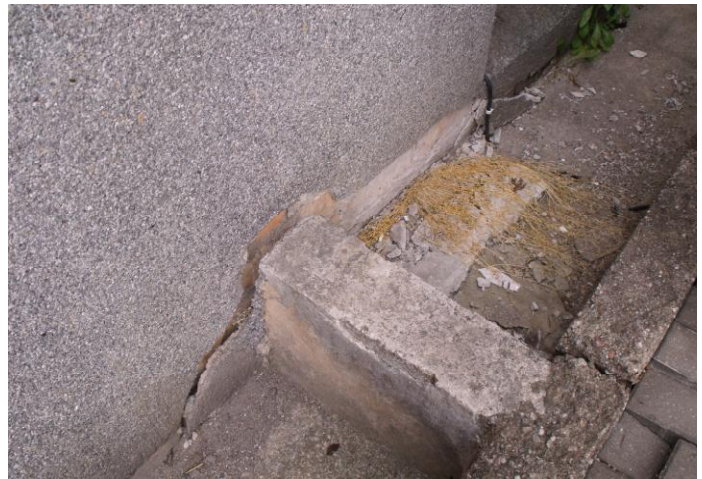
10. Šviesduobėse blogai įrengta drenazinė sistema, vanduo laikosi ir ardo cokolį. Matomas atšokęs cokolio tinkas.
