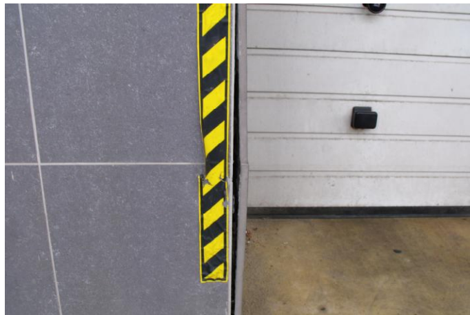
38. Fasado apdailinės plytelės ties garažo įvažiavimu atšokusios.
