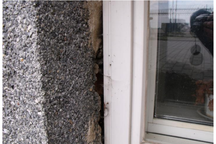
14. Ties rūsio langu atsiradęs plyšys.
