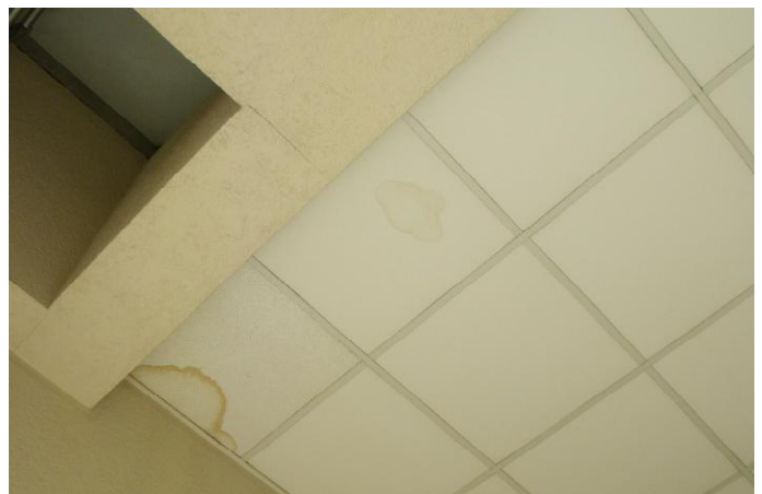
60. Užfiksuota drėgmės pažeista pakabinamų lubų plokštė.
