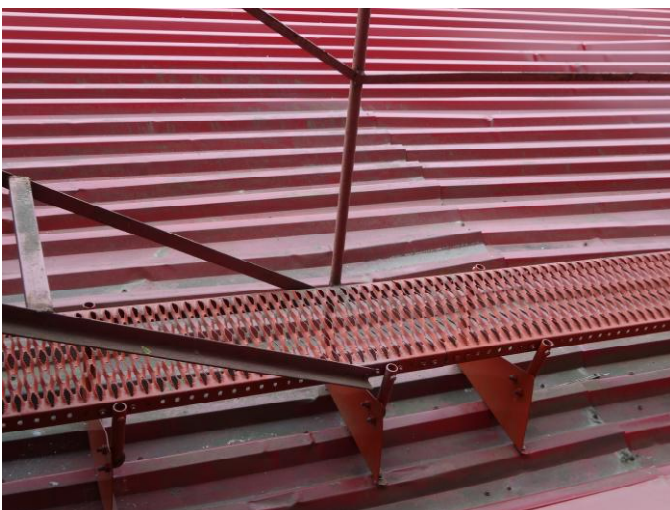
74. Deformuota stogelio skardos danga
