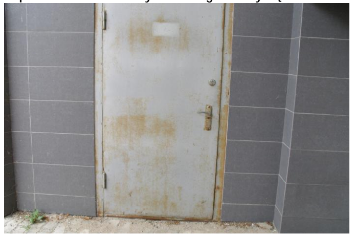
25 pav. Metalinės durys pažeistos korozijos.
