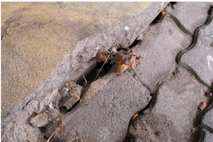
37. Gruntas po nuovaža išplautas, danga nusėdusi, atsiradę plyšiai.
