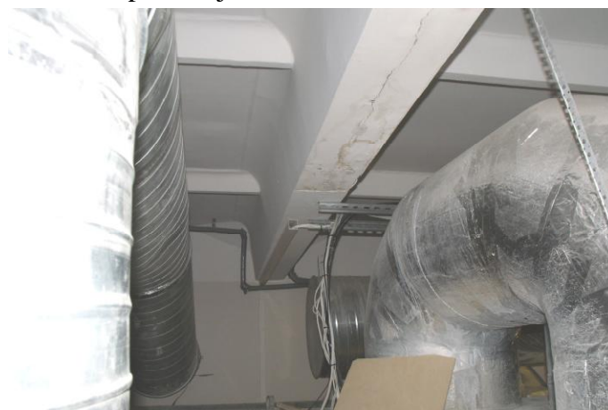
21 pav. Ketvirto aukšto perdanga iš briaunuotų surenkamų perdangos plokščių. Užfiksuoti įtrūkimai ties jų sandūra.
