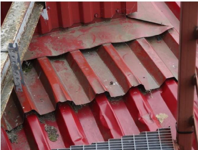
75. Deformuota stogelio skardos danga
