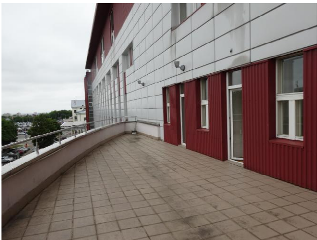
33 pav. Pastato terasos paviršiuje užsistovi vanduo, reikalingas nuolydžių užtikrinimas.
