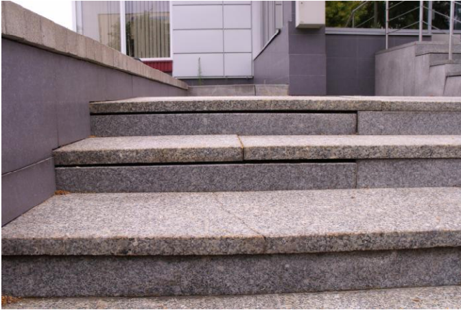
13 pav. Paradiniuose laiptuose atsiradę plyšiai tarp laiptų apdailinių plokščių.
