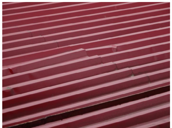
74. Deformuota stogelio skardos danga
