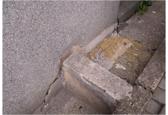
4 pav. Šviesduobėse blogai įrengta drenažinė sistema, vanduo laikosi ir ardo cokolį. Matomas atsokęs cokolio tinkas.
