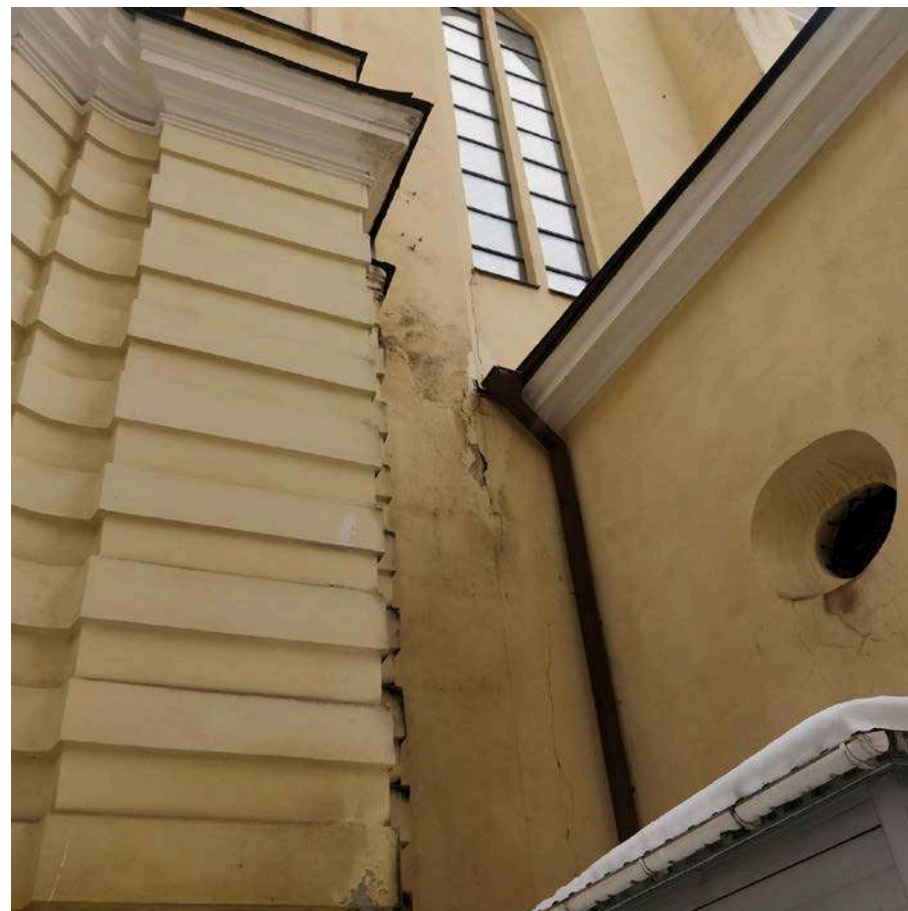
Nuotrauka Nr. 2. Bažnyčios fasado dalis iš Didžiojo kiemo pusės. Lietaus nuvedimo sistema organizuota, nekanalizuota. Matosi lietaus vandens veikiamas sienos dalis. Po masverku su langu užfiksuotas įtrūkimas. Karnizai su karnizėliais apskardinti, cinkuota skarda, parūdijusi.
