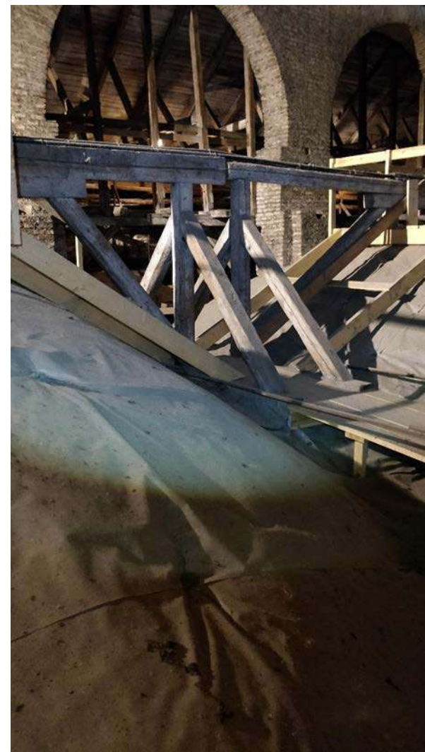
Nuotrauka Nr. 32. Matosi sietyų kėlimų mechanizmo laikančios konstrukcijos. K-jos geros būklės, vietomis reikalauja remonto ir netekčių atstatymo.
