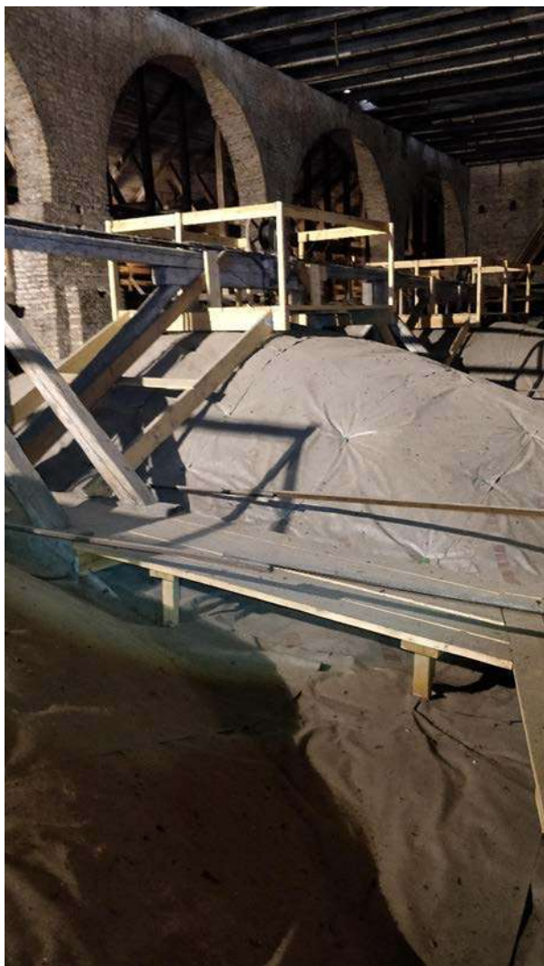
Nuotrauka Nr. 31. Matosi sietyų kėlimų mechanizmo laikančios konstrukcijos. K-jos geros būklės, vietomis reikalauja remonto.
