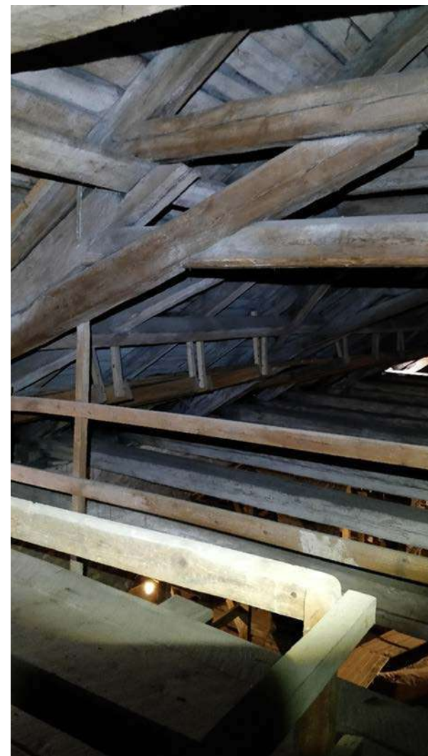
Nuotrauka Nr. 45. Viršutinio stogo pagrindinis rėmas su dvigubu rygeliu konstrukciją spyriais ir gegnėmis. Stogo konstrukcija remiasi ant mūro arkados. Pagrindinio rėmo fragmentas, dalis rėmų turi išjudėjusių mazgų defektų.
