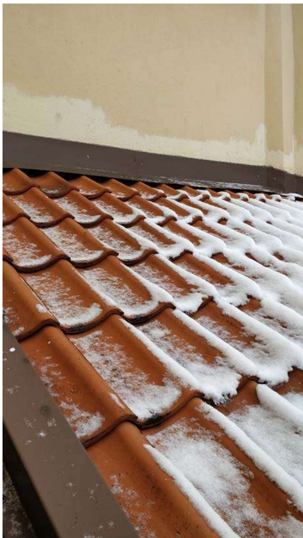
Nuotrauka Nr. 50. Koplyčių stogų (tarp ašių „A-B“) S pavidalo stogo danga su apskardinimu puralu dengtos skardos. Stogas danga geros būklės.
