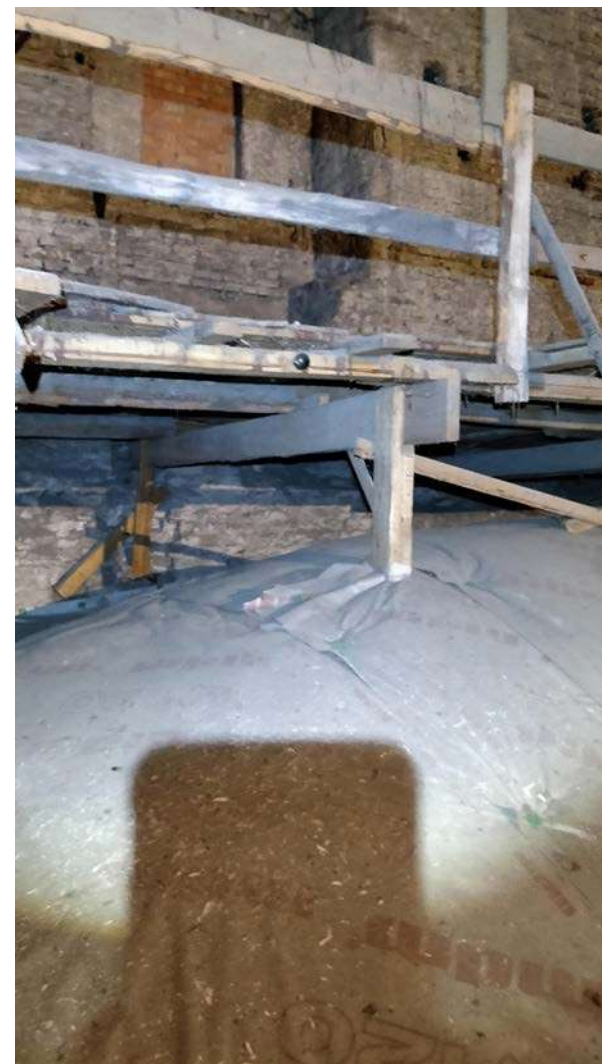
Nuotrauka Nr. 34. Aptarnavimo takų medinė konstrukcija tarp ašių „D-F“ ir „1-3“. Aikštelė remiasi į skliautus, turi įlinkimų požymių, turi būti remontuojama.
