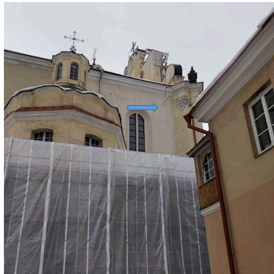
Nuotrauka Nr. 6. Bažnyčios fasado fragmentas iš K. Sirvydo kiemo pusės. Ties frontonu sandūroje su išilgine siena užfiksuotas plyšys. Išilgine siena yra inkaruota strypininiais inkarais. Fronotno kryžius yra sustiprintas iš plokštumos metaline k-ja.
