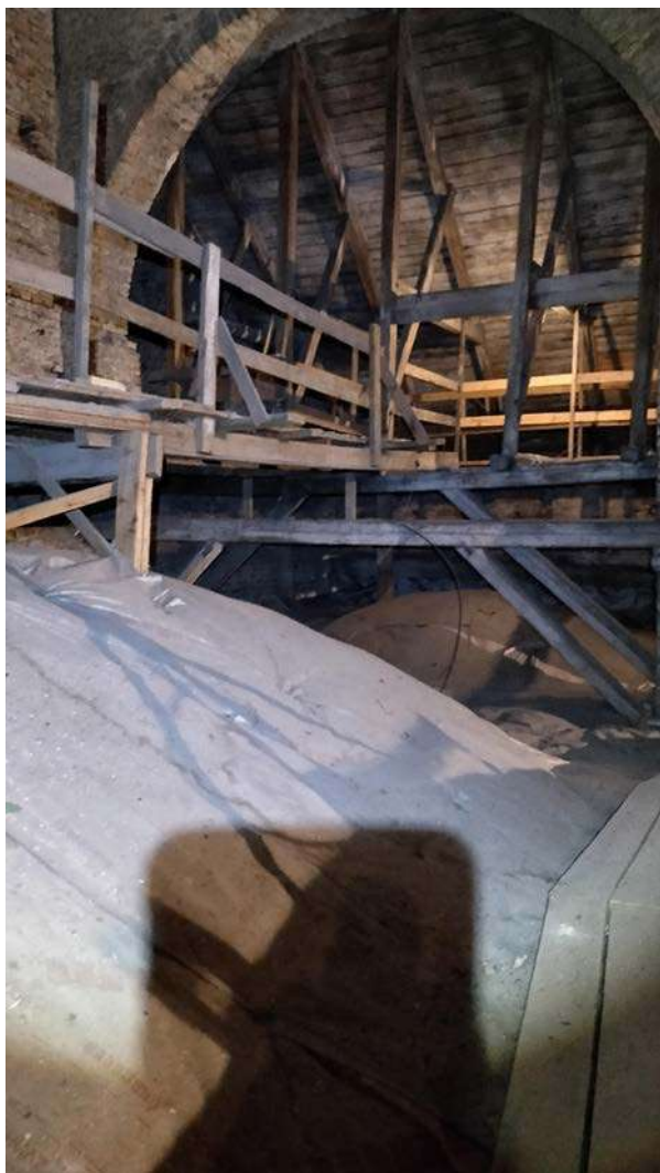
Nuotrauka Nr. 33. Aptarnavimo takų medinė konstrukcija tarp ašių „D-F“ ir „1-3“. Aikštelė remiasi į skliautus, turi įlinkimų požymių, turi būti remontuojama.
