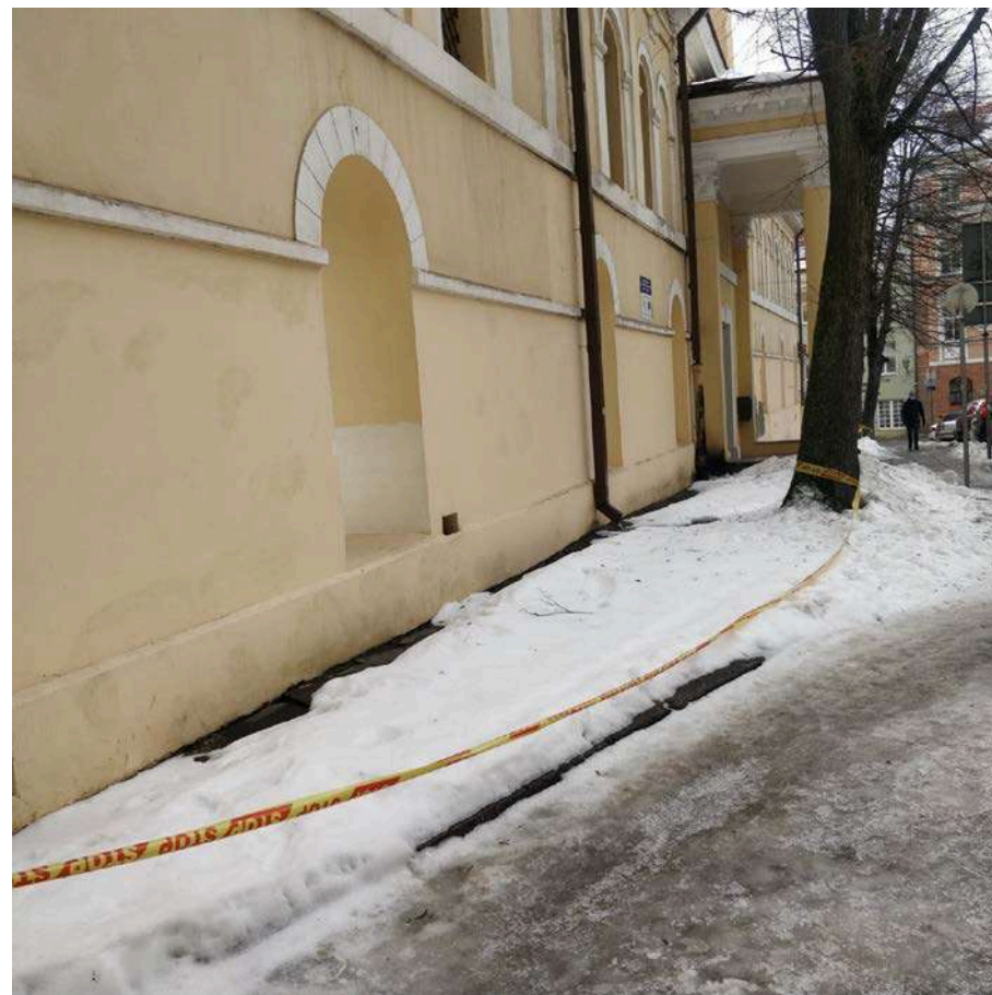
Nuotrauka Nr. 4. Bažnyčios cokolio fragmentas iš Šv. Jonų g. pusės. Lietaus nuvedimo sistema organizuota, nekanalizuota. Fasade matosi krakeliūriniai fasado ir kiti įtrūkimai. Portikas remontuotas nepriklausomybės laikais.
