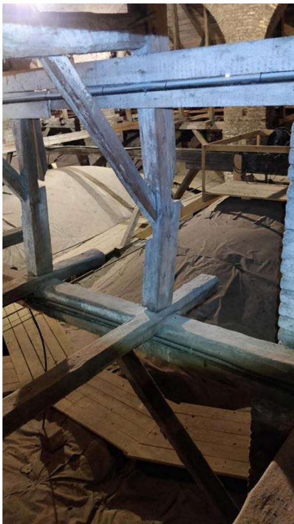
Nuotrauka Nr. 23. Apatainio stogo konstrukcijų fragmentas. Statramstis, dėl netinkamai įrengto spyrio yra įlūžęs, būtina atstatyti.
