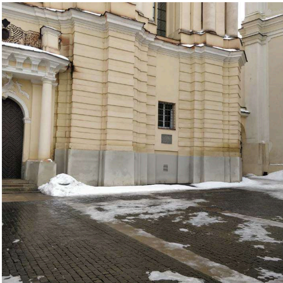
Nuotrauka Nr. 1. Bažnyčios pagrindinis įėjimas iš Didžiojo kiemo pusės. Cokolis neseniai remontuotas naudojant sanuojantį tinką. Karnizai apskardinti cinkuota skarda, parūdijusi.
