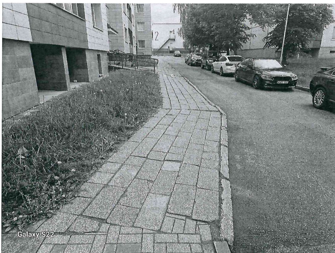
3 pav. Esama šaligatvių būklė
