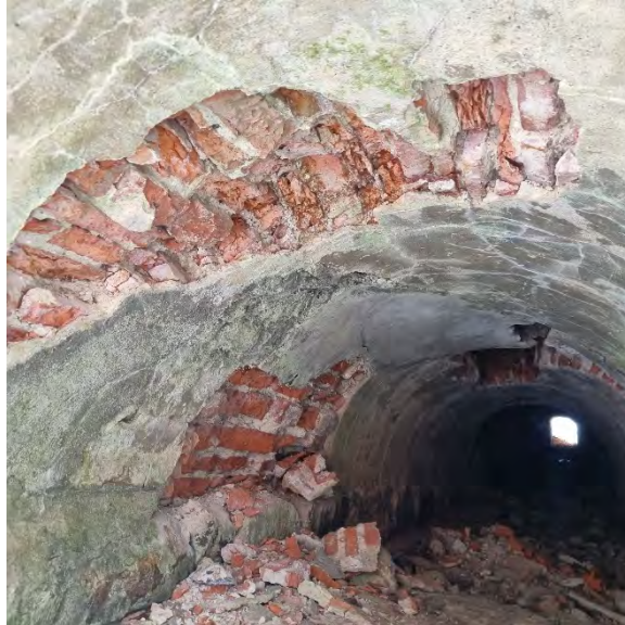
F3 pralaidos skliauto vėlyvų remonto darbų skliauto mūro pažaidų pertrynimai.
