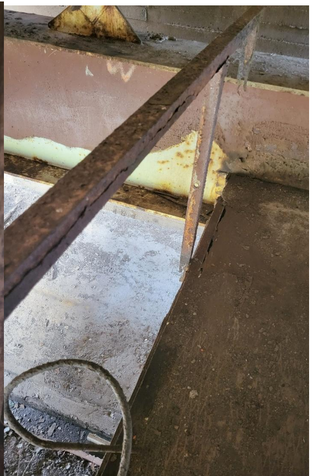
Pav. pažeisti apvalgos tako elementai
