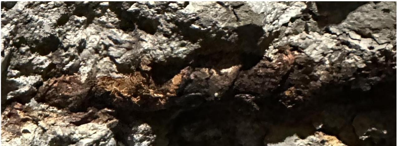
Pav.7.23 Nepakankamas armatūros apsauginis sluoknis. Armatūros korozija.
