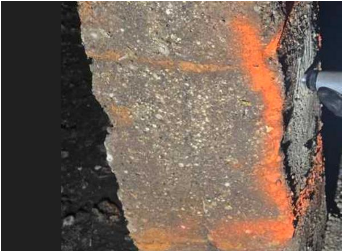
Pav. 7.8 Betono ištrupėjimai
