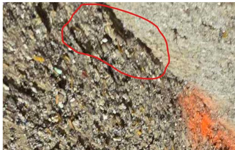
Pav. 7.4 Betono ištrupėjimai
