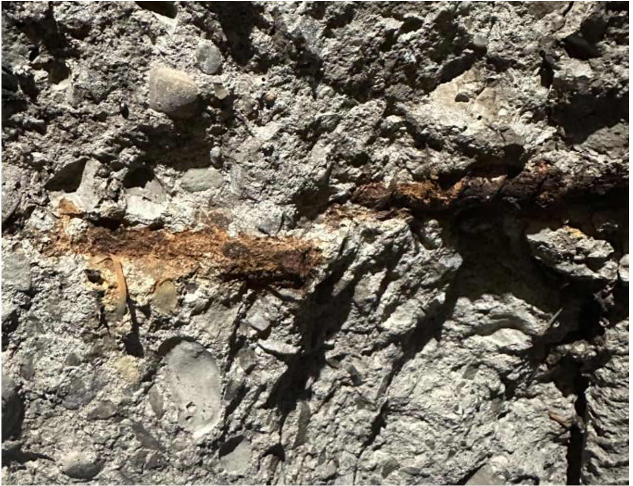
Pav.7.22 Nepakankamas armatūros apsauginis sluoknis. Armatūros korozija.
