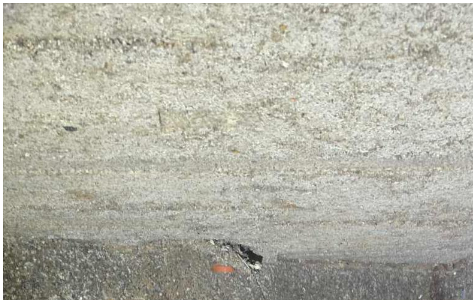
Pav. 7.2 Betono lokalūs ištrupėjimai
