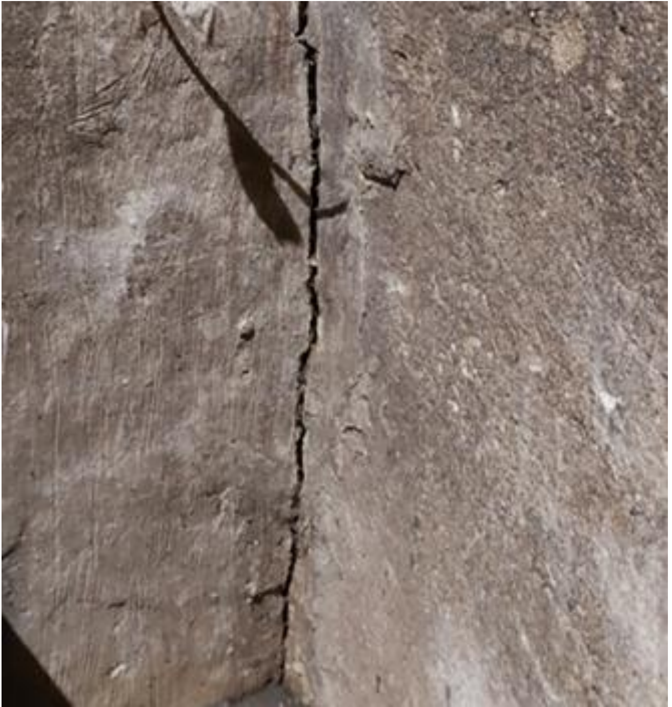
Pav. 7.20 Pertvaros plokštės atitrūkimas
