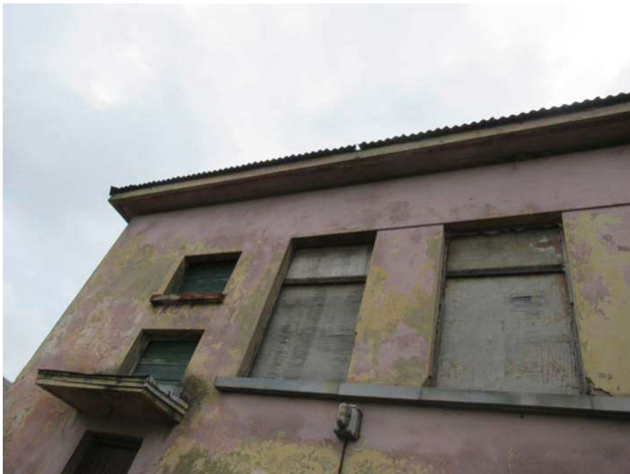
Nuotrauka Nr. 3. II aukšto fasado fragmentas tarp ašių „J-I“. Matosi betoninis formuotas karnizas su laštakiu. Lietaus nuvedimo sistema neorganizuota. Tinkas prie stogelio pažeistas drėgmės. Polangiai formuoti 0,5 plytos storio. Vietomis apskardinti. Šioje pastato langai užkalti MP plokštėmis.
