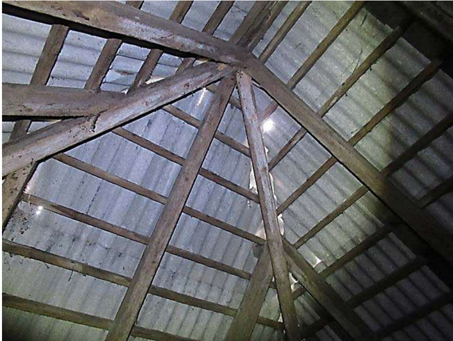
Nuotrauka Nr. 45. Neeksploatuojamos pastogės fragmentas tarp ašių "10-12" ir "A-G". Matosi stogo laikančioji konstrukcija. Stogo danga asbecementinių lakštų tvirtintų prie grebėstų 5x5 cm.
