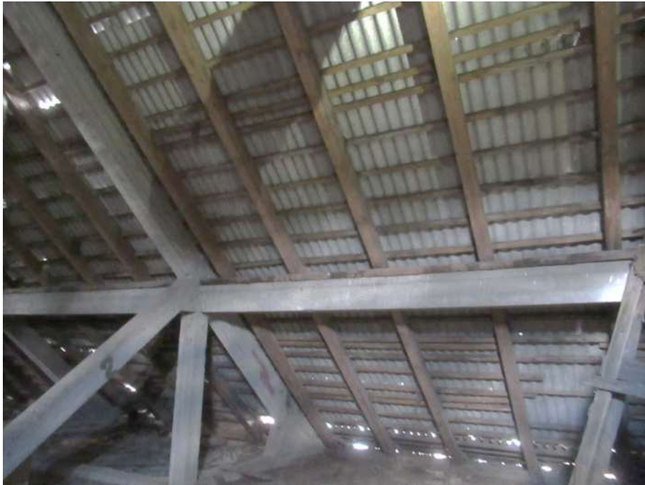
Nuotrauka Nr. 71. Pastogės tarp ašių “3-10” ir “A-E” fragmentas. Matosi laikančių konstrukcijų rėmas, betoninis, ilginis, ant jo remiasi stogo dangos konstrukcija. Stogo danga nesandari. Gegnės ~15x10 cm ant jų išdėstyti grebėstai 30x30 cm ir stogo danga a/c lakštų. Stogo danga keista sovietmčiu.
