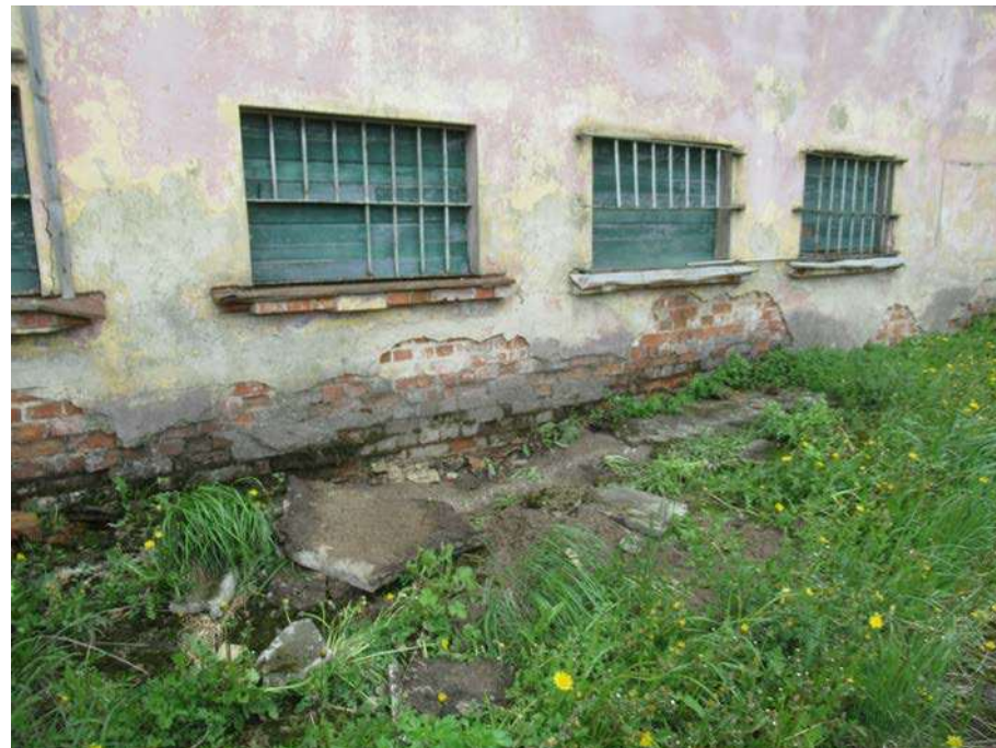
Nuotrauka Nr. 4. I aukšto fasado fragmentas tarp ašių „J-I“. Matosi erodavęs cokolio tinkas. Palangės apskardintos, langai užkalti, grotuoti, dešinėje pusėje matosi lango angos pėdsakai. Nuogrinda betoninė, susidėvėjusi, apaugusi augmenija.
