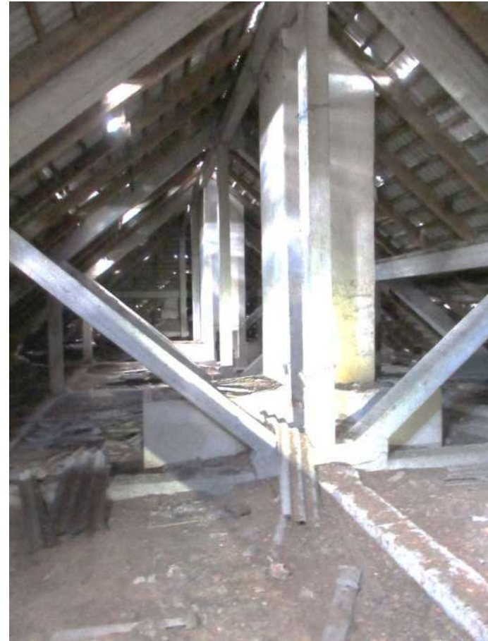
Nuotrauka Nr. 72. Pastogės tarp ašių “3-10” ir “A-E” fragmentas. Matosi laikančių konstrukcijų rėmas, betoninis, ilginis, ant jo remiasi stogo dangos konstrukcija. Rėmai betoniniai.
