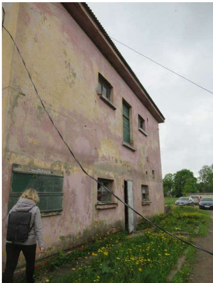
Nuotrauka Nr. 21. Pastato fasado fragmentas tarp ašių „8-4“. Matosi įėjimo durys ir stačiakampiai langai su palangėmis, apskardinti. Langų rėmai mediniai. Fasado tinkas dažytas, ne vieną kartą. Cokolio tinkas erodavęs, nukritęs. Įėjimo pandusas betonuotas.
