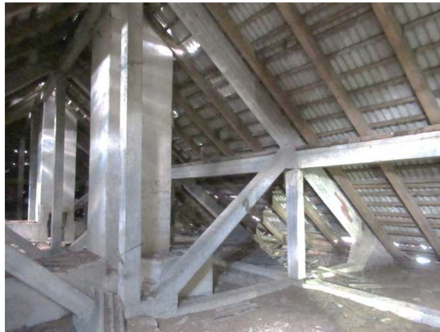
Nuotrauka Nr. 70. Pastogės tarp ašių “3-10” ir “A-E” fragmentas. Matosi laikančių konstrukcijų rėmas, betoninis, ilginis, ant jo remiasi stogo dangos konstrukcija. Stogo danga nesandari. Kaminai iki stogo dangos tinkuoti
