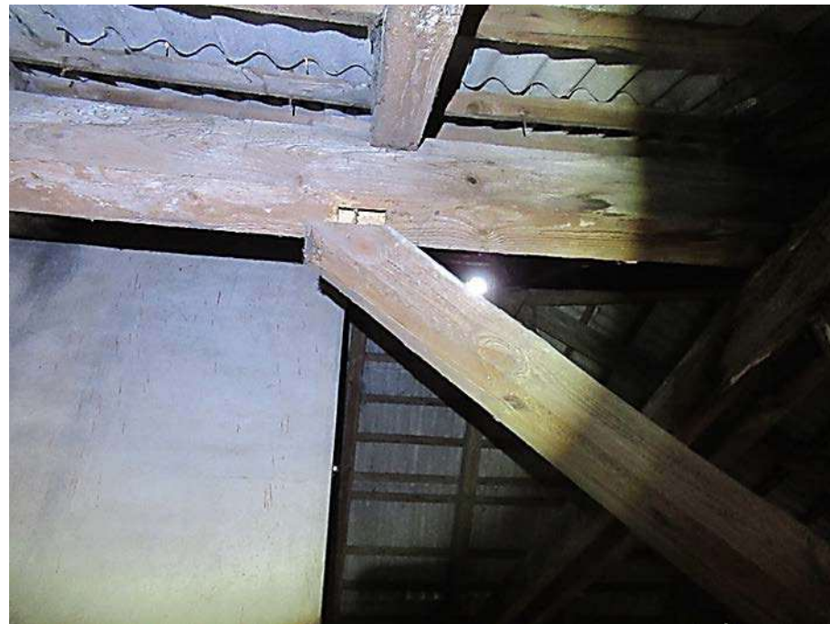
Nuotrauka Nr. 56. Pastogės fragmentas tarp ašių “ 4-8” ir “H-J”. Stogo laikančios konstrukcijos defektas, matosi iširęs statramstis.
