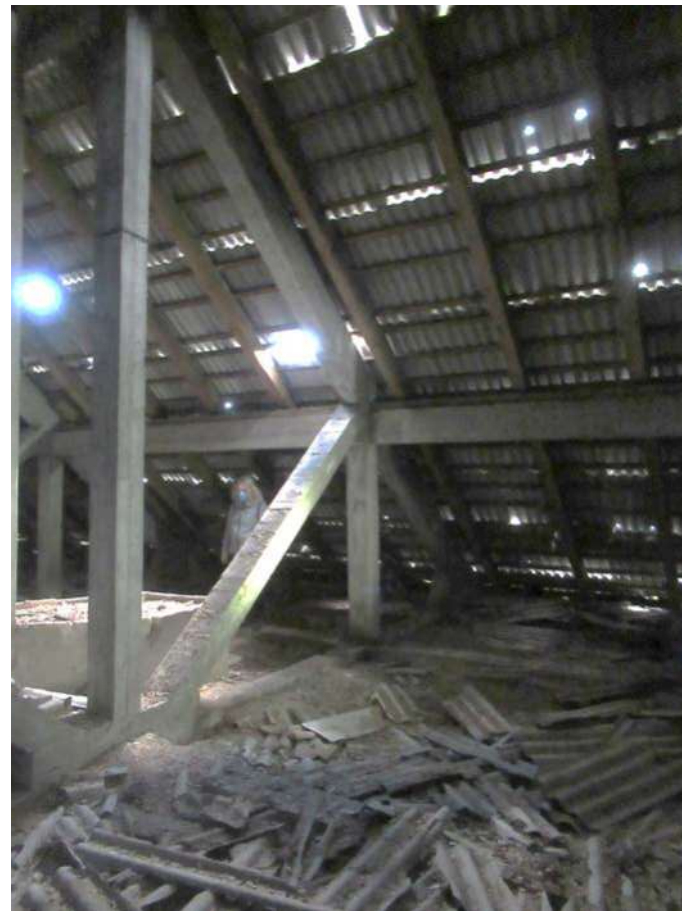
Nuotrauka Nr. 68. Pastogės tarp ašių “3-10” ir “A-E” fragmentas. Matosi laikančių konstrukcijų rėmas, betoninis, ilginis, ant jo remiasi stogo dangos konstrukcija. Stogo danga nesandari.
