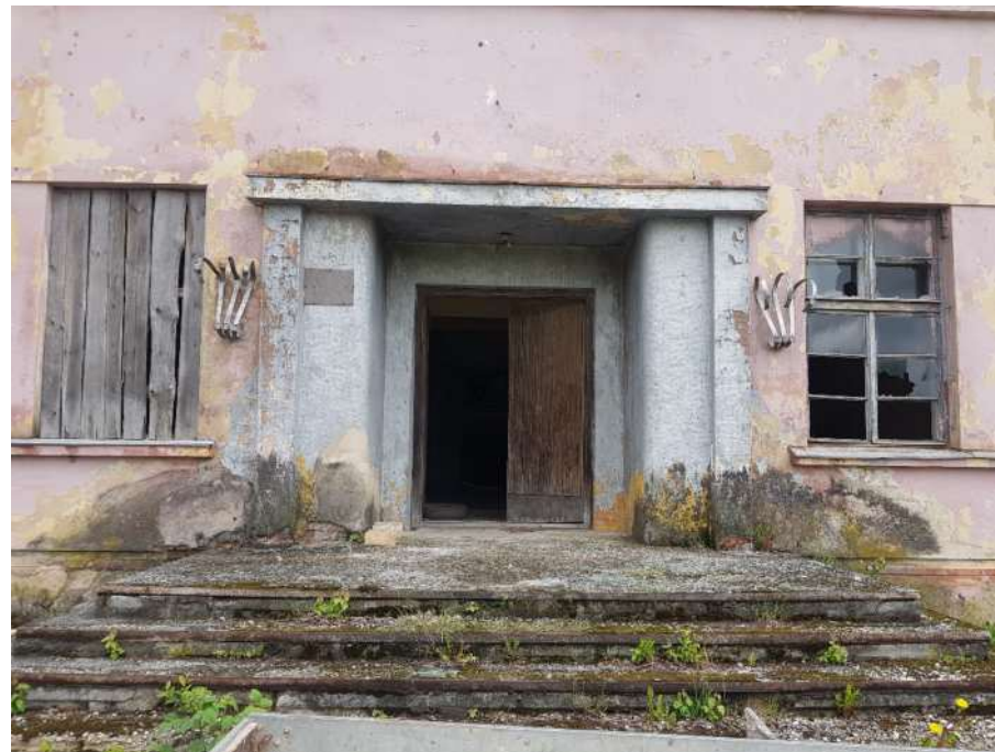
Nuotrauka Nr. 12. Įėjimo tarp ašių „5-8“ fragmentas. Matosi 5-ių pakopų betoniniai laiptai, apkaustyti, paskutinio remonto metu. Įėjimo apatinės dalies tinkas pažeistas drėgmės ir druskų dėl lietaus vandens taškymosi, įėjimas be stogelio. Virš įėjimo įrengta sgrama. Durys dvivėrės, medinės, neoriginalios. Įrengti vėliavų laikikliai.
