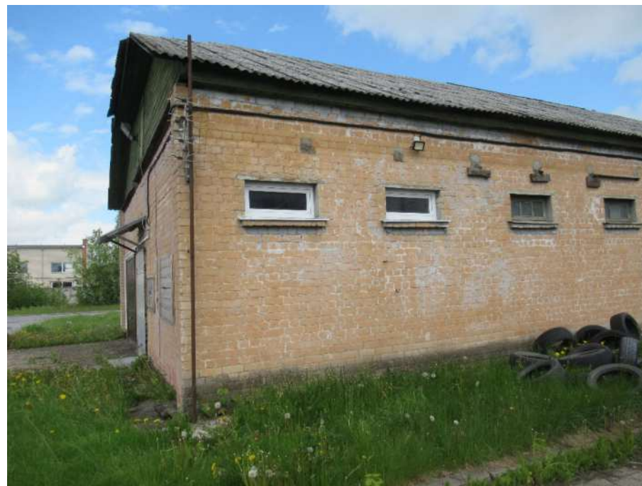
Nuotrauka Nr. 60. Sandėliavimo paskirties pastato fasado fragmentas ašių "A" ir "I" sankirtoje. Pastato sienos plytų mūro, dažytos. Cokolis pažeistas drėgmės ir druskų. Stogo danga – banguotų asbescemento lakštai. Langai stačiakampės formos, vietomis keisti į naujus PVC. Pastatas išilginių laikančių sienų su ertikiu, skersai įrengti stogo laikančių konstrukcijų rėmai.
