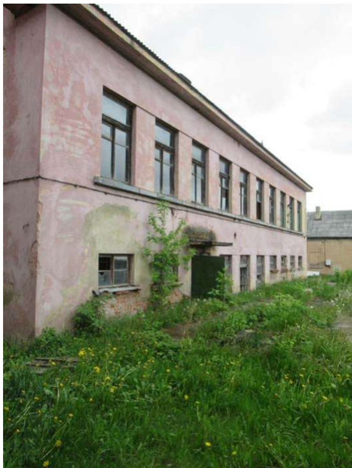
Nuotrauka Nr. 19. Pastato fragmentas tarp ašių "H-J". Šioje pastato dalyje grindų lygis yra žemiau ~1,5m gatvės lygio. I-o langai remontuoti, galinių langų plotas sumažintas. II-o palangės apskardintos. Įėjimo stogelis apskardintas, tinkas virš – erodavęs. Dešinėje nuotraukos pusėje matosi išbetonuotas automobiliams skirta pakyla, apaugusi žole.
