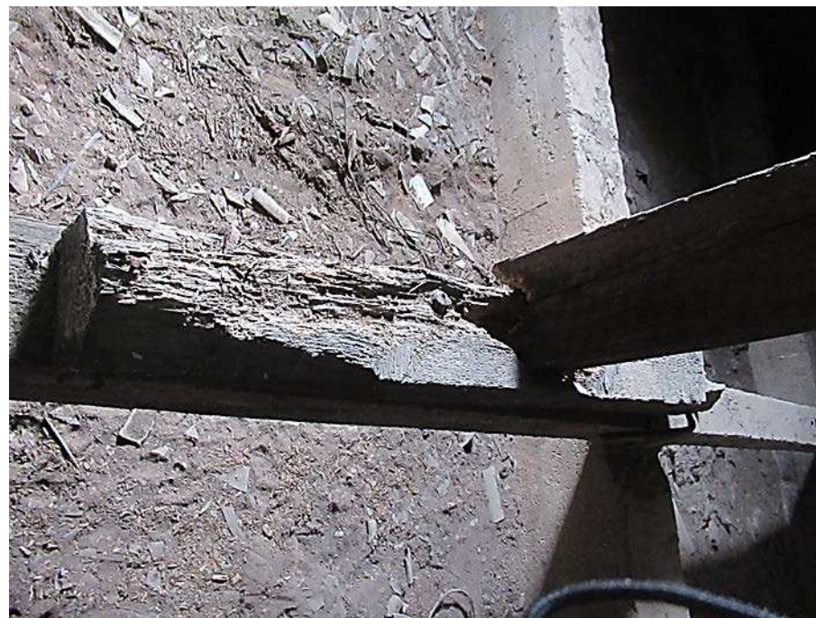
Nuotrauka Nr. 56. Pastogės fragmentas tarp ašių "4-8" ir "H-J". Stogo laikančios konstrukcijos defektas, matosi pūvėsio pažeisti ilginiai.
