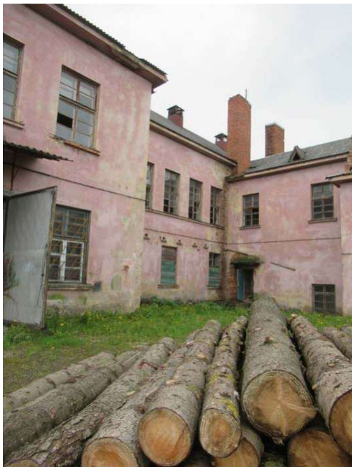
Nuotrauka Nr. 17. Pastato fragmentas tarp ašių "12-H". Kairėje pusėje dvivėriai apkaustyti mediniai vartai su a/b lakštų stogeliu. Iš kiemo pusės, lietvamdzžiai neįrengti. Sienų sandūrose, kur lietaus vanduo daugiausia patenka, tinkas erodavęs, plytų mūras atviras, veikiamas drėgmės. Kaminais plytų mūro, netinkuoti, dalinai apskardinti. Įėjimas su stogeliu. Matosi pėdsakai buvusio stogelio tarp ašių „8-10“. Nuogrinda apaugusi žole.
