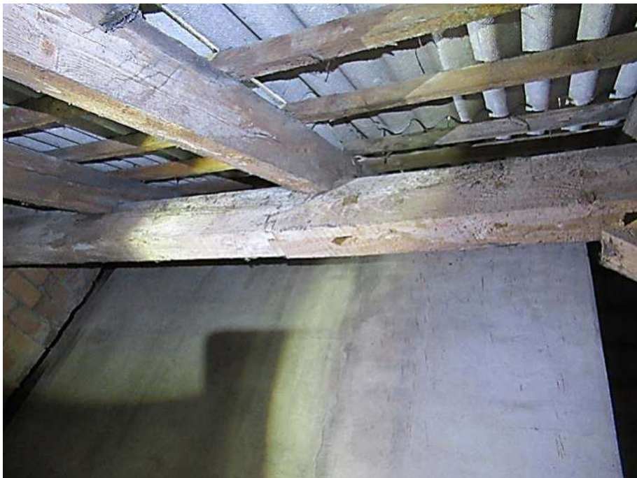
Nuotrauka Nr. 57. Pastogės fragmentas tarp ašių “ 4-8” ir “H-J”. Stogo laikančios konstrukcijos defektas, matosi puvesio pažeisti gegnių galai.
