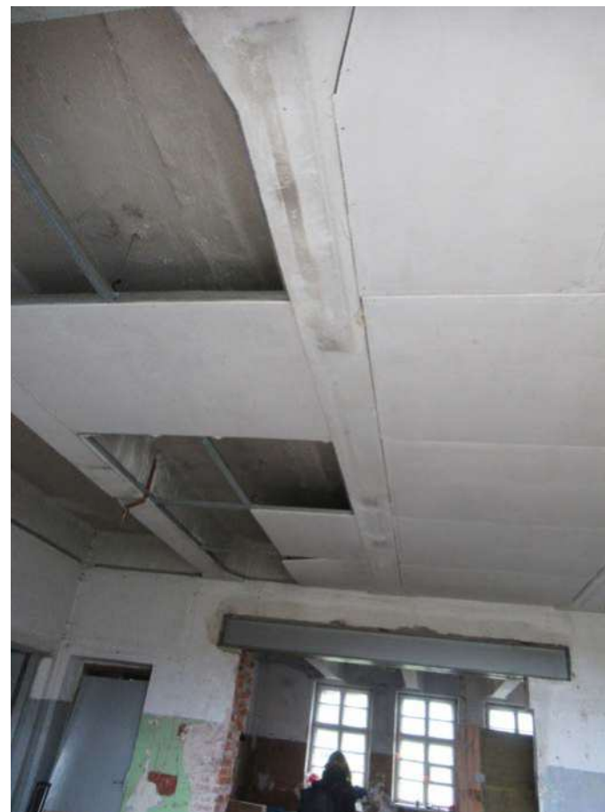
Nuotrauka Nr. 18. Patalpos fragmentas pirmame aukšte (garažas). Matosi paskutinio remonto sprendiniai. Sąrama virš angos dvitėjo, anga praplatinta. Lubos pakabinamos, įrengtos nepriklausomybės laiku.
