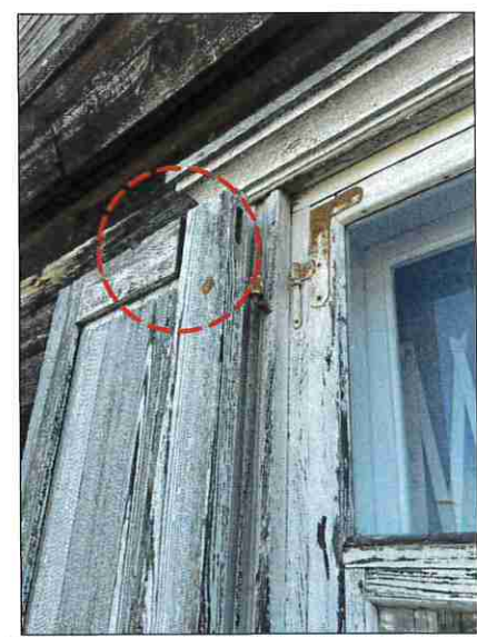
KAI KURIŲ MEDINIŲ FILINGINIŲ LANGINIŲ KARKASO RĖMAS YRA "ATLAISVĖJĘS-IŠSINĖRĖS". REIKALINGAS MEDINIŲ FILINGINIŲ LANGINIŲ REMONTAS. KOROZIJOS PAVEIKTI LANGINIŲ VYRIAI REMONTUOJAMI
