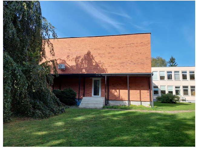
3 pav. Pietryčių fasadas ir stogelis ant kurio montuojami saulės moduliai ir saulės kolektorius
