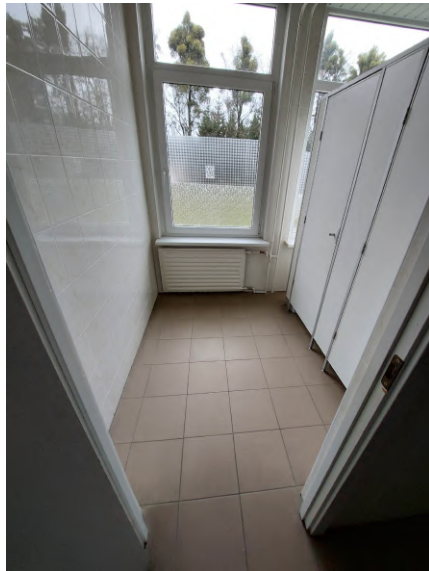
8 pav. WC patalpa Nr. 34 iš kurios atvedama vandentiekio atšaka
