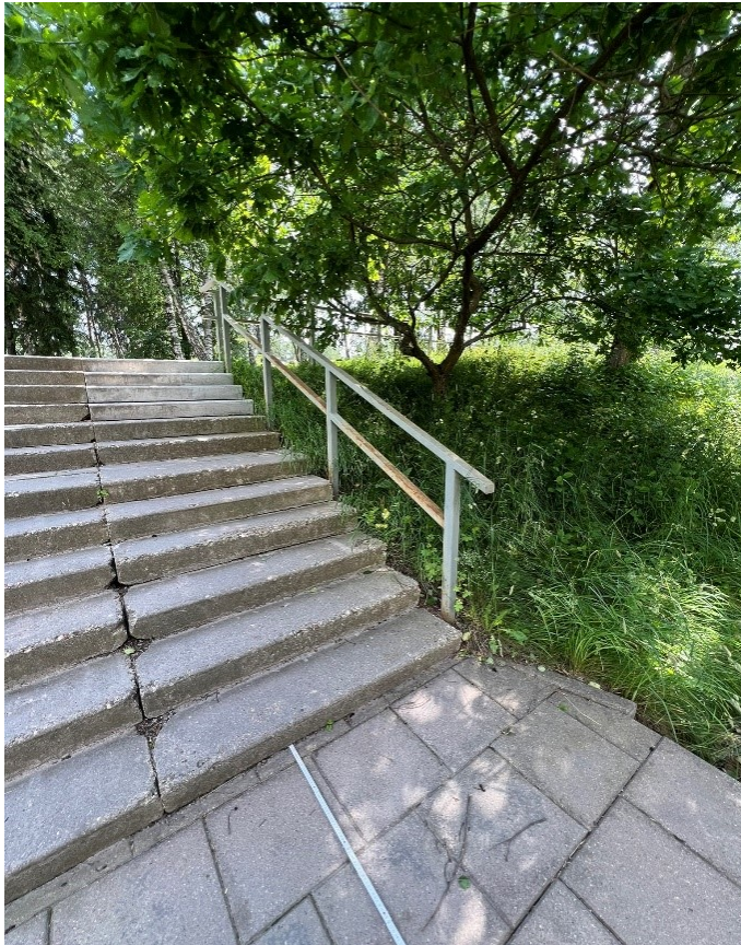
Pav.9. Apsauginiai turėklai daug kur paveikti korozijos, jų estetinė išvaizda nepatenkinama.
