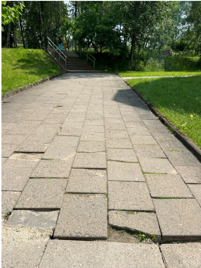
Pav.7. Šaligatvio plytelės laiko bėgyje nevienodai prasėdusios grunte, atrupėję.
