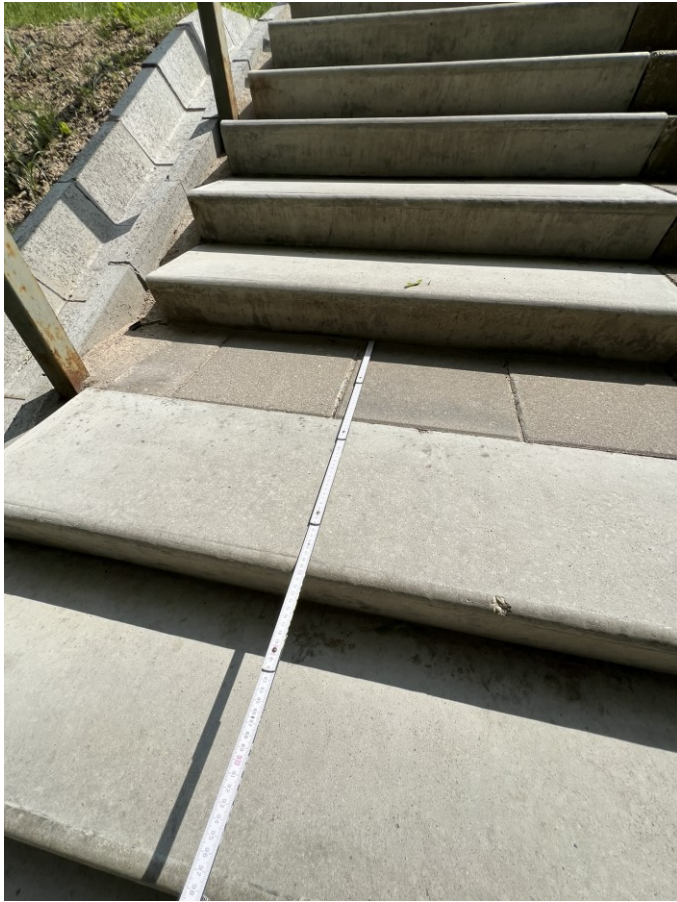
Pav.12. Objekto teritorijoje yra remontuoti laiptai, tačiau jų įrengimas neatitinka prieinamumo ir saugios eksploatacijos reikalavimų.
