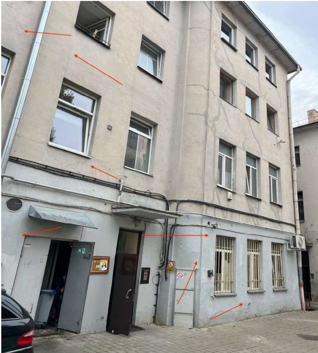
11 pav. Pastebėti daugybiniai fasado defektai, trūkiai ( skilimai )
