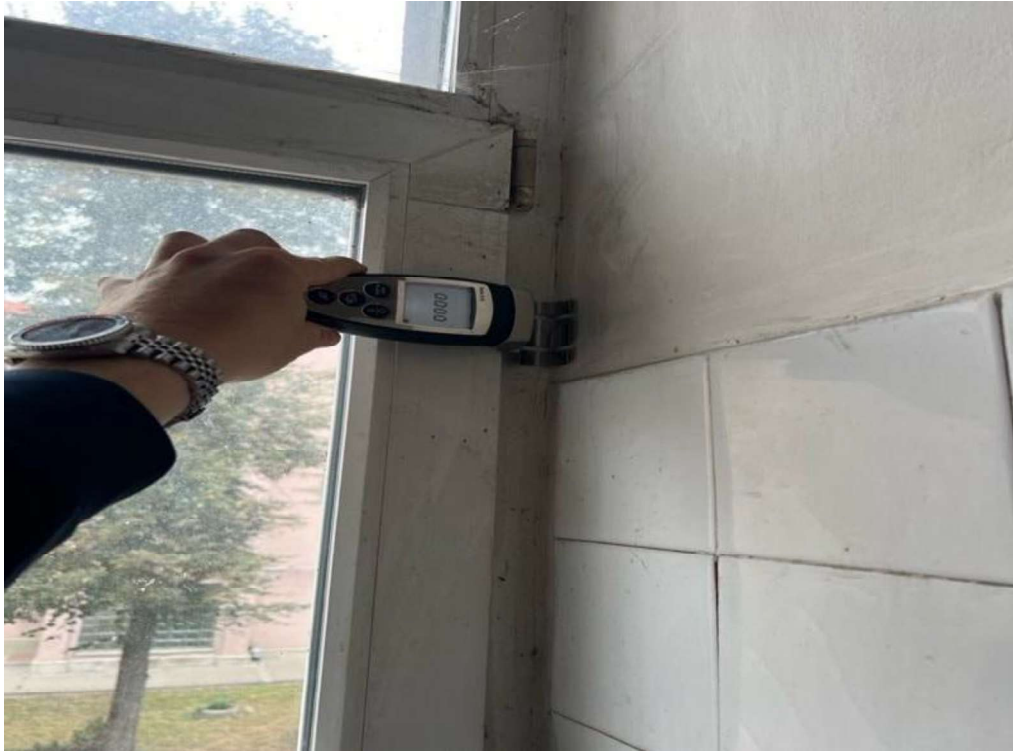
69 pav. Įdrėkio matavimai, nustatytas kritiškai aukštas drėgmės kiekis medžiagų tūryje
