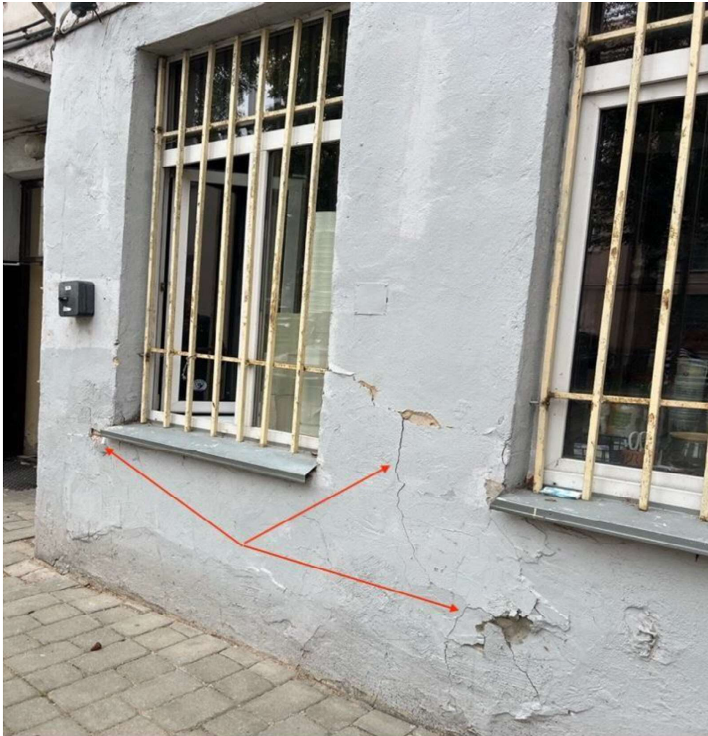
6 pav. Pastato fasado vaizdas iš kiemo pusės. Pastebėti daugybiniai fasado defektai: nutrupėjęs tinkas, trūkiaiai ( skilimai )
