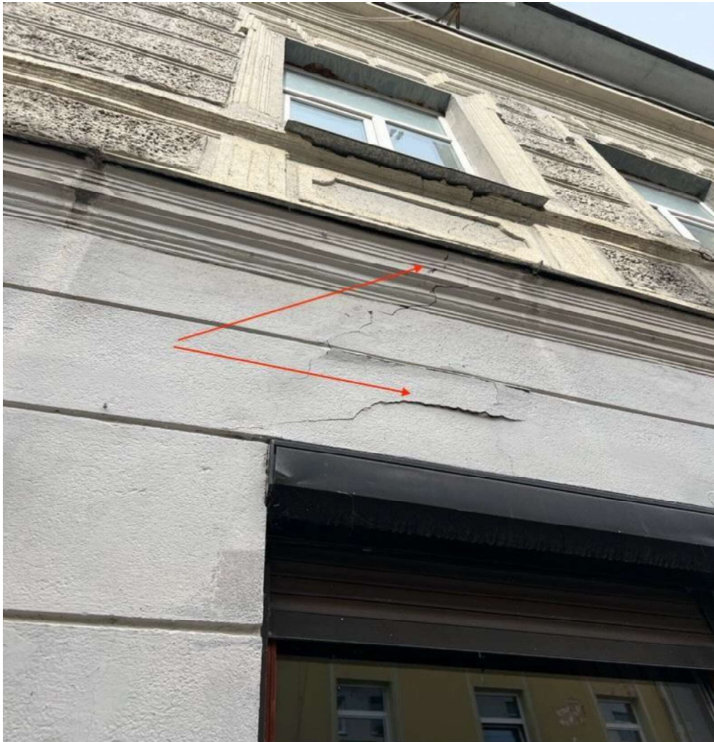
2 pav. Pastato fasado vaizdas iš Vilniaus g. pusės. Stebimi fasado defektai, įstrižieji plyšiai tarp langų ant fasado
