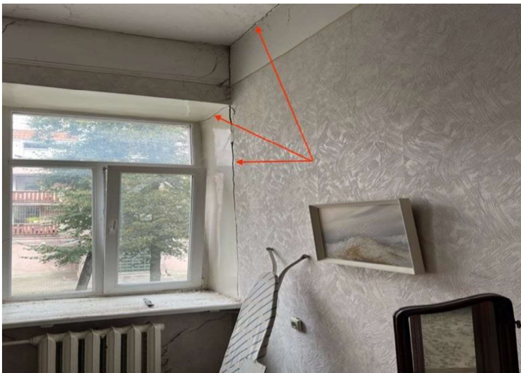
45 pav. Fiksuotas skilimas ties sienos bei lubų susikirtimo vieta. Laikančiųjų sienų defektai – skilimai
