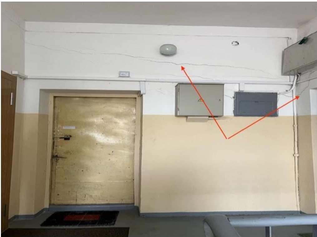
17 pav. Laikančiųjų sienų plyšiai bendrojo naudojimo laiptinės patalpoje
