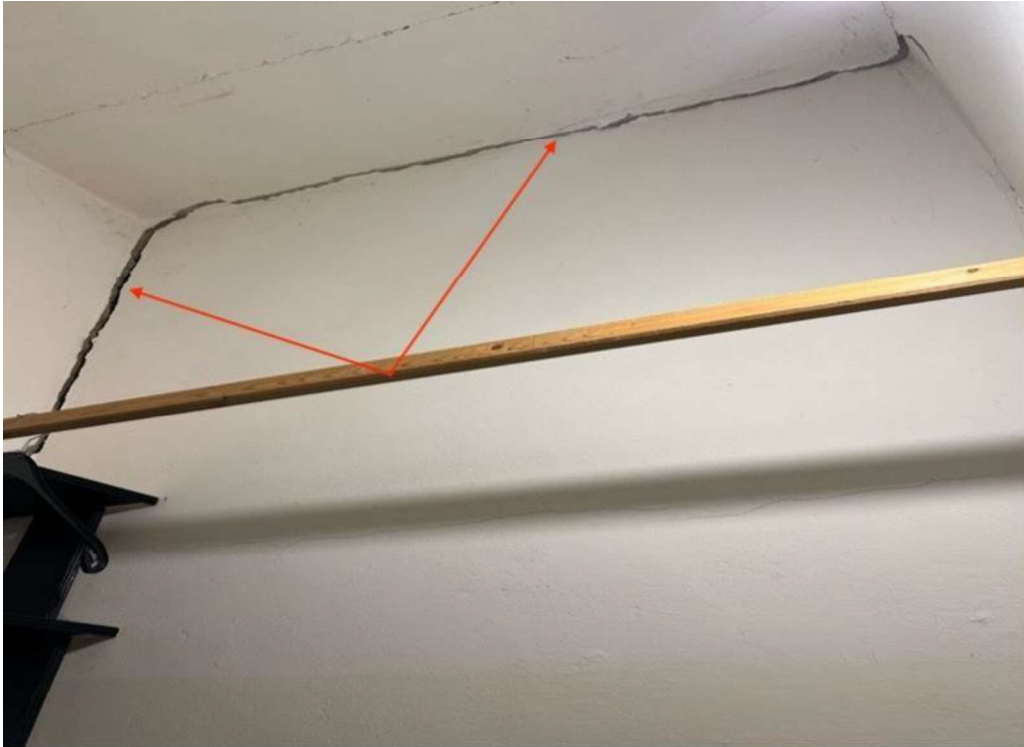
40 pav. Fiksuoti plyšiai: sienų kampe, sienos bei lubų susikirtimo vieta
