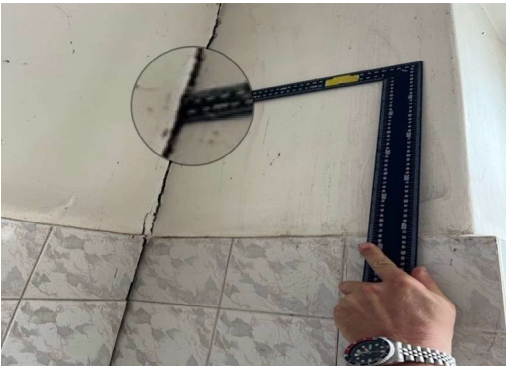
59 pav. Skilimas laikančiųjų sienų kampe. Fiksuotas įtrūkio gylis 35 mm
