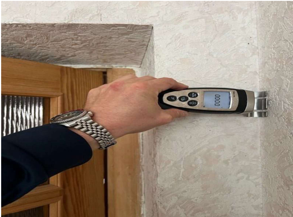
67 pav. Įdrėkio matavimai, nustatytas kritiškai aukštas drėgmės kiekis medžiagų tūryje
