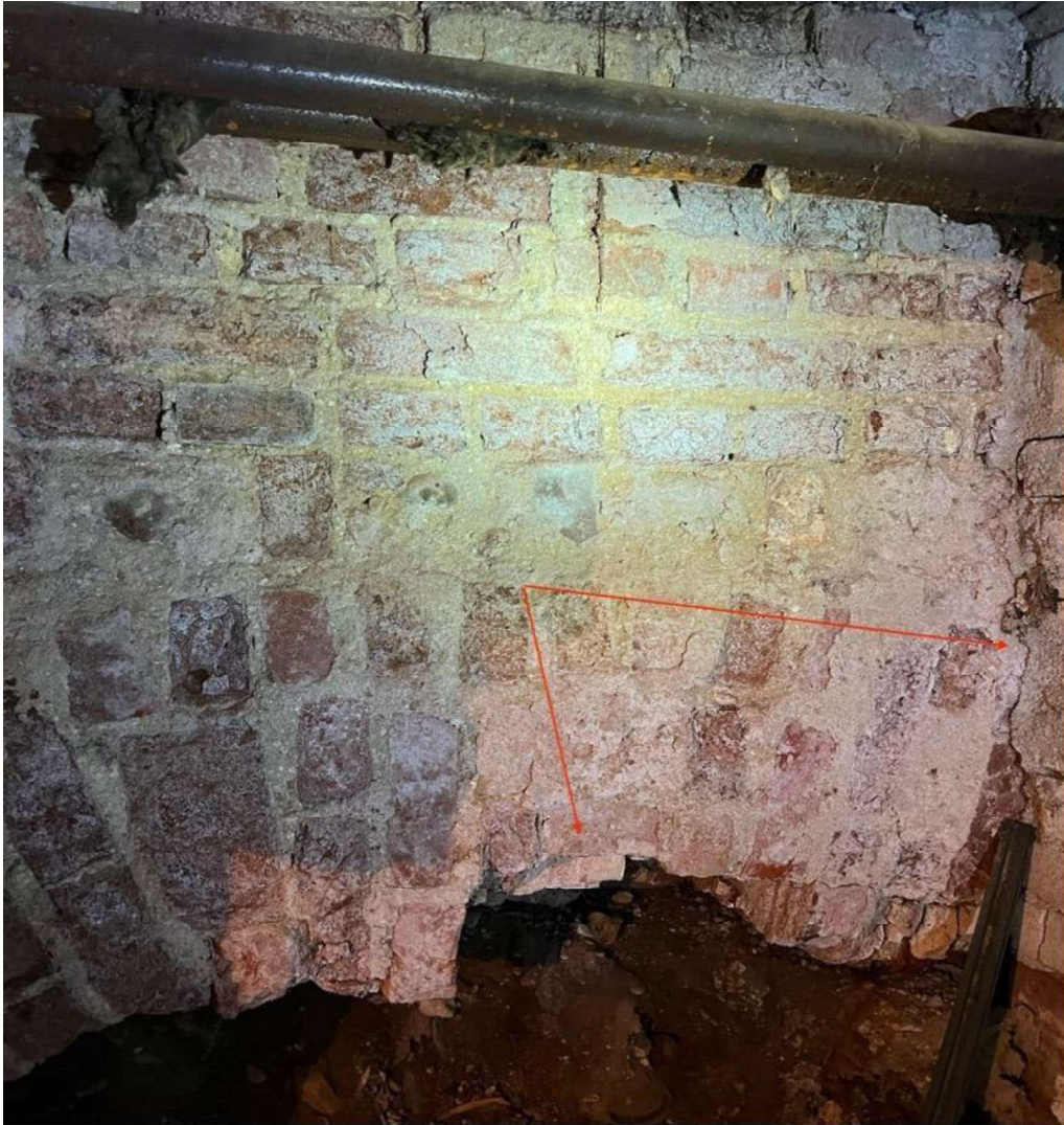
14 pav. Yrantis plytų mūras, trūkiai/skilimai
