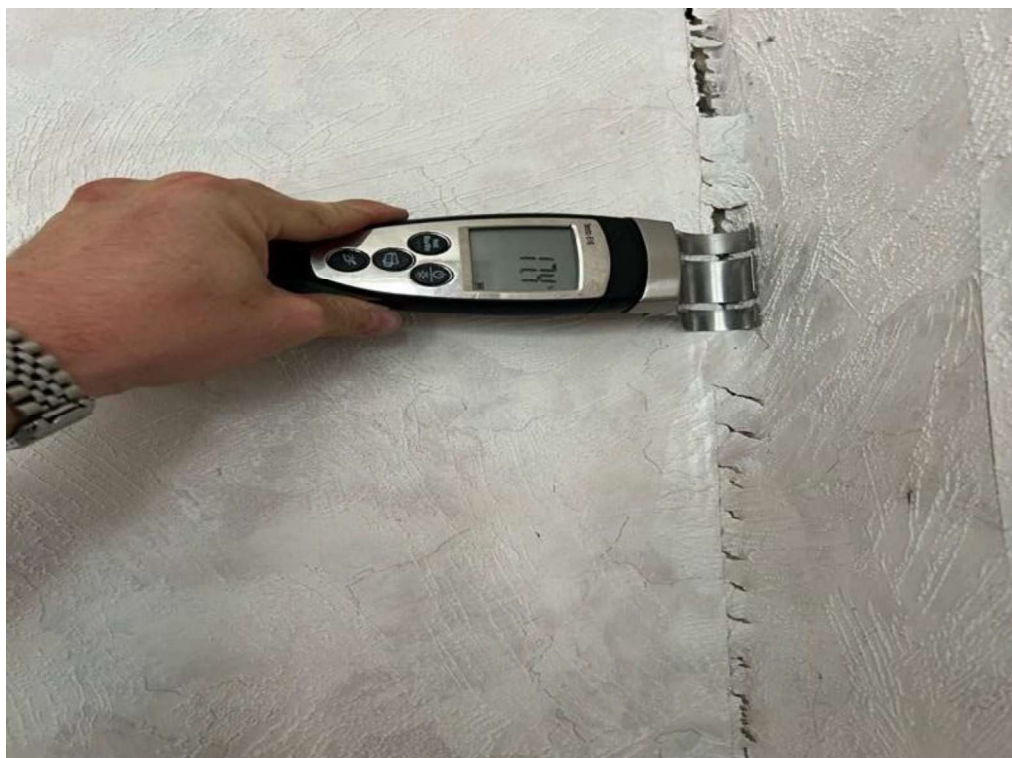
56 pav. Įdrėkio matavimai, nustatytas aukštas drėgmės kiekis medžiagų tūryje
