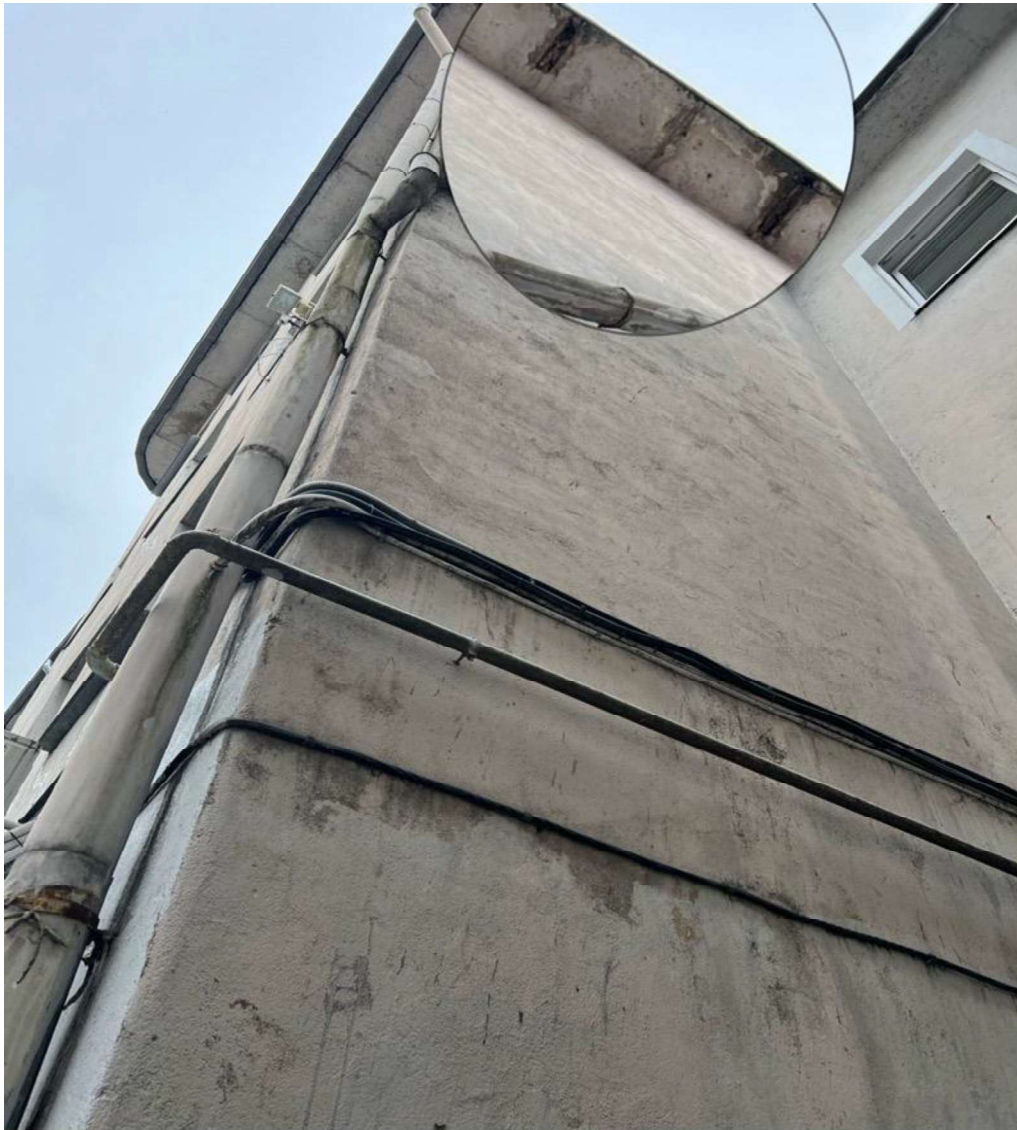
10 pav. Pastato fasado vaizdas iš kiemo pusės. Korozijos paveiktos laikančiosios konstrukcijos. Matomi yrantys gelžbetonio pagrindai
