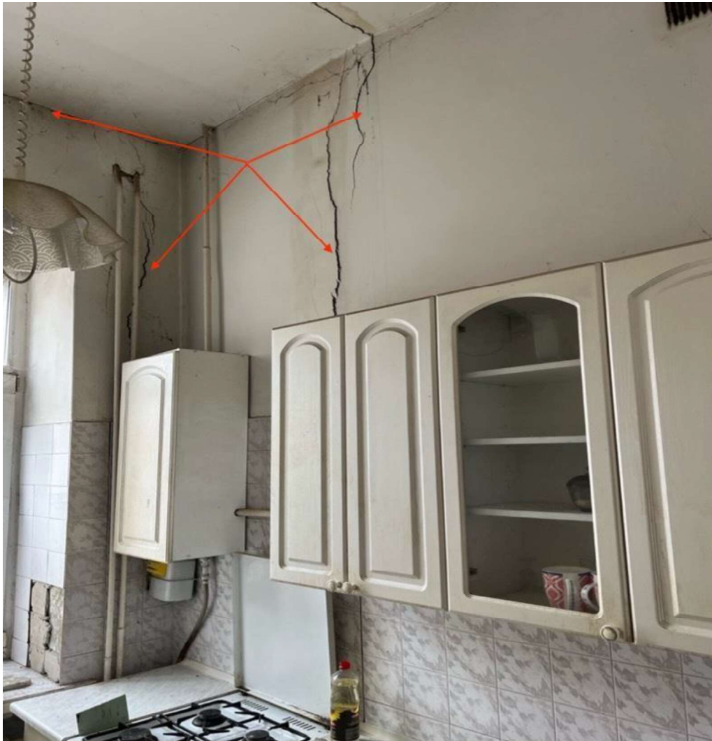
57 pav. Fiksuoti laikančiųjų sienų defektai (trūčiai)
