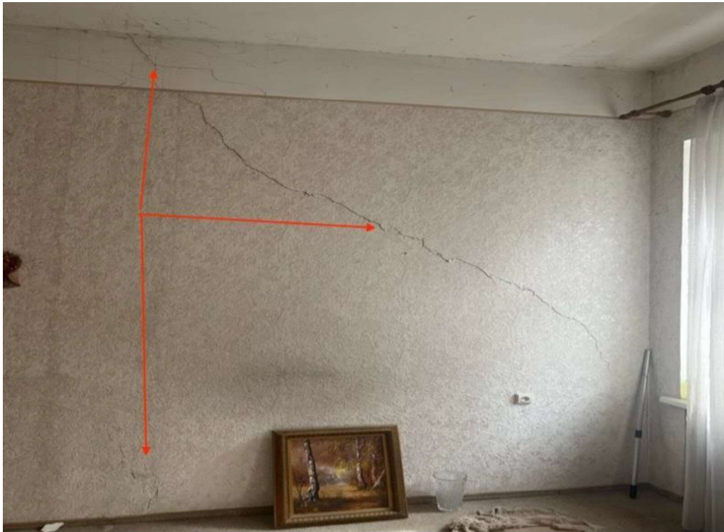
27 pav. 15-ojo buto patalpa. Įstrižieji plyšiai laikančiojoje sienoje
