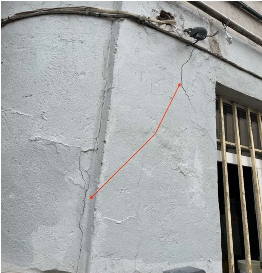
9 pav. Pastebėti daugybiniai fasado defektai, trūkliai ( skilimai )
