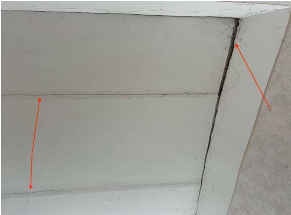
49 pav. Plyšys ties sienos bei lubų susikirtimo vieta, Skilimai tarp perdangos plokščių
