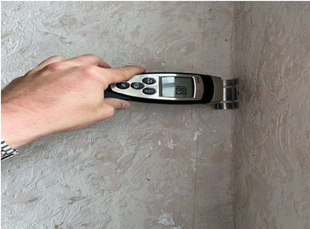
36 pav. Įdrėkio matavimai, nustatytas kritiškai aukštas drėgmės kiekis medžiagų tūryje
