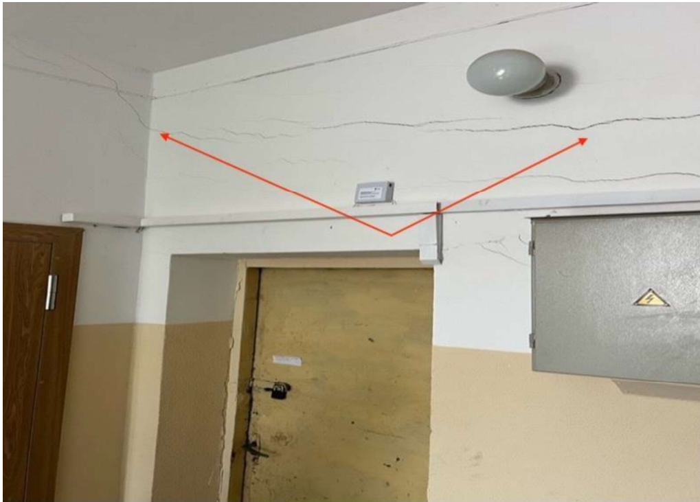
19 pav. Laikančiųjų sienų plyšiai bendrojo naudojimo laiptinės patalpoje
