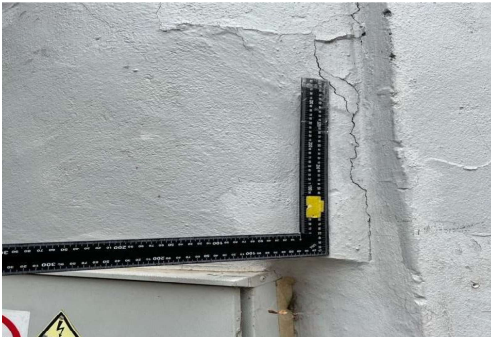
8 pav. Pastato fasado vaizdas iš kiemo pusės. Fiksuoti trūkiai ( skilimai )
