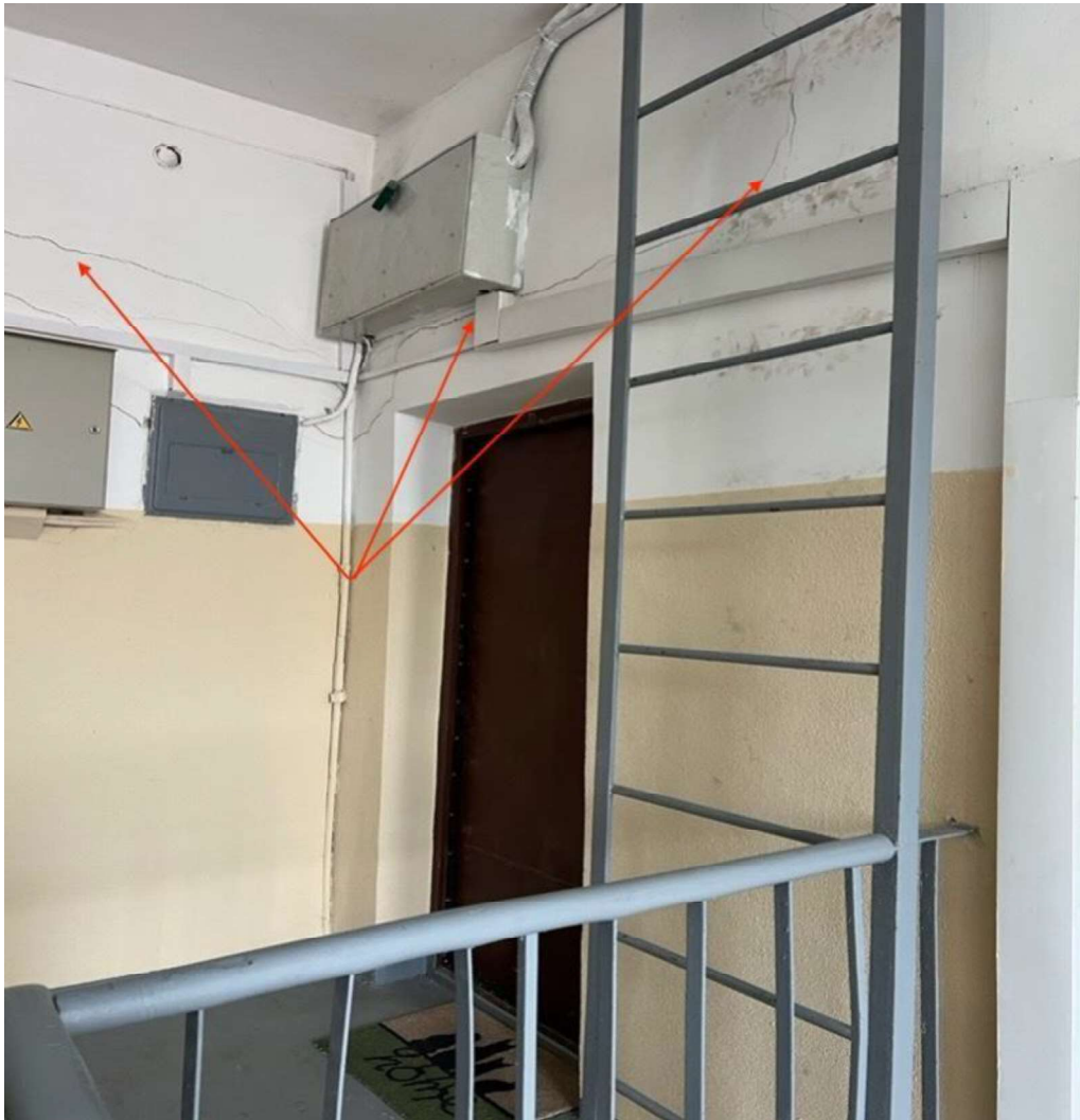
18 pav. Laikančiųjų sienų plyšiai bendrojo naudojimo laiptinės patalpoje
