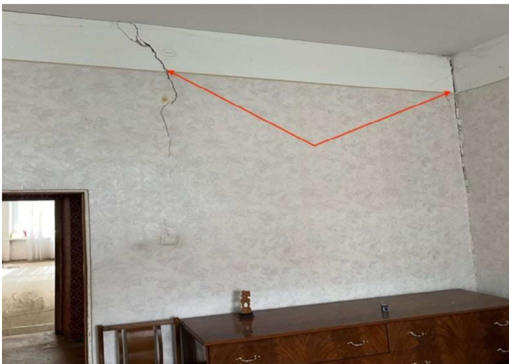
48 pav. Sutrukęs vidinis kampas. Skilimas ties sienos bei lubų susikirtimo vieta. Įstrižas plyšys laikančiojoje sienoje
