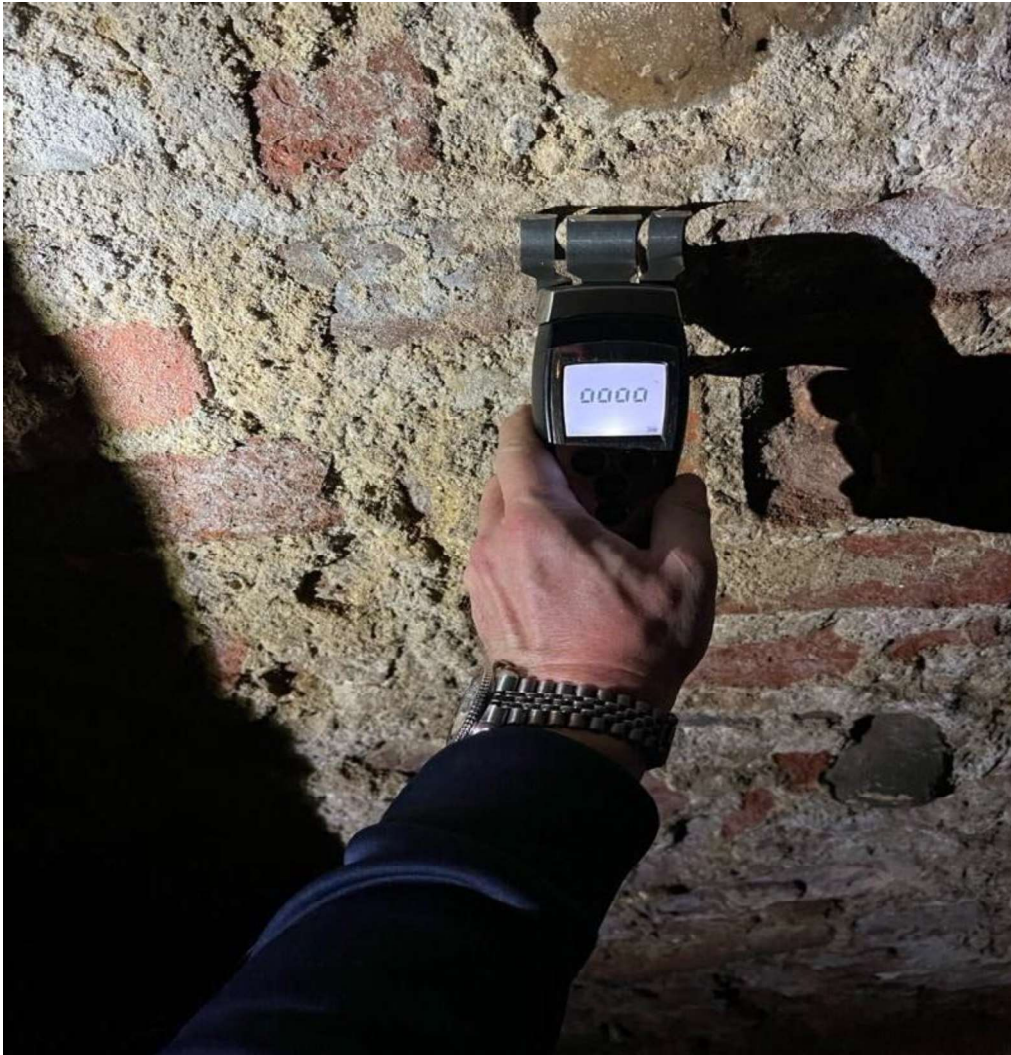
15 pav. Įdrėkio matavimai, nustatytas kritiškai aukštas drėgmės kiekis medžiagų tūryje
