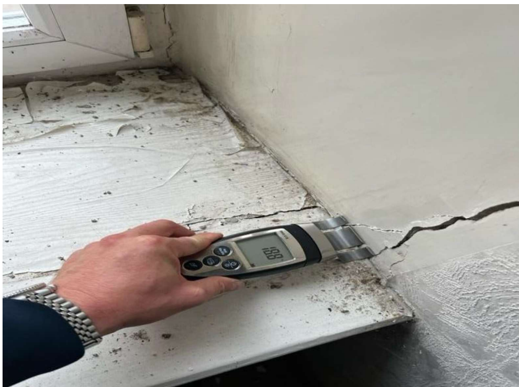
55 pav. Įdrėkio matavimai, nustatytas aukštas drėgmės kiekis medžiagų tūryje
