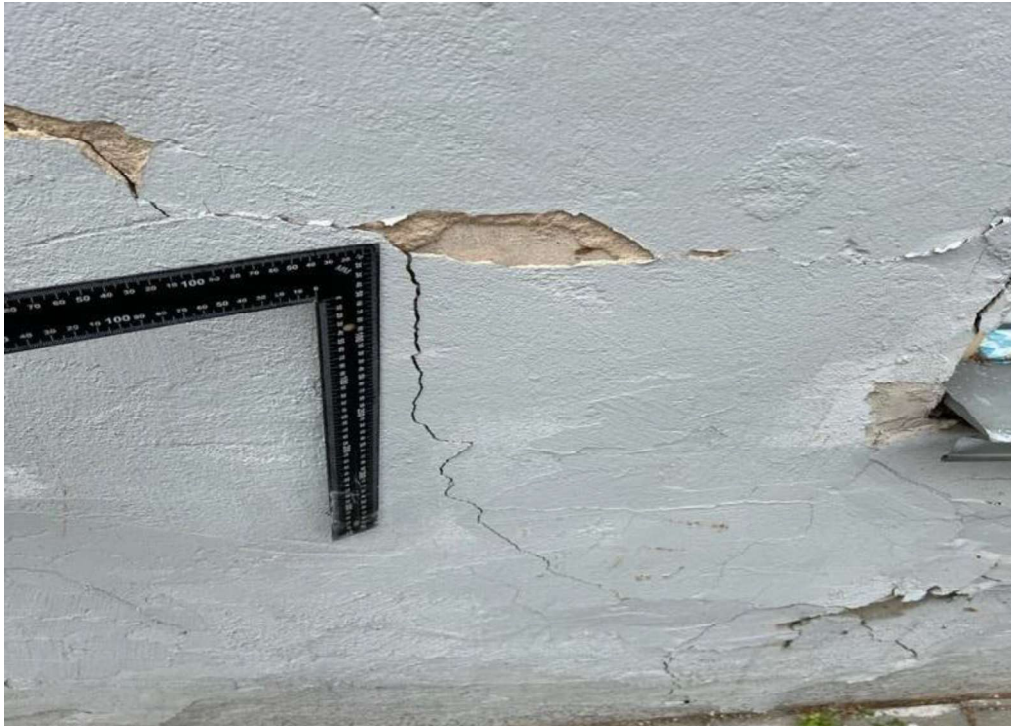
7 pav. Pastato fasado vaizdas iš kiemo pusės. Pastebėti daugybiniai fasado defektai: nutrupėjęs tinkas, trūkiai ( skilimai )
