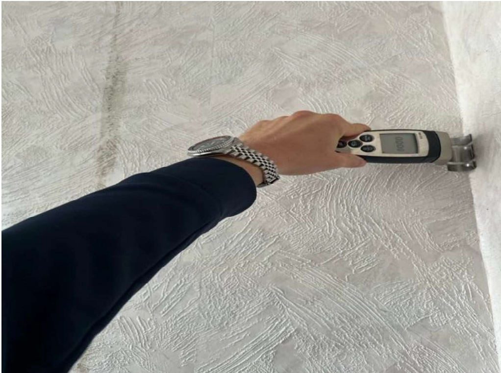
65 pav. Įdrėkio matavimai, nustatytas kritiškai aukštas drėgmės kiekis medžiagų tūryje
