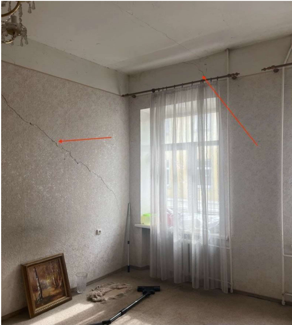
26 pav. 15-ojo buto patalpa. Įstrižieji plyšiai laikančiojoje sienoje. Plyšiai virš lango angokraščio bei lubų
