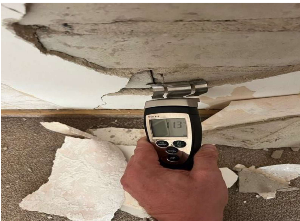
35 pav. Įdrėkio matavimai, nustatytas aukštas drėgmės kiekis medžiagų tūryje
