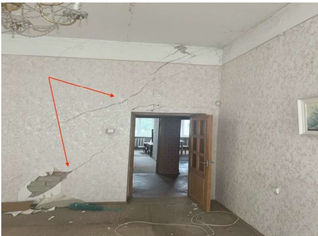
28 pav. 15-ojo buto patalpa. Įstrižieji plyšiai laikančiojoje sienoje
