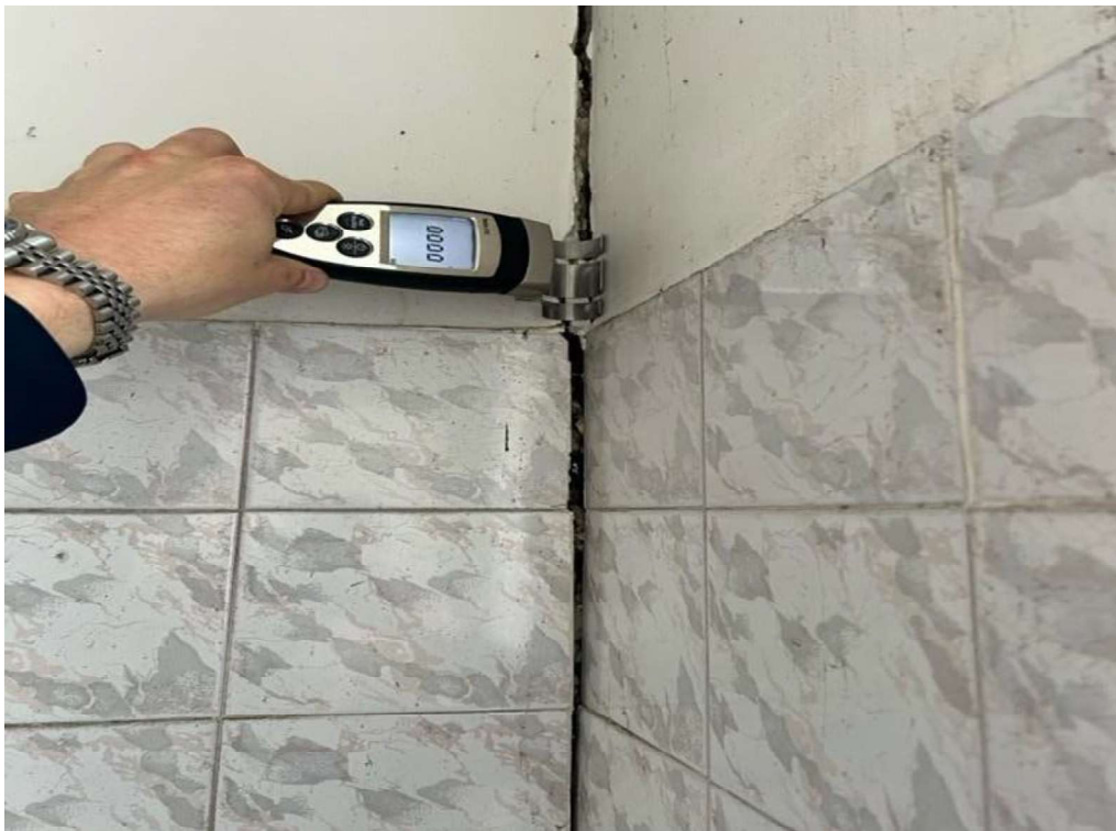
68 pav. Įdrėkio matavimai, nustatytas kritiškai aukštas drėgmės kiekis medžiagų tūryje
