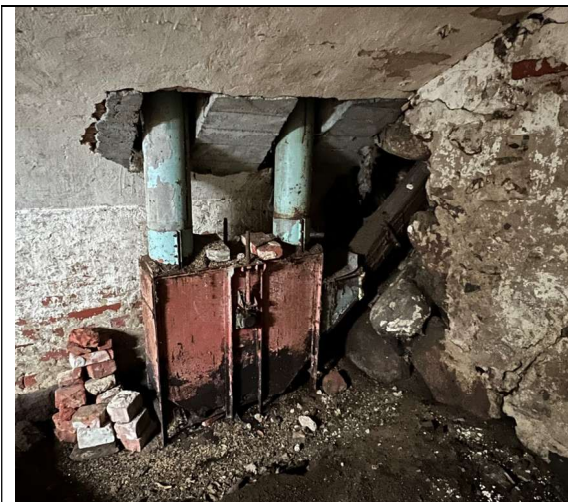
10 pav. Įrenginio statybos metu pažeistas skliautas ir pietinė laukinė akmenų mūro siena
