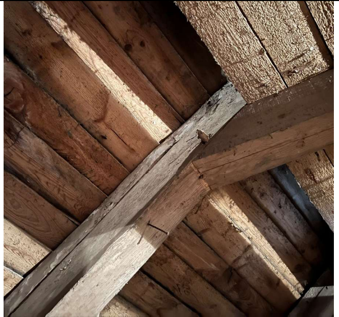
32 pav. Pirmo lygio pastogės perdangos sijų ir gegnės su antgegne jungimo mazgas
