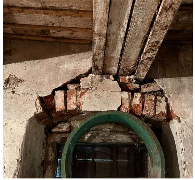
36 pav. Pirmo aukšto perdangos sijos pažeista sąrama
